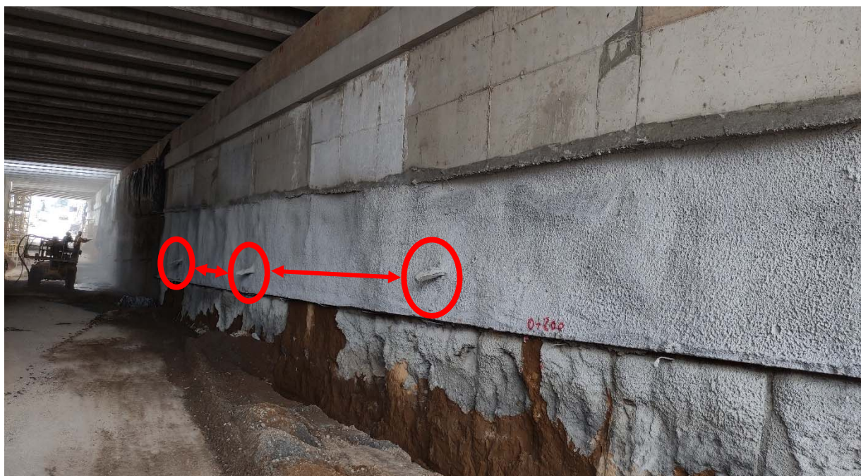
Figura 4. Separación de las salidas de agua en las paredes de la pantalla de pilotes del paso deprimido.
