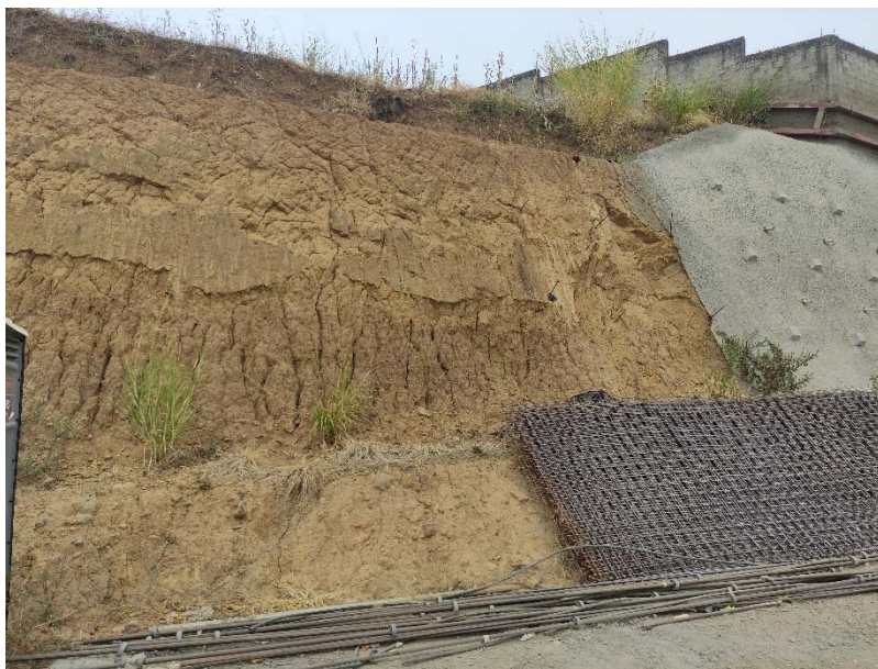
Figura 8. Condición de la cara del talud y problemas de estabilidad observados en la zona ubicada entre las pilas 54 y 55.
