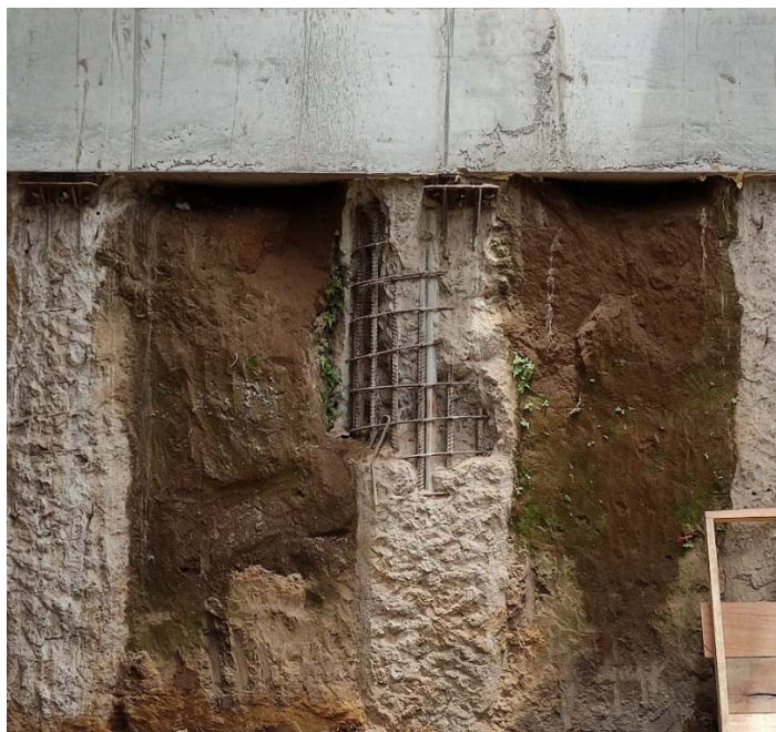
Figura 2. Pilote con problemas de acero de refuerzo expuesto debido a problemas durante el proceso constructivo de los pilotes
