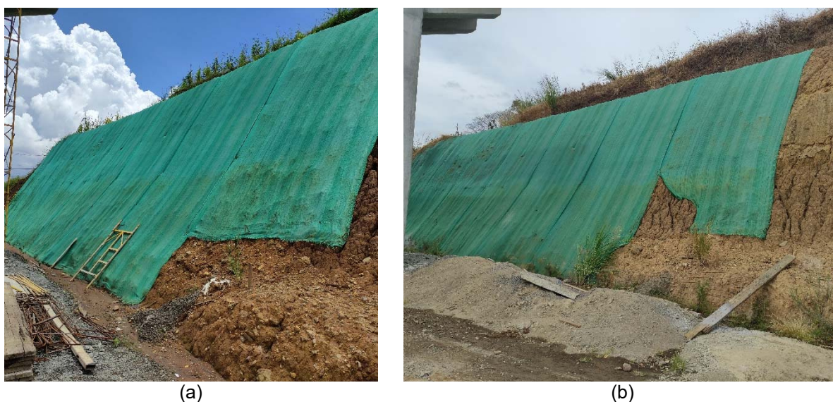
Figura 7. Condición de la colocación de geosintéticos en los taludes cercanos a la zona entre las pilas 54 y 55 en: a) setiembre del 2022 y b) marzo 2023.
