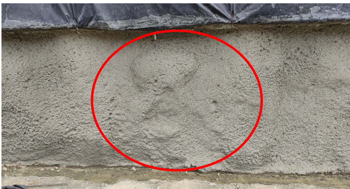
Figura 6. Agrietamientos observados en capa de concreto lanzado en el extremo de la pared norte, del sector oeste del paso deprimido
