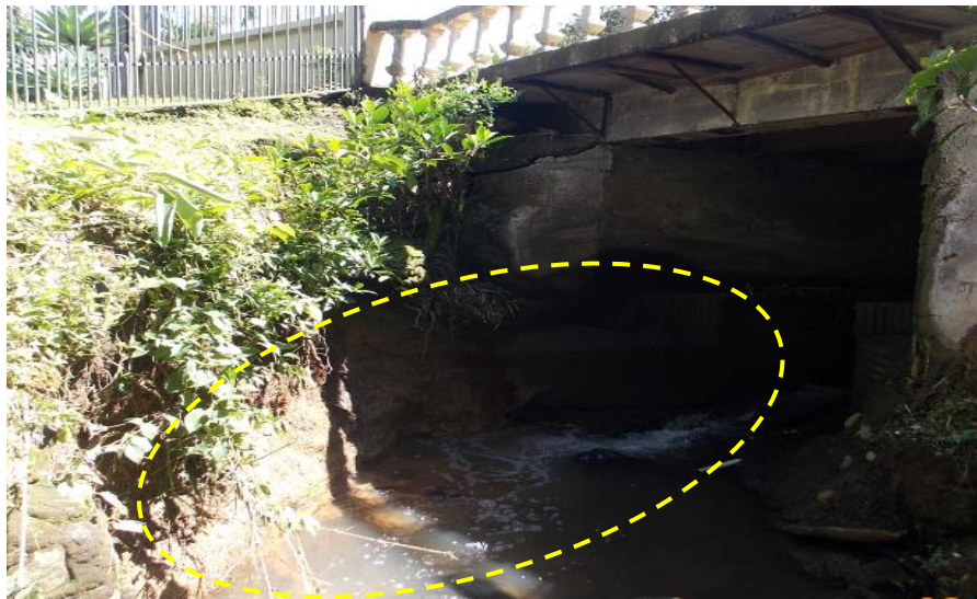
Figura 6: Socavación en la salida y afectación de masa de terreno.
