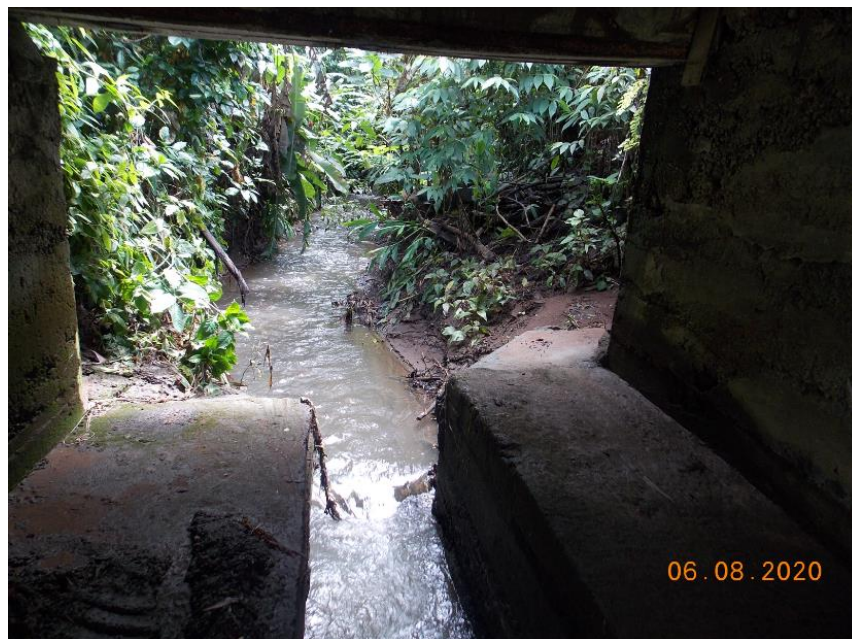
Figura 5: Contracción del cauce y reducción de capacidad hidráulica por construcción de obras de protección.
