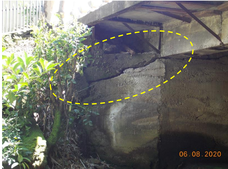
Figura 4: Fractura en aletón de margen derecha – aguas abajo en puente El Ingenio #2. Fuente: LanammeUCR
