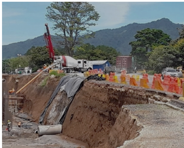
Seguridad vial: uso inadecuado de barreras
