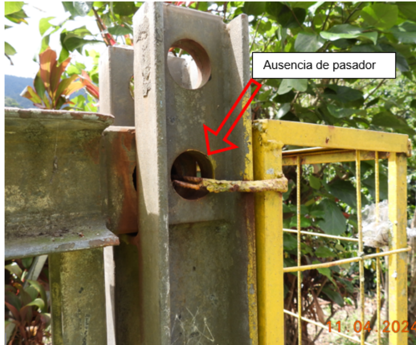
Figura 3: Ausencia de pasador en unión de cercha y columna en acceso de margen izquierda, condición riesgosa que amerita una intervención inmediata.
