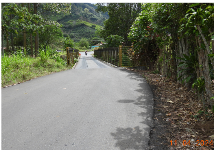
Figura 7: Ausencia de señales de reglamentación, tonelaje máximo y paso peatonal en el puente.
