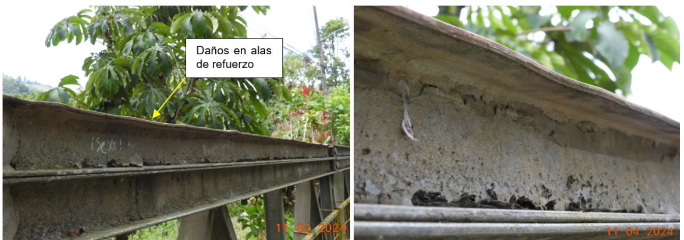
Figura 5: Refuerzos superiores de cerchas con daños por impacto y desprendimiento de la protección galvánica (ambas cerchas). Fuente: LanammeUCR
