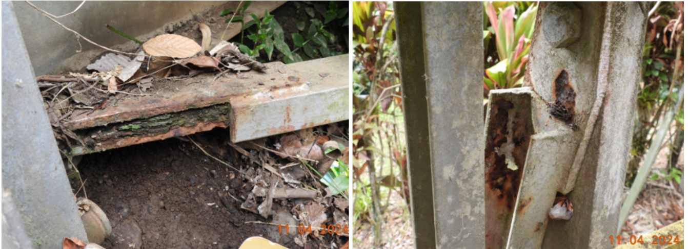
Figura 6: Daños por corrosión en elementos de la superestructura (algunos requieren ser reemplazados).
