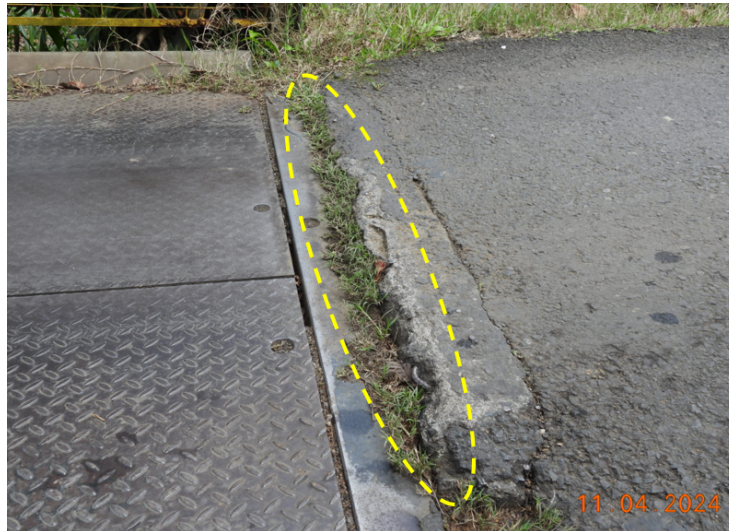
Figura 8: Acero expuesto y desnivel en ambas juntas de expansión del puente. Fuente: LanammeUCR
