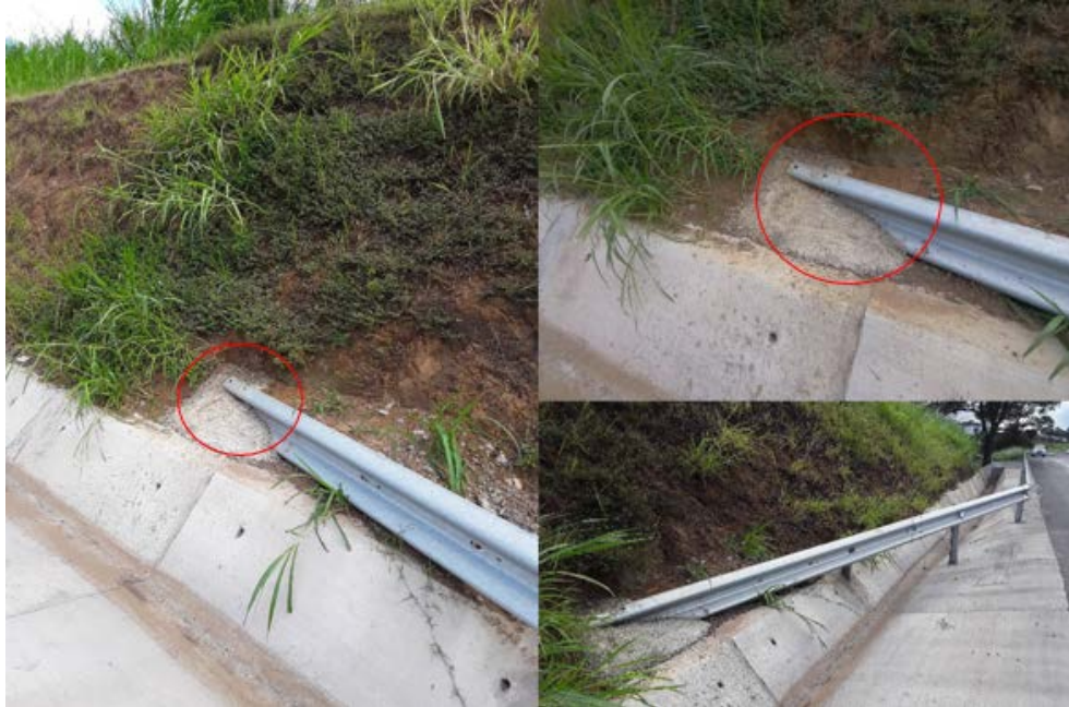
Figura 8. Uso de dispositivos no normados como elementos de canalización en las zonas de control temporal del tránsito. Ruta Nacional 32, Sección de Control 40500, Estacionamiento 4+728. Fecha: 14 de diciembre de 2023.
