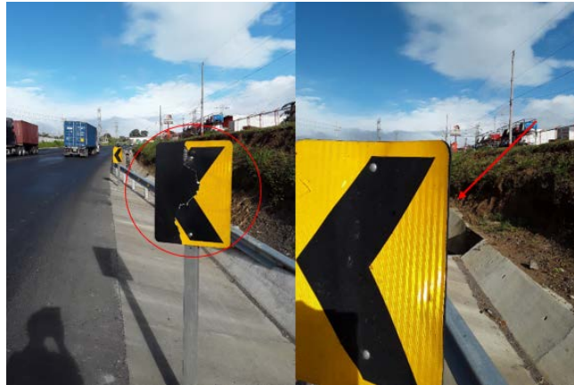
Figura 12. Señalamiento vertical en mal estado. Ruta Nacional 32, Sección de Control 40500. Fecha: 14 de diciembre de 2023.
