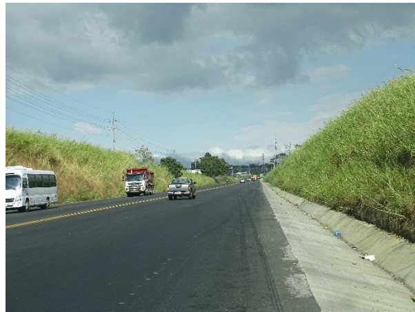
Figura 10. Condición superficial del pavimento que evidencia la falta de demarcación horizontal definitiva en el proyecto. Ruta Nacional 32, Sección de Control 40500, Estacionamiento 4+728. Fecha: 9 de enero de 2024.
