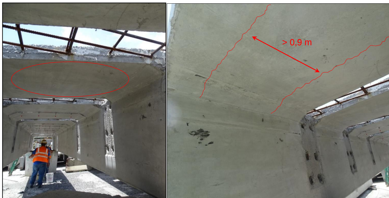
Figura 1. Agrietamiento en la dirección transversal al eje longitudinal del elemento, ubicado en la parte interna del ala superior de las 2 vigas tipo canaleta presforzadas con una separación mayor a 0,9 m.
