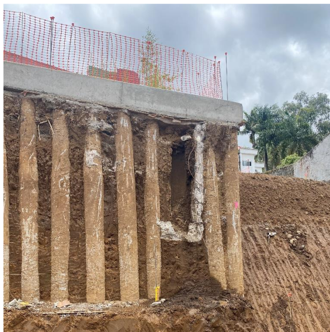
Figura 6. Sección del muro de micro-pilotes con pilote faltante.
