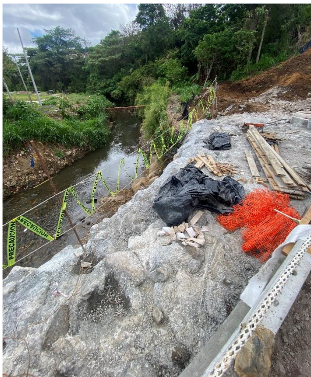
Figura 1. Parte superior del muro MSR-Eje 6-011 D
