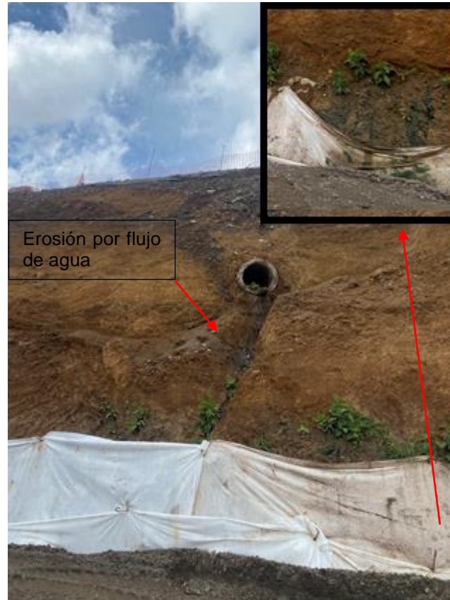
Figura 3. Talud izquierdo rampa de acceso rotonda de La bandera- Guadalupe
