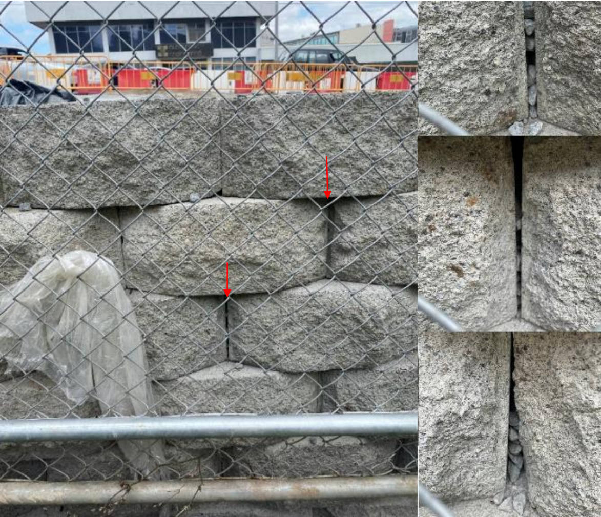
Figura 7. Espacios entre bloques de fachada del muro de suelo reforzado
