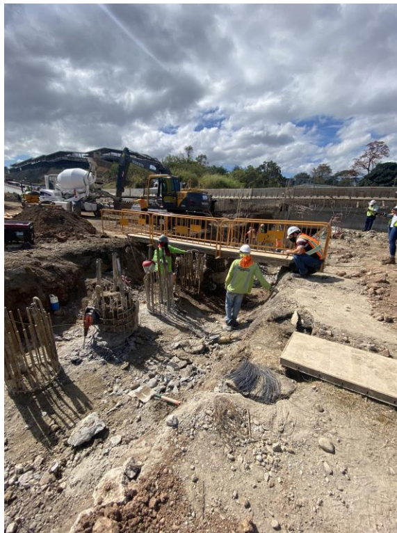
Fotografía 7. Pilotes de la cimentación del puente sobre el río Torres (Margen izquierda-aguas arriba)
