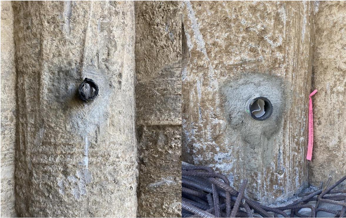
Fotografía 4. Obstrucción de los drenajes
