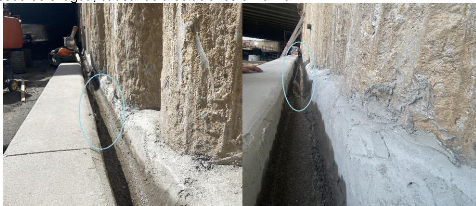
Fotografía 5. Sistema de conducción de agua drenada a desagües
