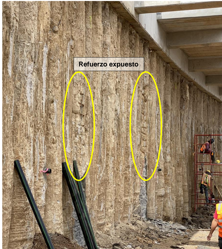
Fotografía 10. Pilotes con refuerzo expuesto del Muro Sur, sentido Calle Blancos – San Pedro
