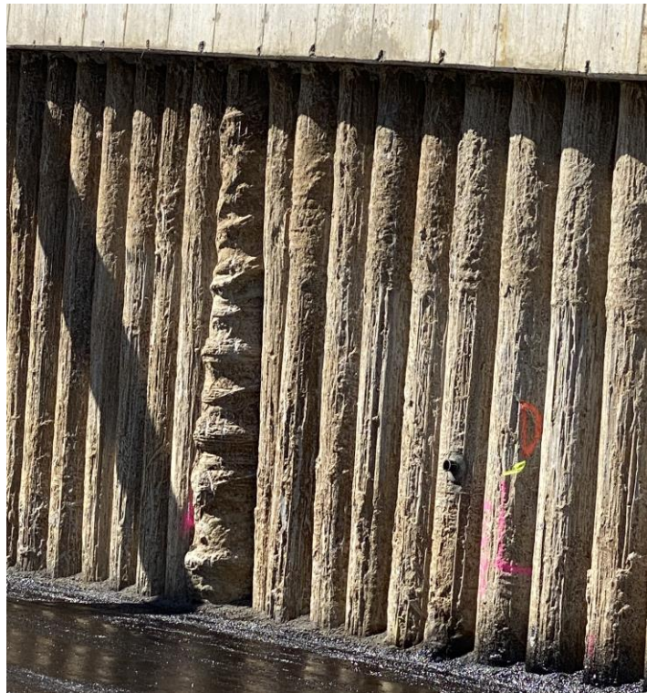
Fotografía 2. Pilote defectuoso Muro Norte, sentido Calle Blancos – San Pedro
