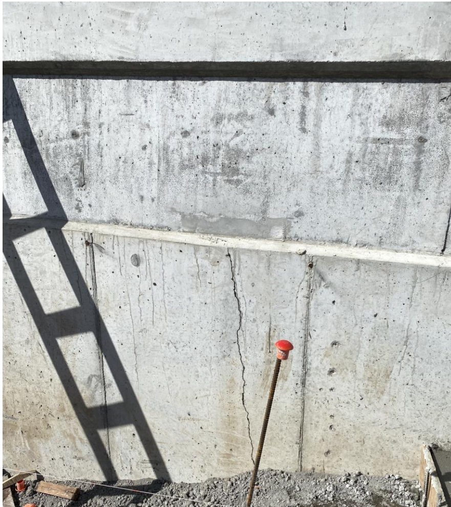
Fotografía 14. Grieta en Muro Norte de concreto reforzado, sentido Calle Blancos – San Pedro
