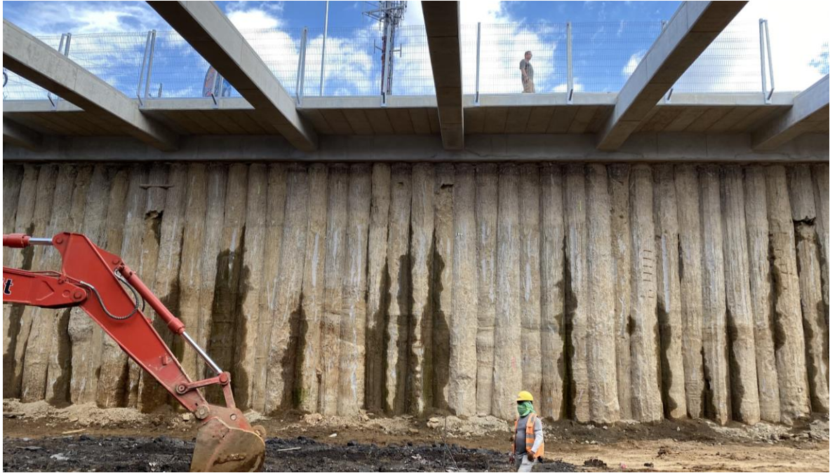
Fotografía 12. Infiltración de agua en el Muro Sur, sentido San Pedro – Calle Blancos
