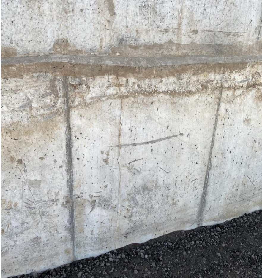
Fotografía 15. Grieta en Muro Norte de concreto reforzado, sentido San Pedro – Calle Blancos
