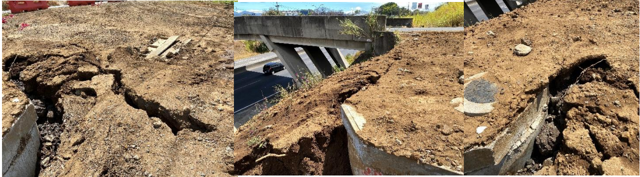
Figura 12 Formación de grietas en la corona de un sector del talud cercano al puente sobre Ruta 1
