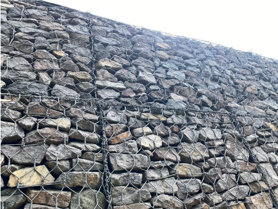
Figura 6 Rocas en las canastas del muro de gaviones sin presencia evidente de tamaños menores
