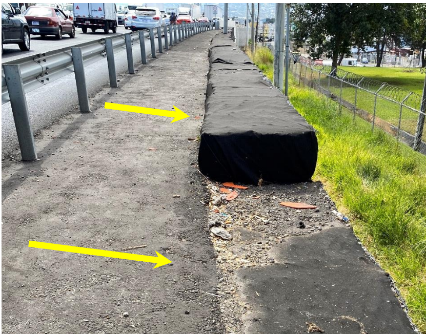
Figura 7 Corona del muro de gaviones sin protección de agua de escorrentía superficial
