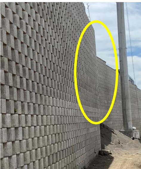
Figura 10 Posible zona de falta de verticalidad del muro Keystone
