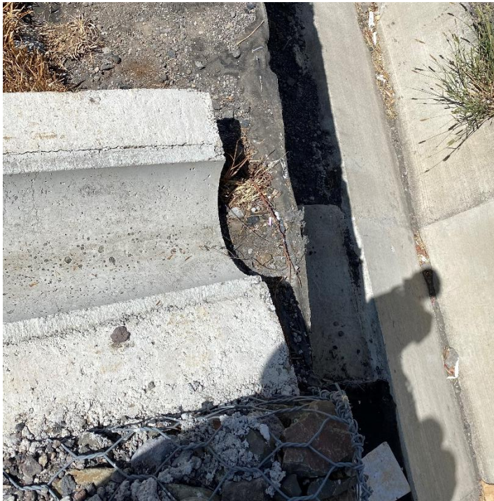
Figura 14 Cuneta en un punto del muro de gaviones
