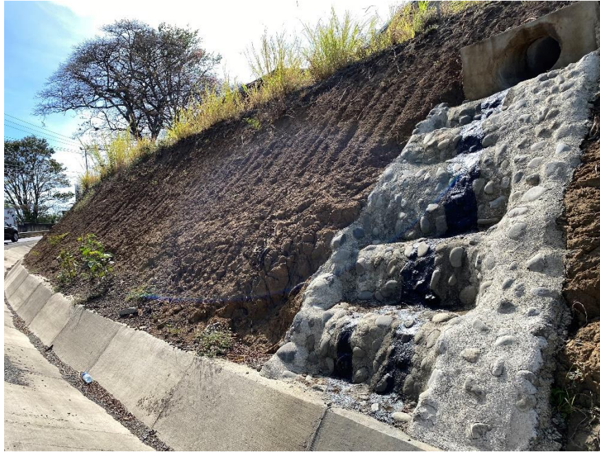
Figura 2 Depósito de suelo erosionado en las cunetas y formación de surcos, producto de la escorrentía superficial en el talud derecho (sentido ruta 1 – ruta 106)
