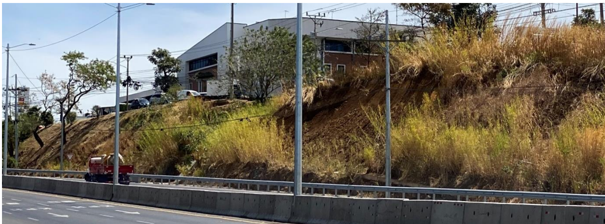
Figura 16 Talud cercano a las terminales y aduanas Santamaría
