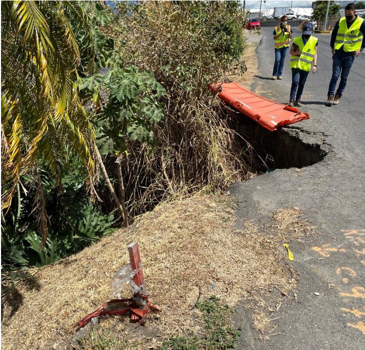
Figura 18 Falla local del talud en zona de aduanas Santamaría
