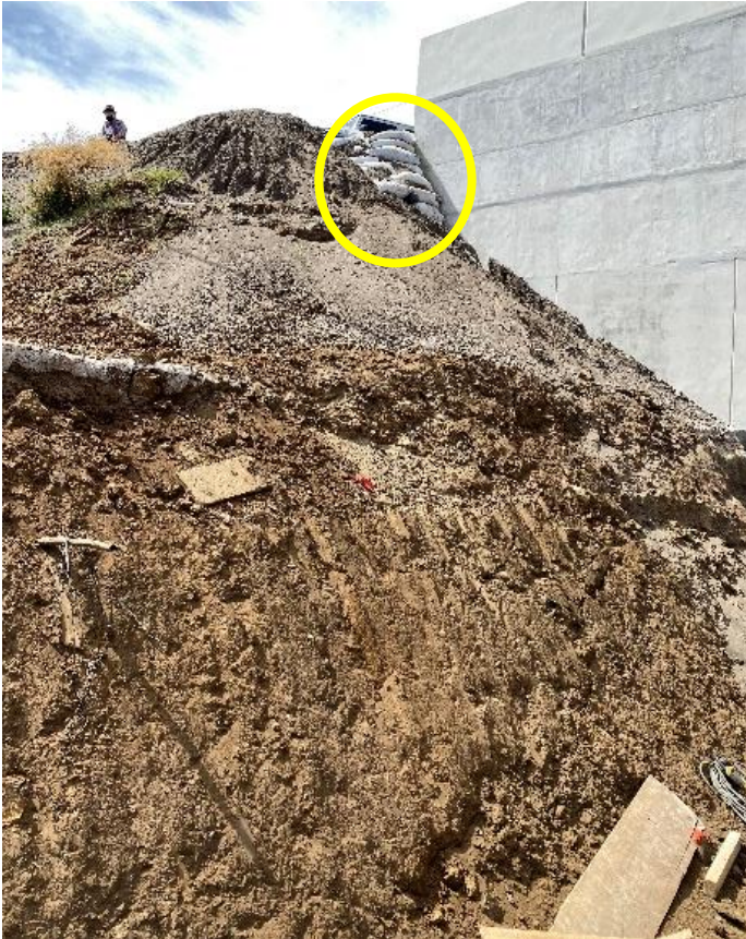
Figura 9 Talud de gran altura carente de obras de protección
