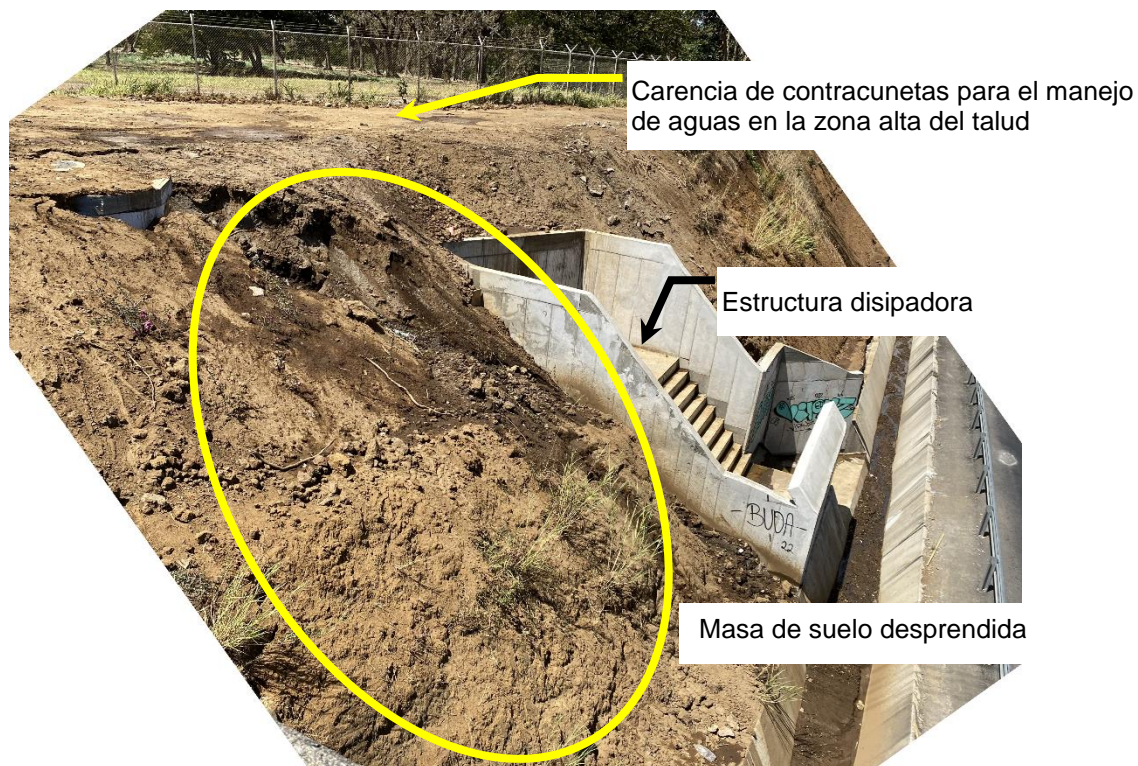
Figura 11 Condición del talud próximo al estacionamiento 13+950
