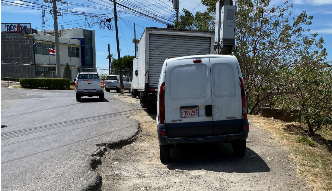
Figura 20 Vehículos estacionados en la corona del talud derecho (sentido San Ramón – San José) en las cercanías de las terminales y aduanas Santamaría
