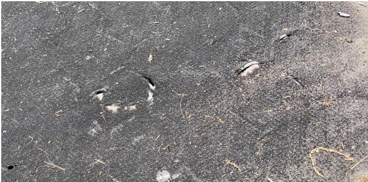
Figura 8 Daño en geosintético colocado en la corona del muro de gaviones
