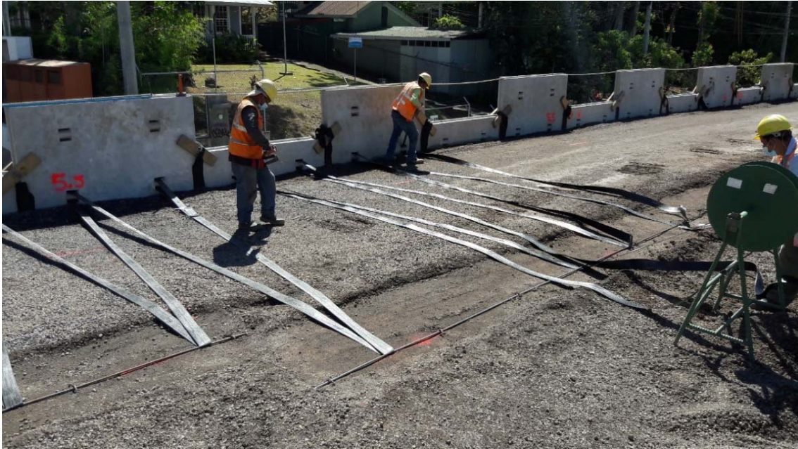
Fotografía 12. Colocación de bandas de refuerzo del material de relleno – visita 2 de febrero
