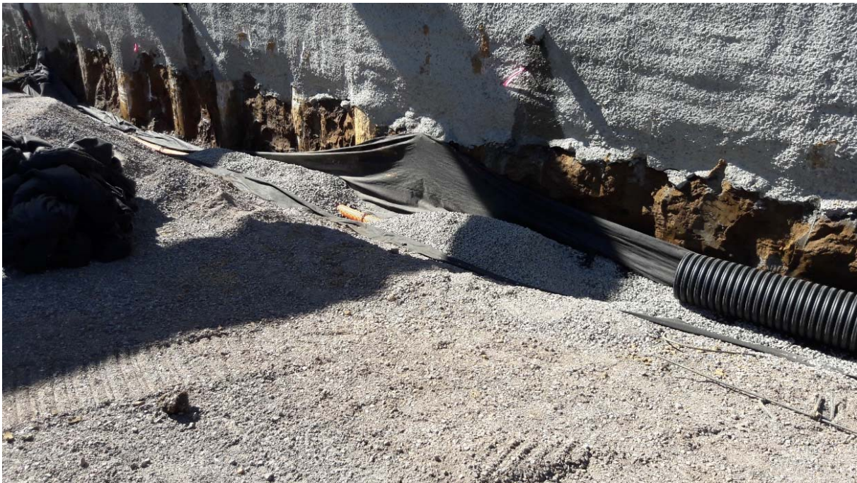
Fotografía 8. Colocación de tubos de drenaje en la base de los muros laterales de la excavación
