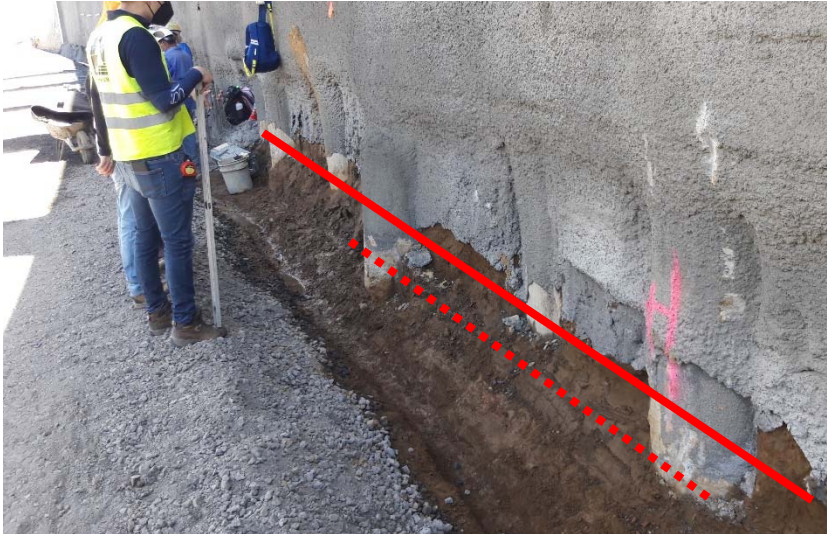
(a) Pilotes con alineamientos inadecuado
