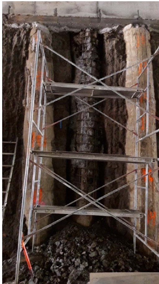
Fotografía 7. Defectos constructivos en uno de los pilotes localizado en la parte central de la excavación, lado izquierdo (sentido La Bandera -Guadalupe)
