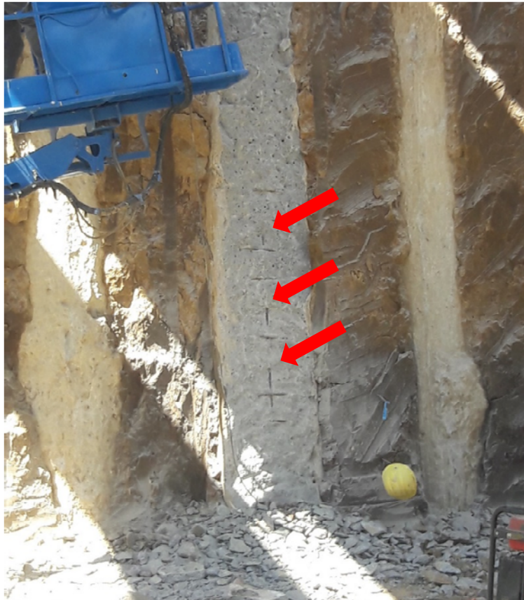
Fotografía 4. Estructura de la armadura de refuerzo del pilote expuesta o sin el recubrimiento mínimo requerido debido al proceso de eliminación de concreto
