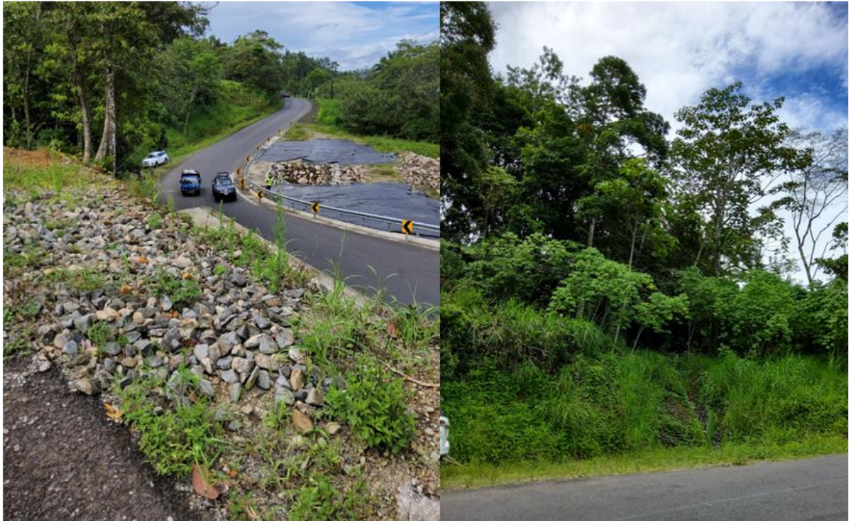
Figura 6 Condición del talud superior en el sitio "Puente Casa"
