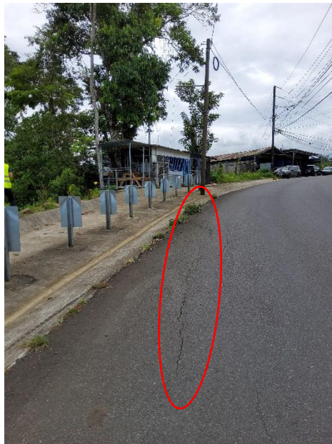
Figura 1 Grieta localizada en la superficie de pavimento
