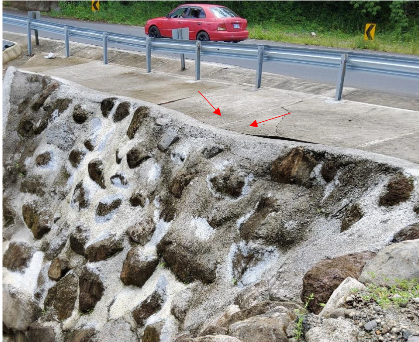
Figura 7 Evidencia de movimiento en el talud inferior de la vía en el sitio "Puente Casa"
