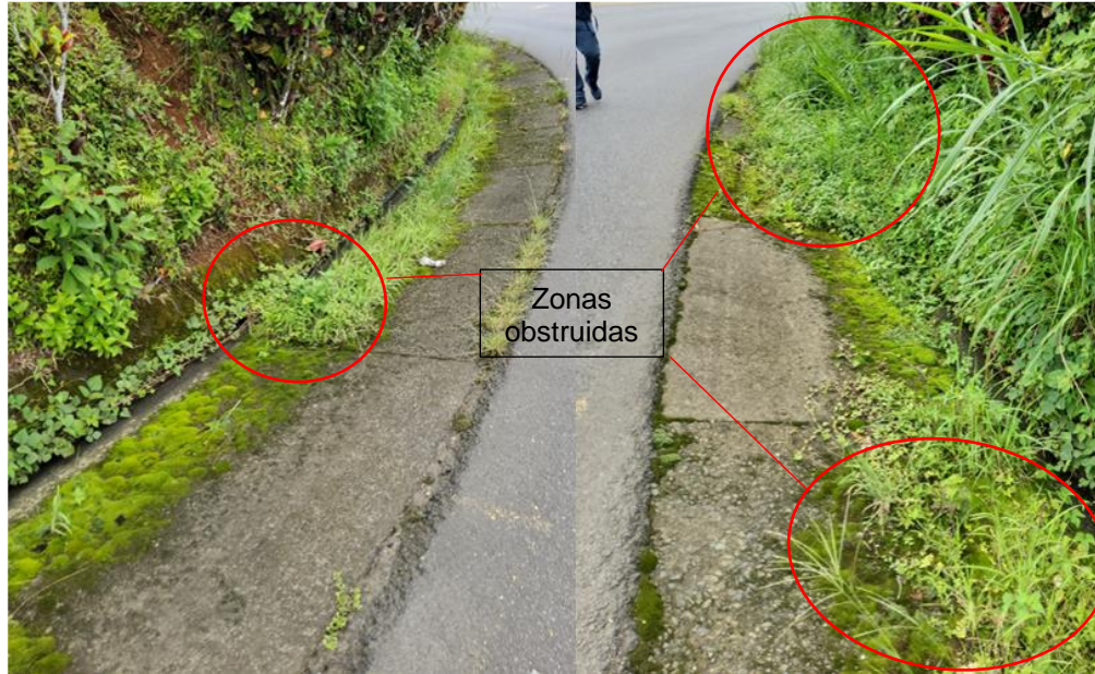
Figura 5 Estado actual de las cunetas en el sitio conocido como “Vuelta de Cocos”
