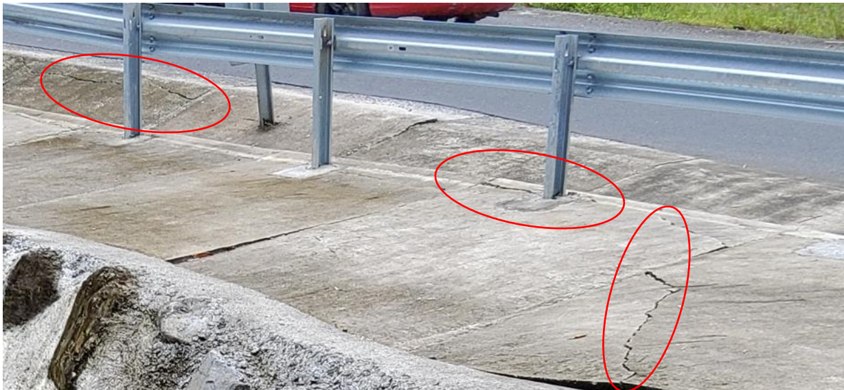
Figura 8 Agrietamiento de la corona y cuneta correspondientes al talud inferior de la vía en el sitio "Puente Casa"
