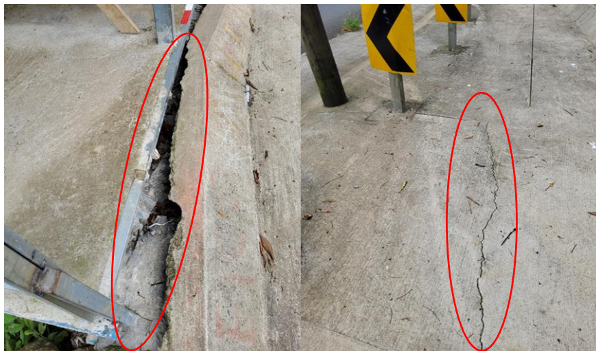
Figura 4 Agrietamientos en los alrededores de la vivienda
