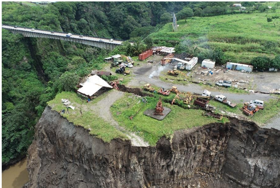
Figura 3 Afectación de bloques inestables a la cimentación del puente
