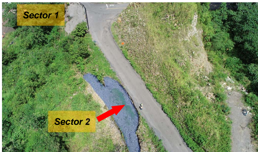
Figura 7. Condición actual del talud derecho de la carretera (sentido ruta nacional 27 – Turrubares), aproximadamente a 50 m al sur del puente sobre la ruta nacional 27, en la ruta nacional 707
