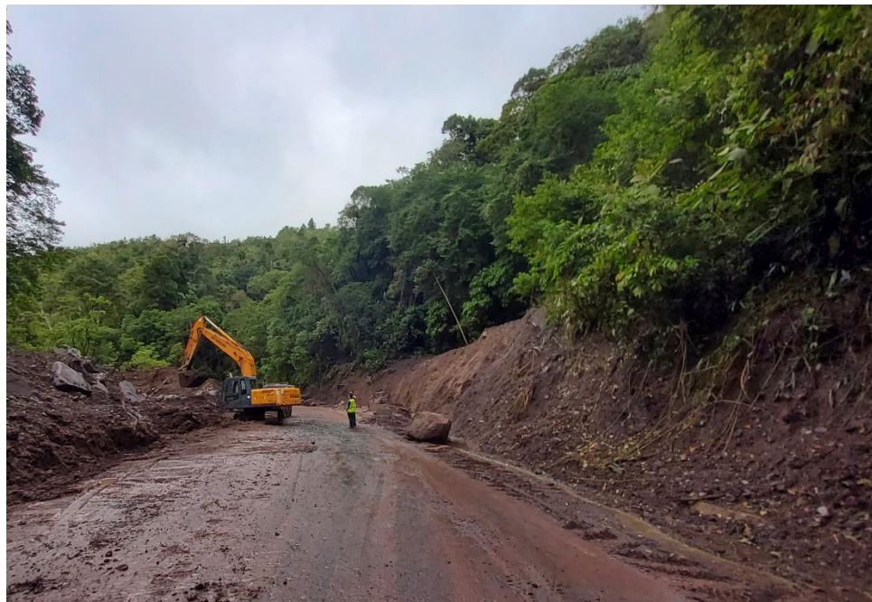
Figura 4 Talud en el km 118+000 de la Ruta Nacional 2
