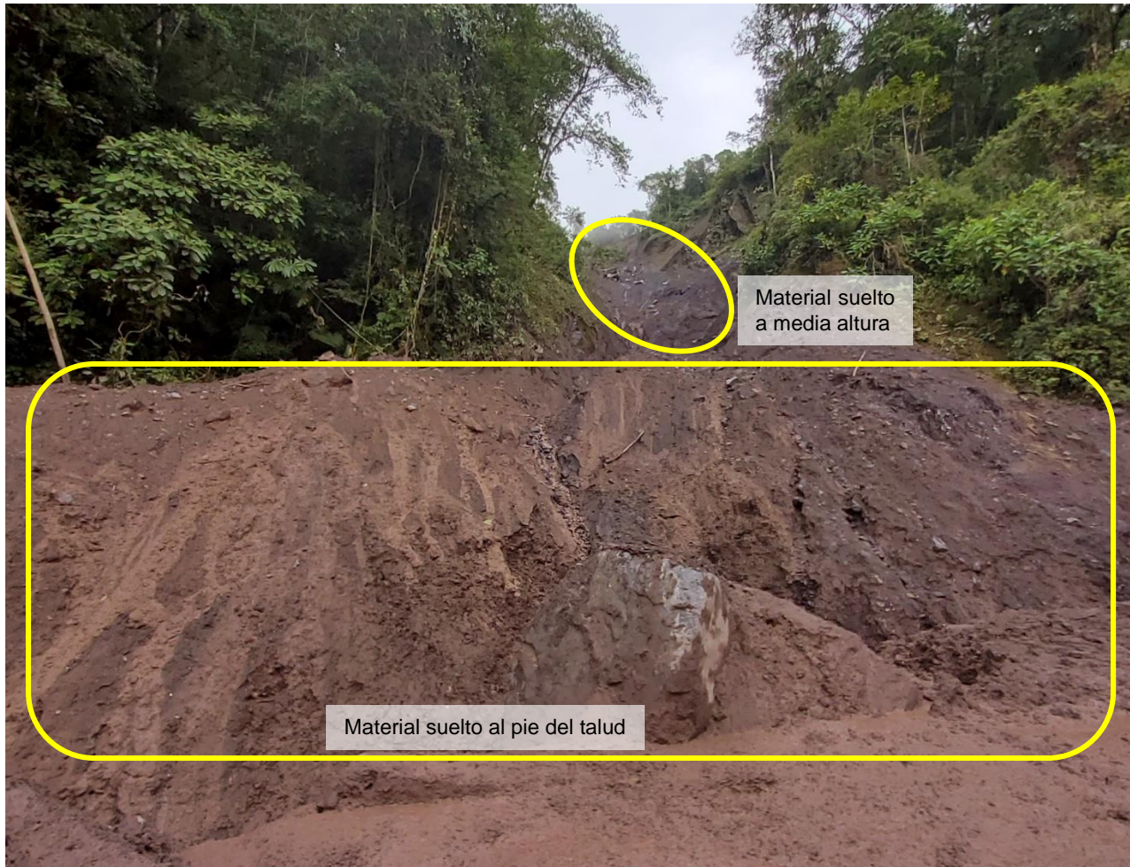
Figura 2 Condición remanente del talud del km 118+000 el día 18 de octubre 2022
