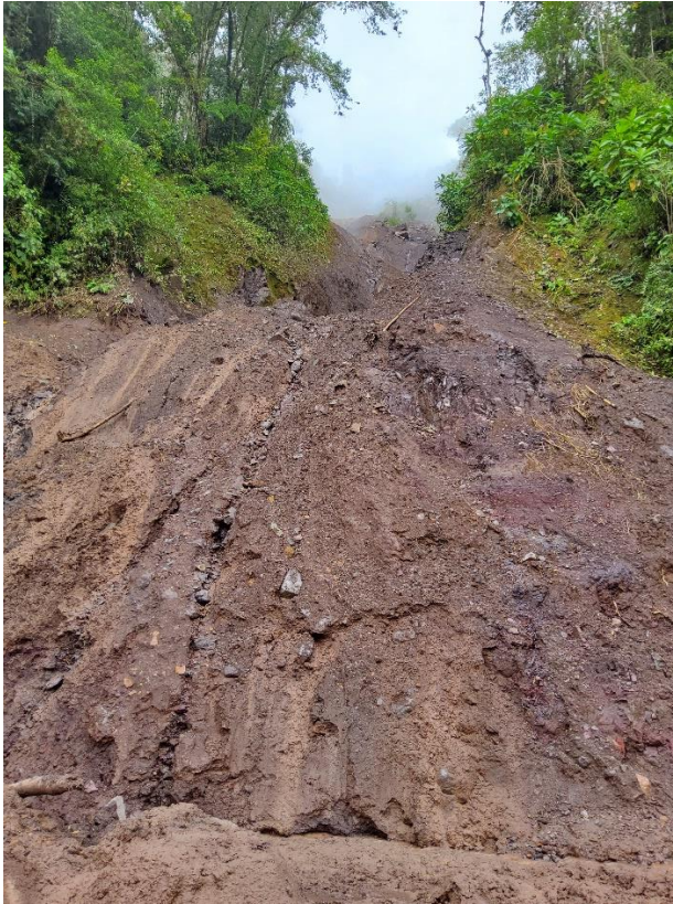
Figura 25 Deslizamiento 18* (*): tratado en el apartado II
