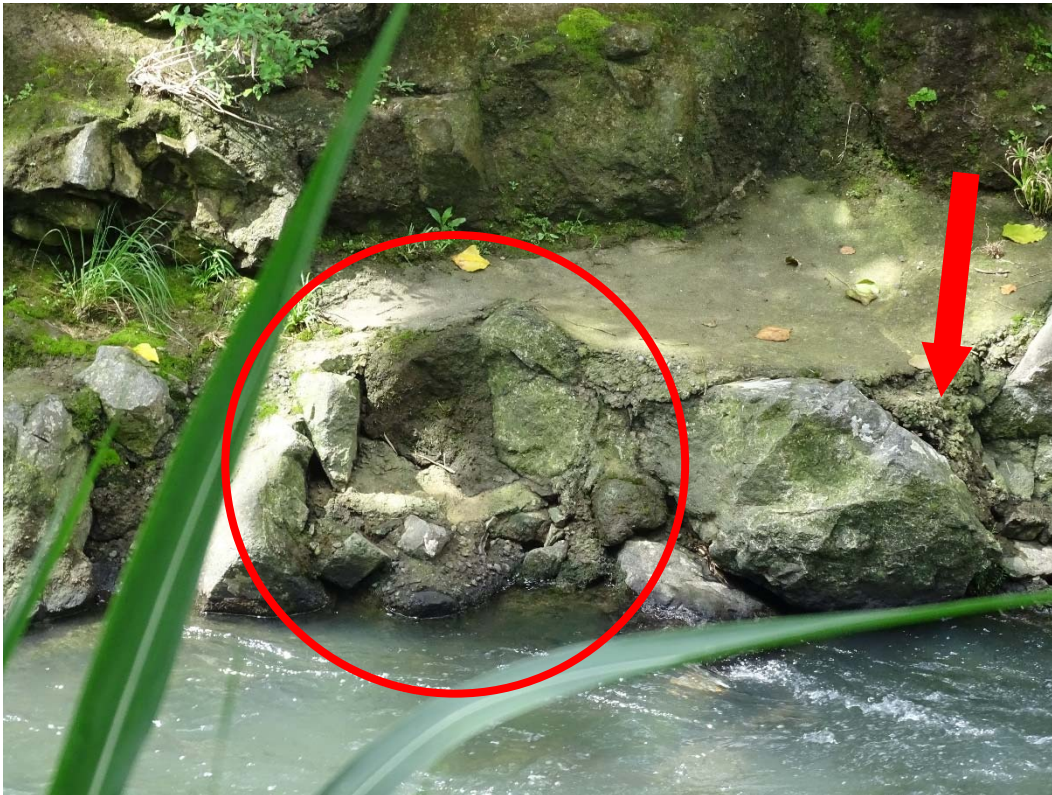
Figura 3. Evidencias de pérdidas de rocas en la base de la escollera
