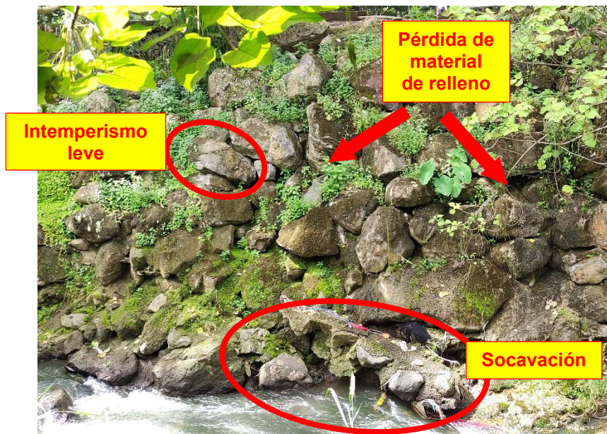
Figura 2. Deterioros observados en las obras de reforzamiento
