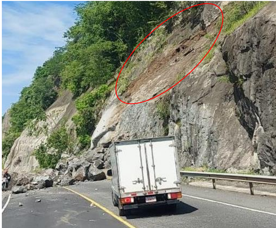
Figura 1 Deslizamiento del talud de roca del km 46+200 de la RN-27 Fuente: (El Observador, 2022)
