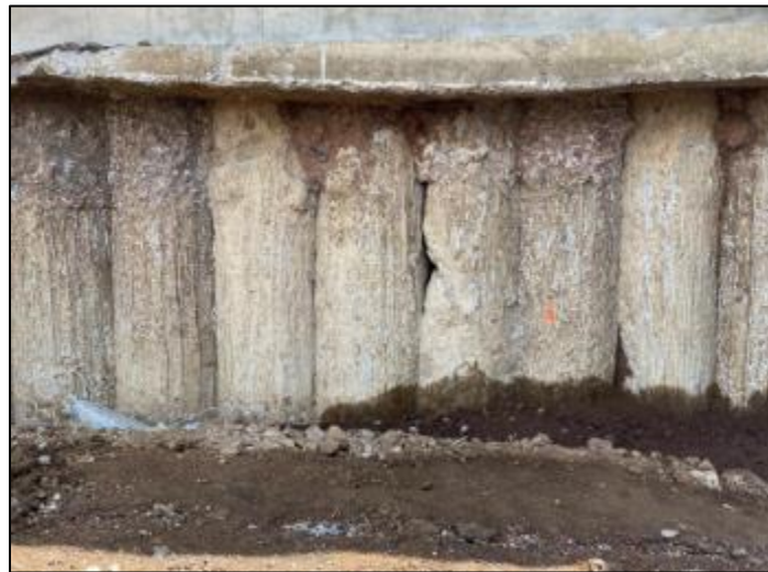
Figura 7. Defecto constructivo en pilote secante.
