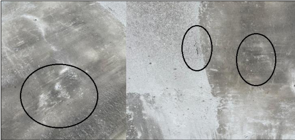
Figura 5. Grietas en la losa de concreto de la rotonda Guadalupe
