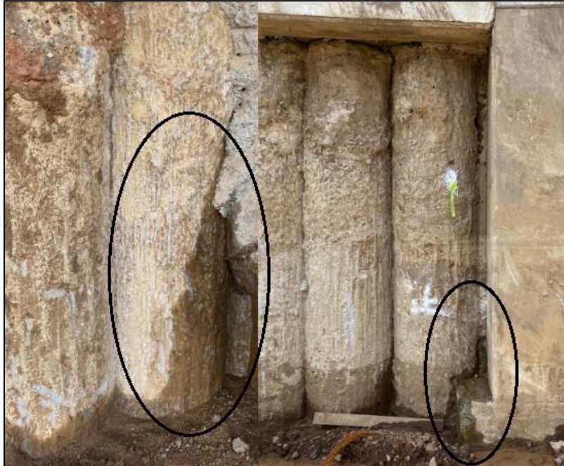
Figura 8. Filtración de agua en la junta de la pantalla de pilotes y el muro de concreto reforzado
