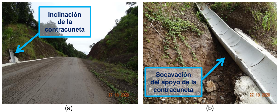
Figura 2. Talud izquierdo y derecho, estación 19+080
