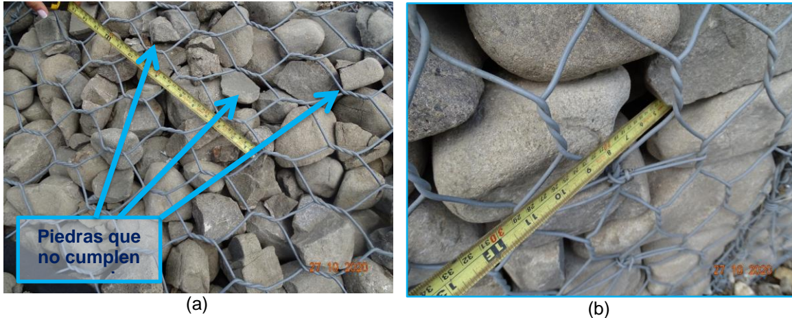
Figura 20. Problemas constructivos en el muro de gaviones, estacionamiento 3+950, lado izquierdo: (a) incumplimiento de tamaño de las piedras, (b) vacío en el relleno del muro
