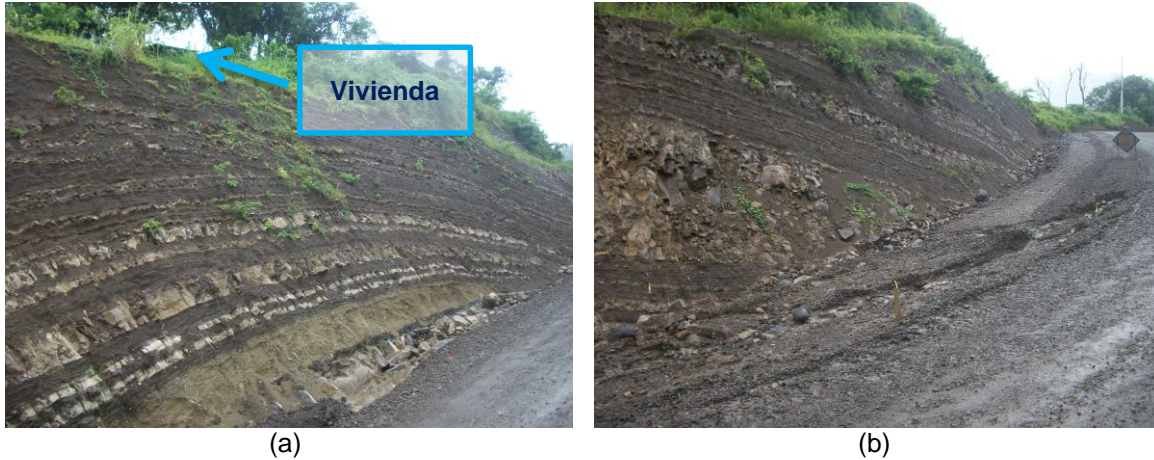
Figura 12. Talud izquierdo, estación 2+815
