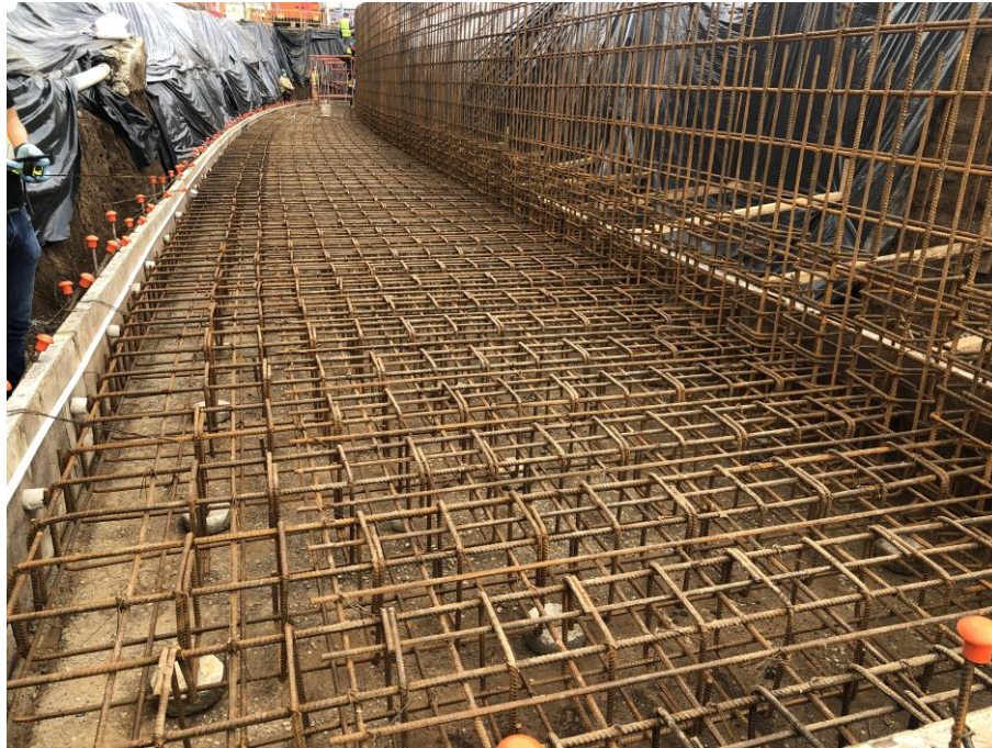
Fotografía 5. Colocación del acero de refuerzo de cimentación de muro de concreto reforzado
