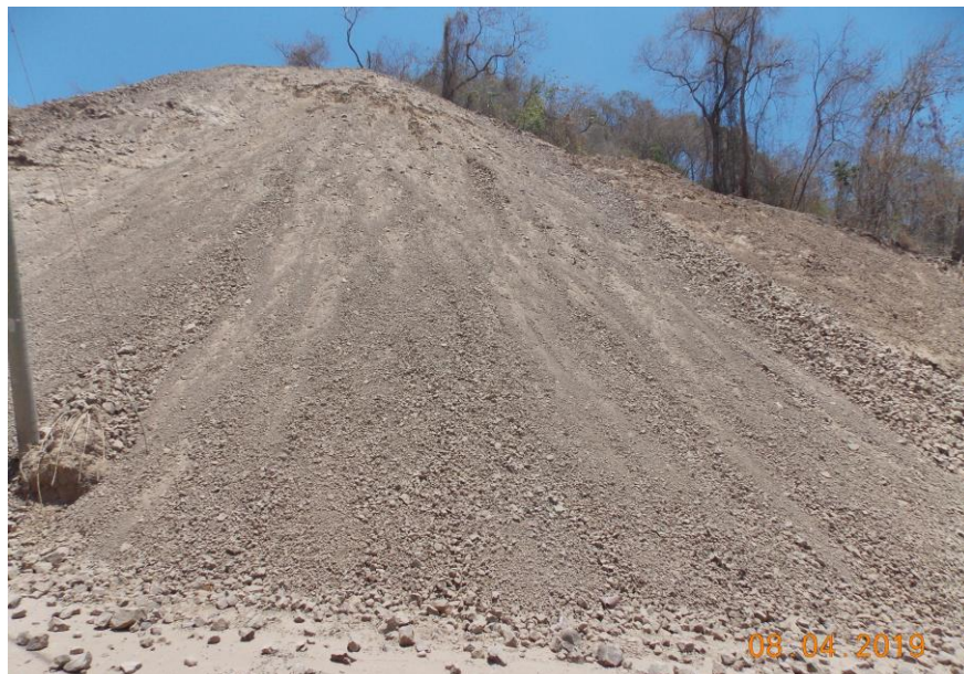
Figura 8. Talud izquierdo, estación 19+097
