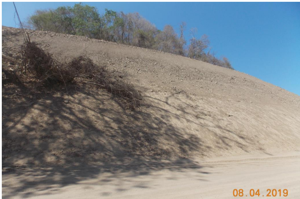
Figura 9. Talud izquierdo, estación 4+585
