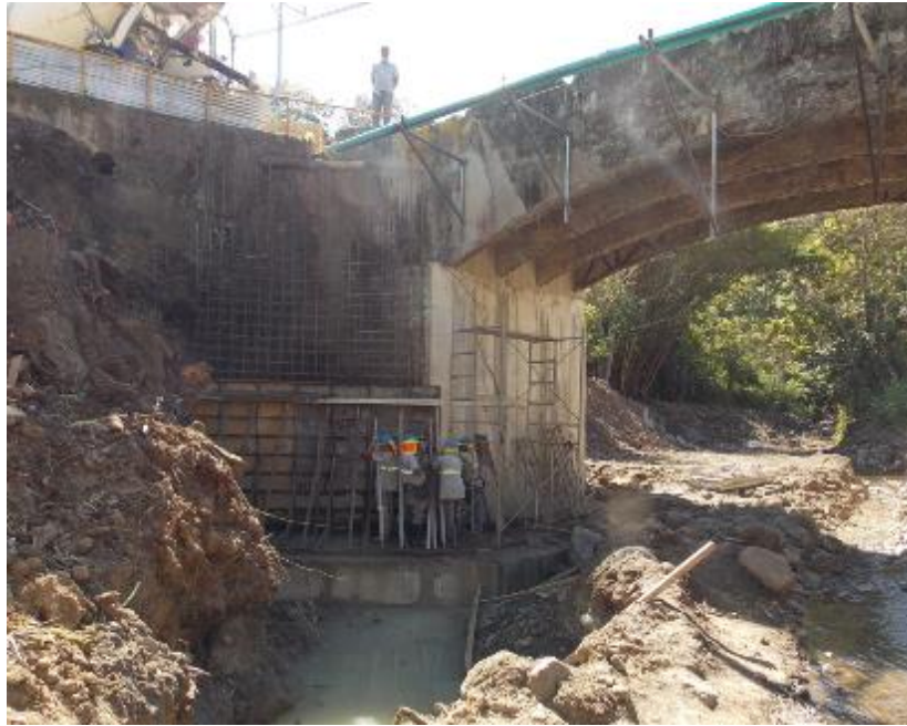
Figura 5: Colada del aletón aguas abajo del muro de refuerzo externo en bastión de margen derecha Rio Cacao. Fuente: LanammeUCR
