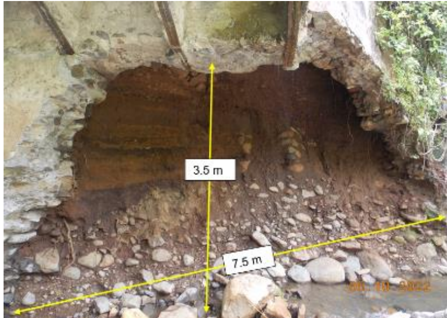
Figura 3: Colapso parcial del cuerpo del bastión según visita del 5 de octubre de 2022 Fuente: LanammeUCR
