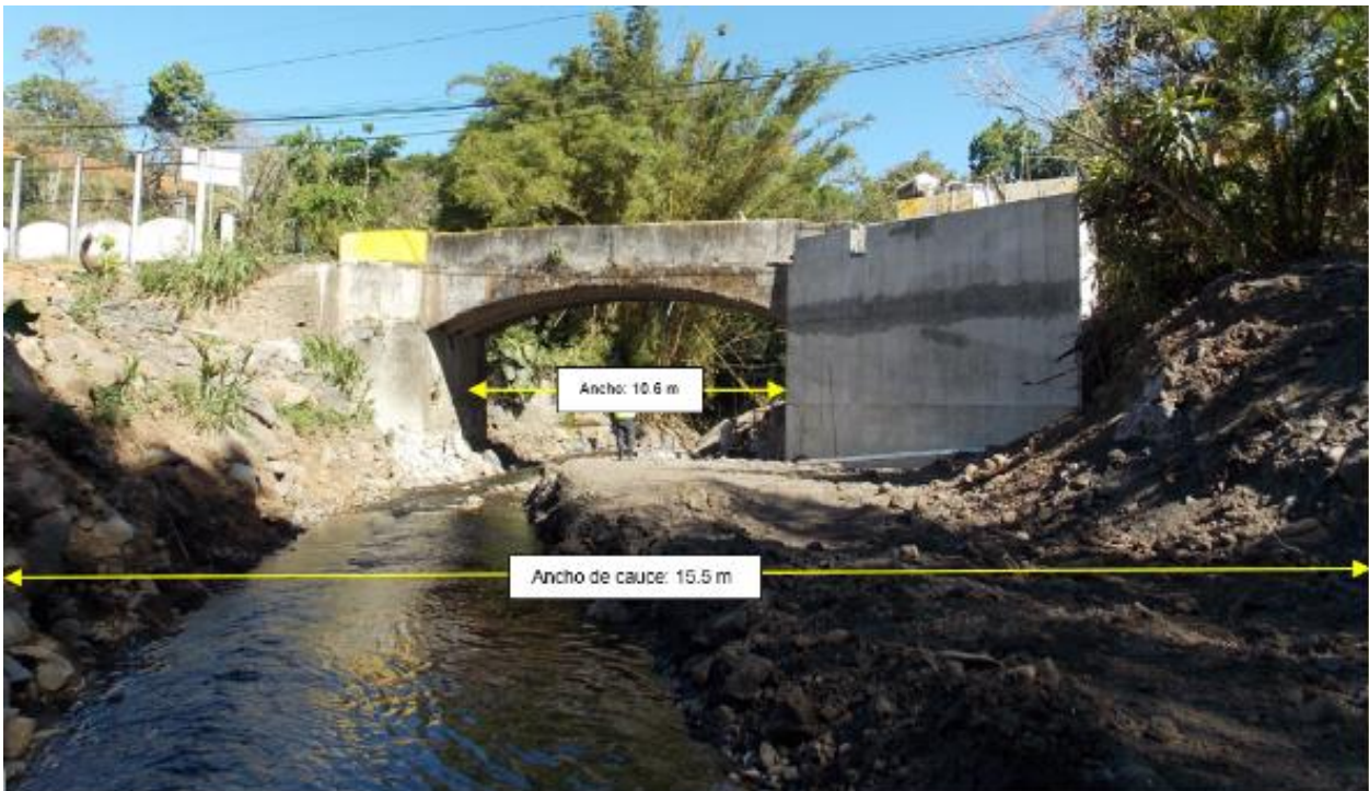
Figura 8: Contracción del cauce del Río Cacao al paso por el puente. Fuente: LanammeUCR
