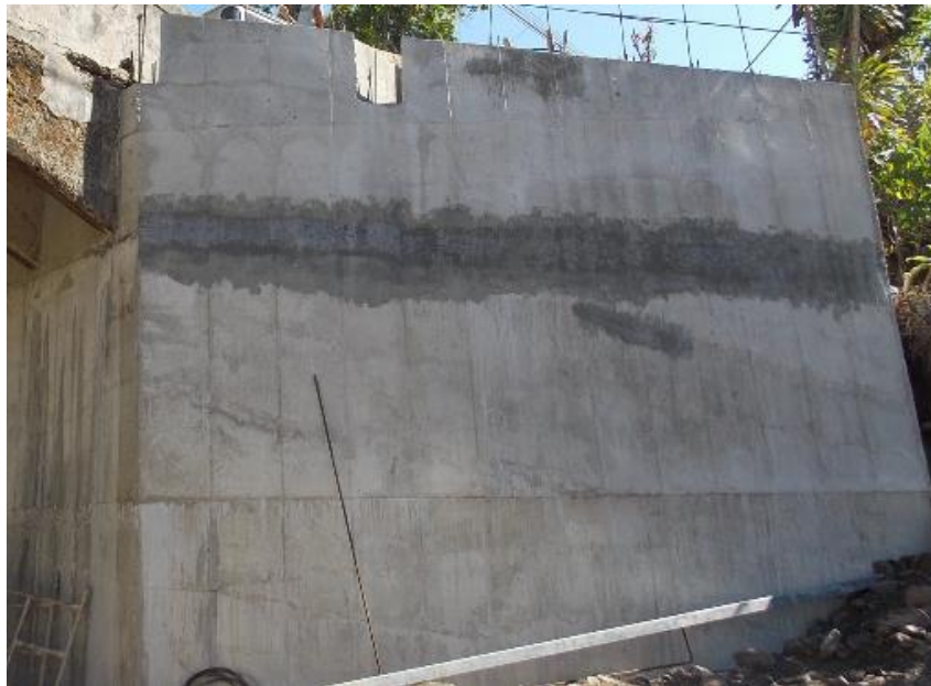
Figura 6: Reparaciones superficiales en zona de unión entre etapa 2 y 3 del aletón aguas arriba. Fuente: LanammeUCR
