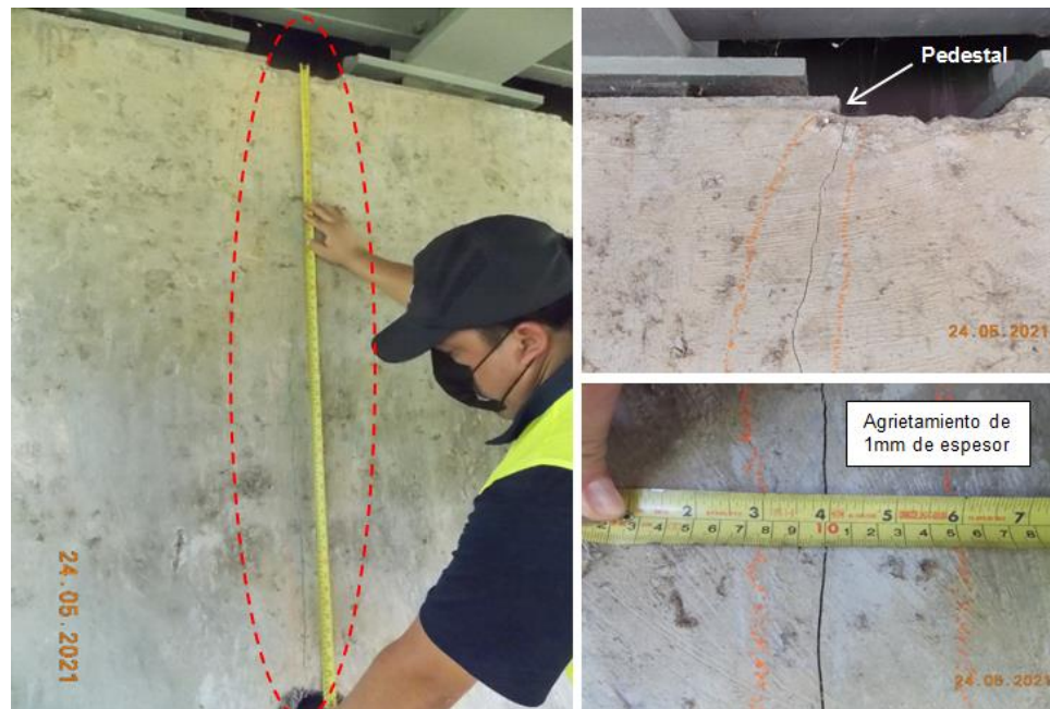
Figura 9: Agrietamientos verticales con dirección vertical identificados en bastión de margen derecha.
