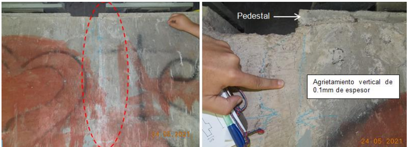
Figura 8: Agrietamientos verticales leves con dirección vertical identificados en bastión de margen izquierda.
