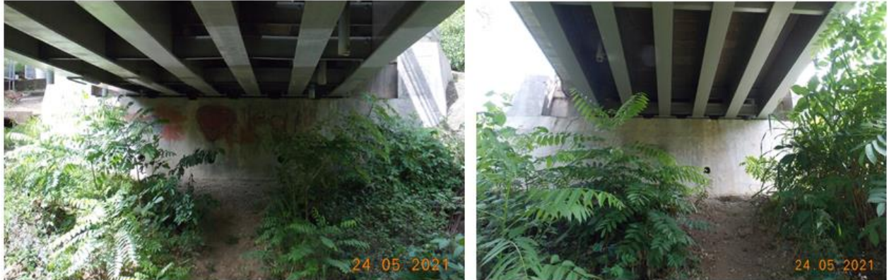
Figura 6: Vista general de bastiones de puente sobre Quebrada Pozón en Cebadilla de Orotina.
