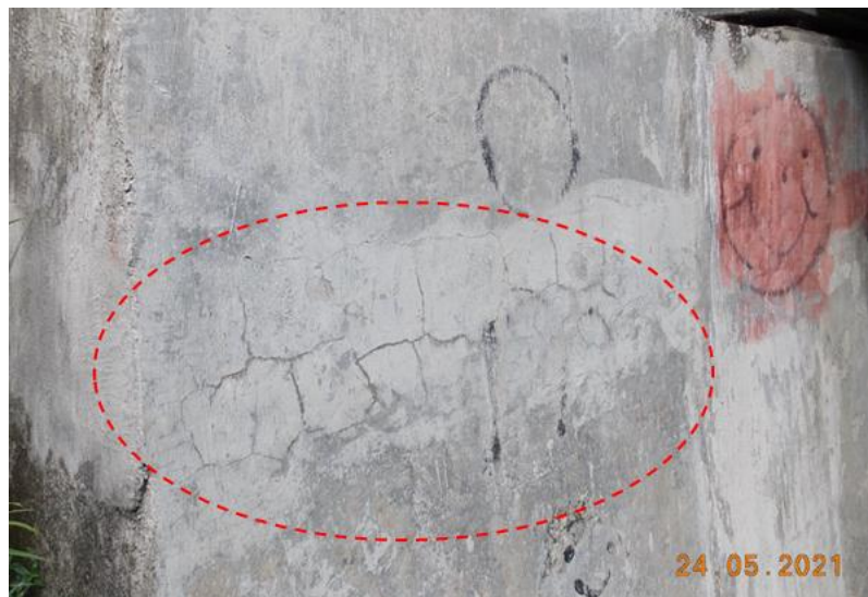
Figura 7: Agrietamientos en red y desprendimientos leves en repello de bastiones.
