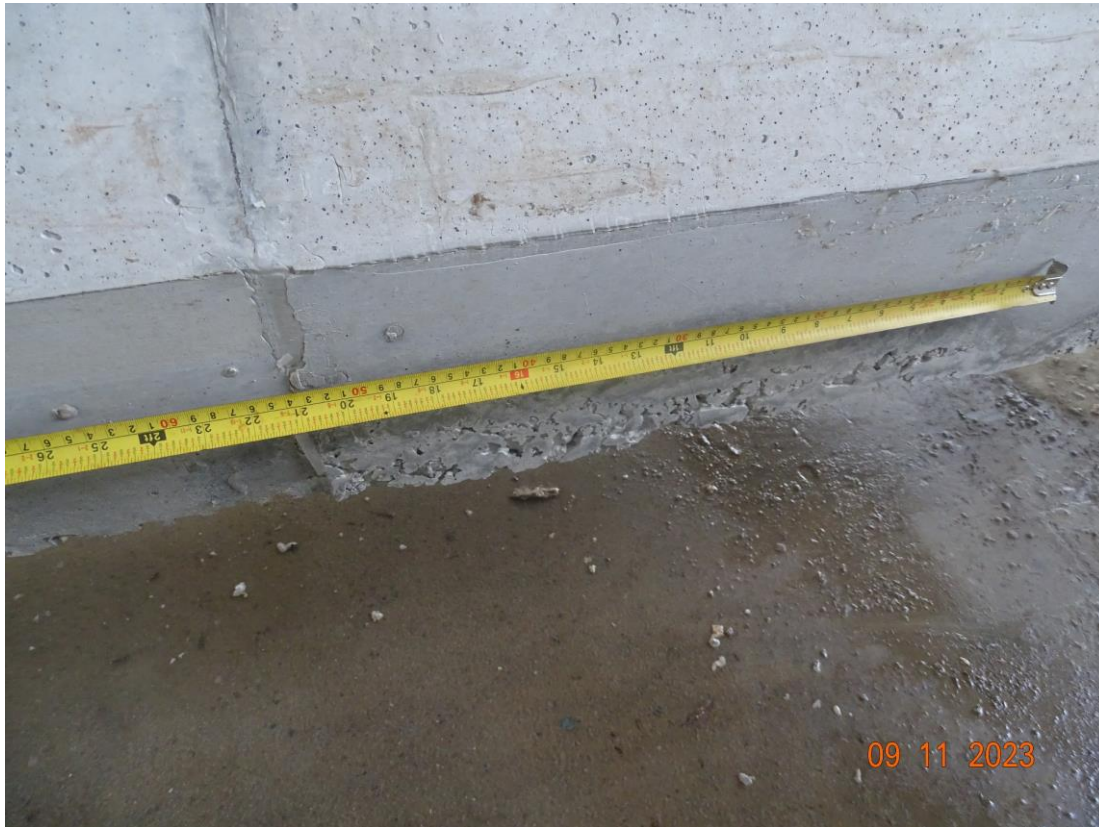
Figura 19. Nidos de piedra ubicados en el ala inferior de la viga n.º 4 de la superestructura n.º 5
