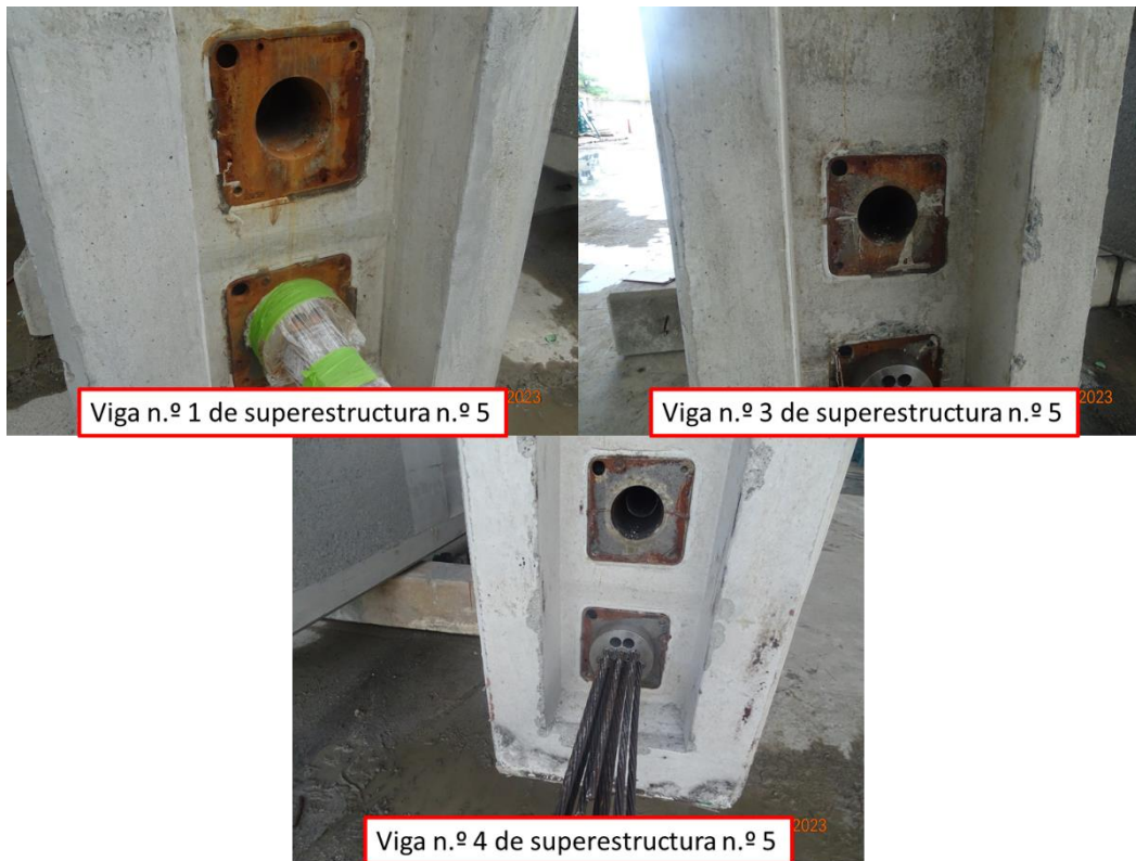
Figura 17. Óxido en los dispositivos de anclaje del acero de presfuerzo en las vigas de la superestructura n.º 5
