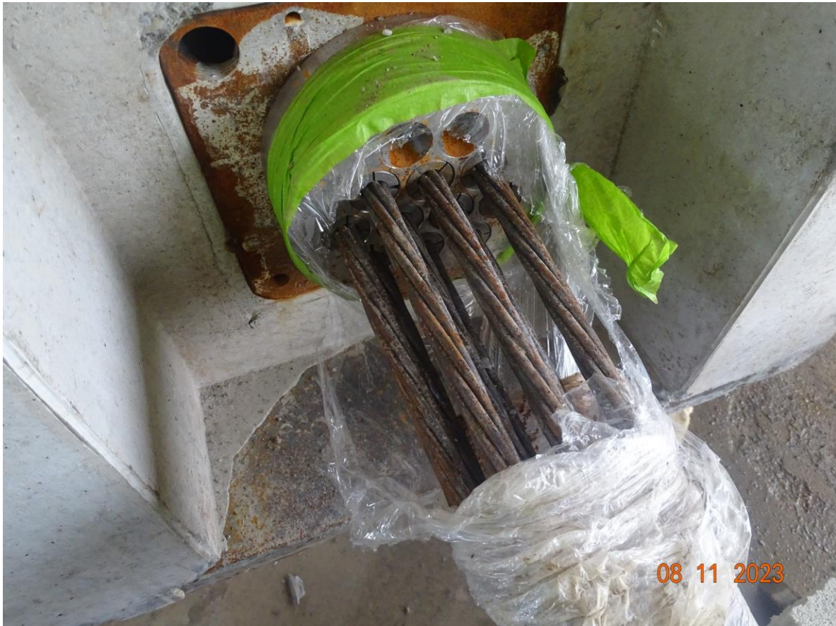
Figura 18. Acero de presfuerzo oxidado en el ducto inferior de la viga n.º 1 de la superestructura n.º 5
