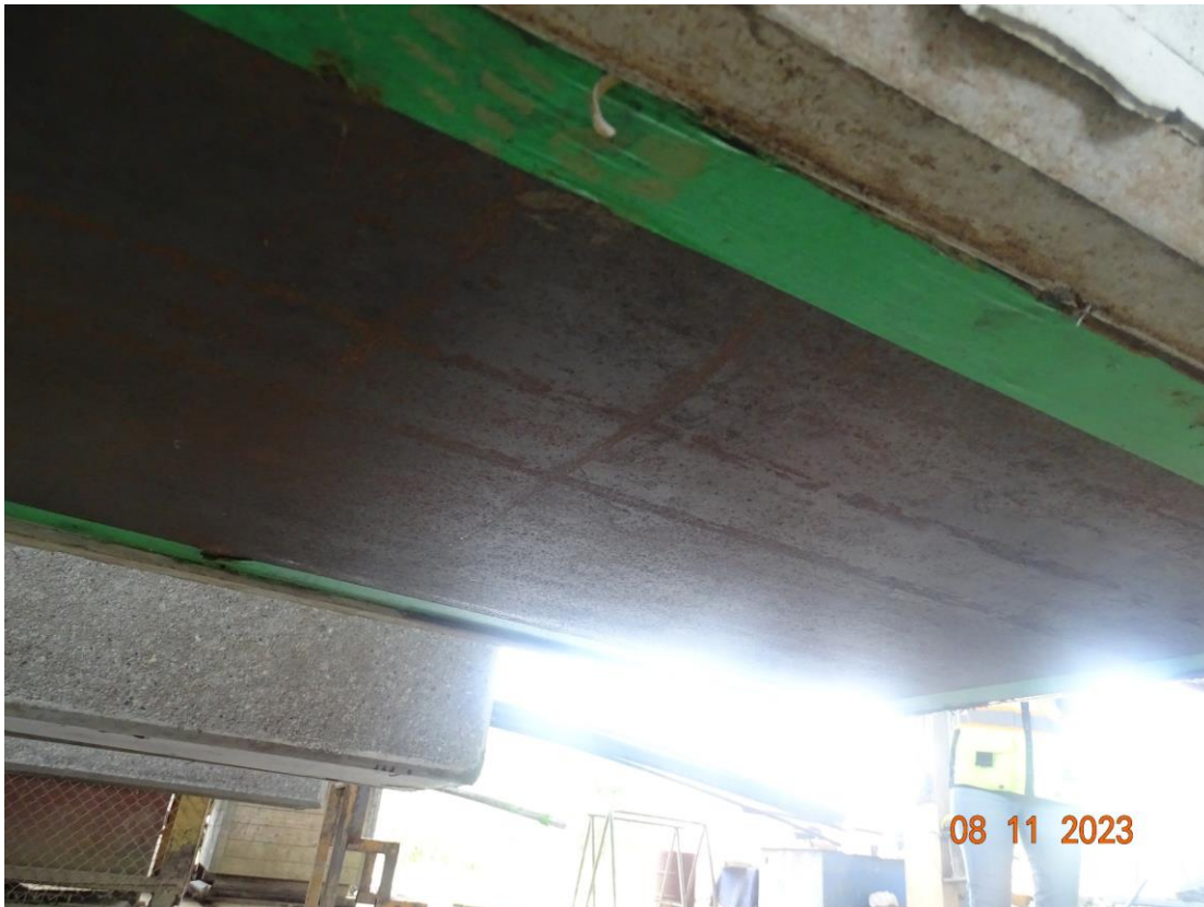
Figura 16. Óxido en las placas ubicadas bajo las vigas para dispositivos de apoyo
