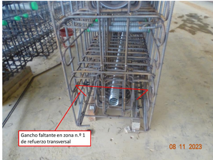
Figura 4. Ganchos faltantes en zona n.º 1 de refuerzo transversal en viga de superestructura n.º 4
