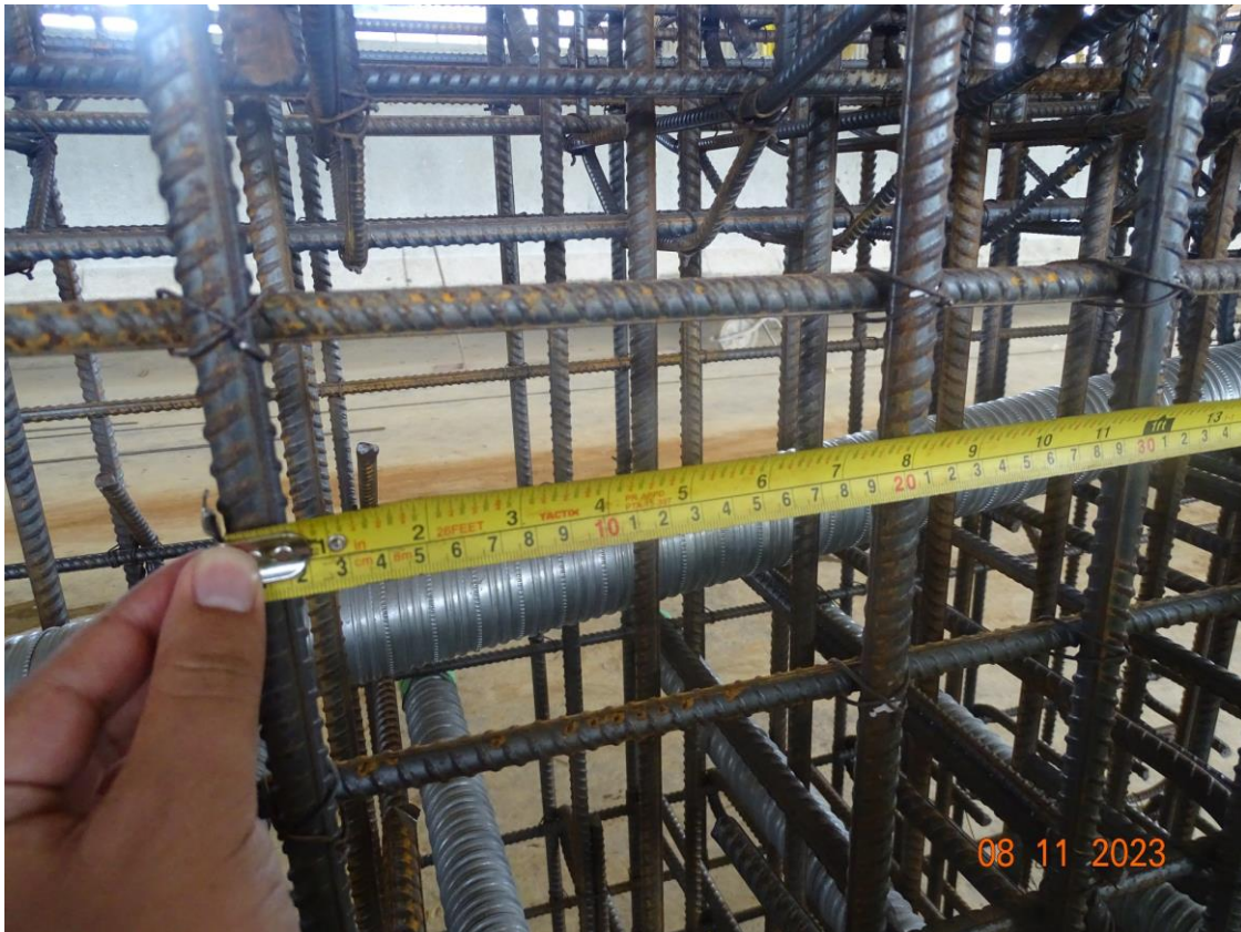
Figura 2. Revisión de aros en zona 3 de refuerzo transversal en viga de superestructura n.º 5
