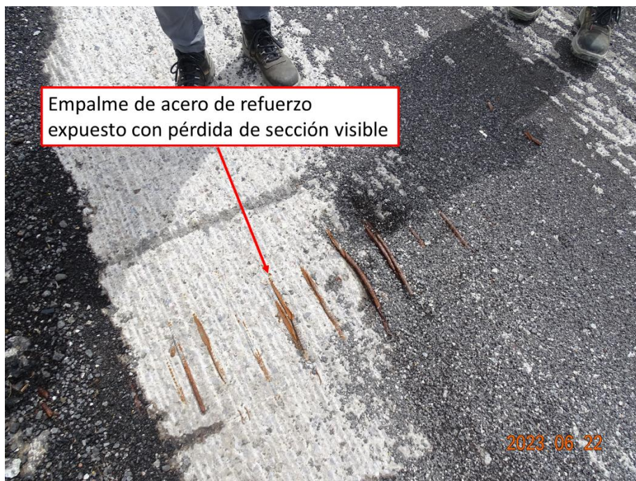
Figura 3. Zona del tablero de la superestructura n.º 2 con acero expuesto y oxidado con pérdida de sección
