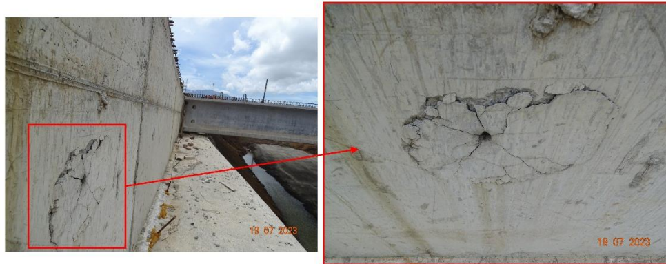
Figura 18. Desprendimientos de concreto en pared de cabezal del bastión norte del paso inferior (Tramo 2).
