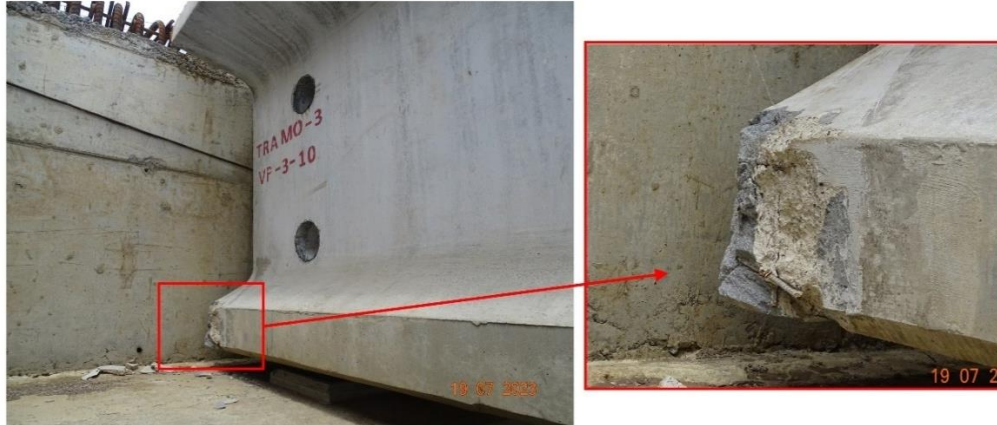
Figura 23. Desprendimiento con acero expuesto en el extremo sur de una de las vigas principales del paso inferior (Tramo 3).
