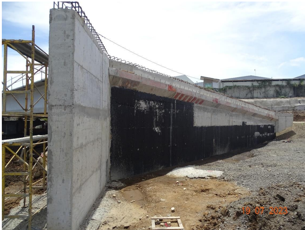
Figura 4. Parte trasera del Bastión 2 del viaducto durante la inspección realizada. No se observó ningún sistema de drenaje detrás del bastión.
