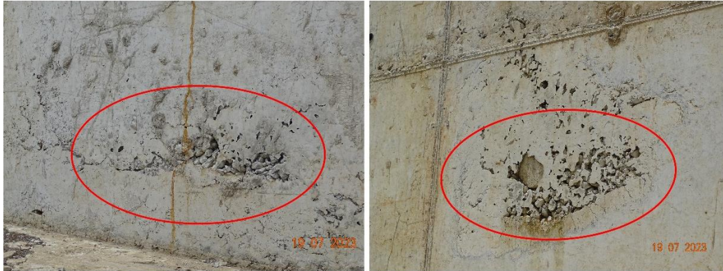
Figura 24. Nidos de piedra en pared de cabezal del bastión sur del paso inferior (Tramo 4).
