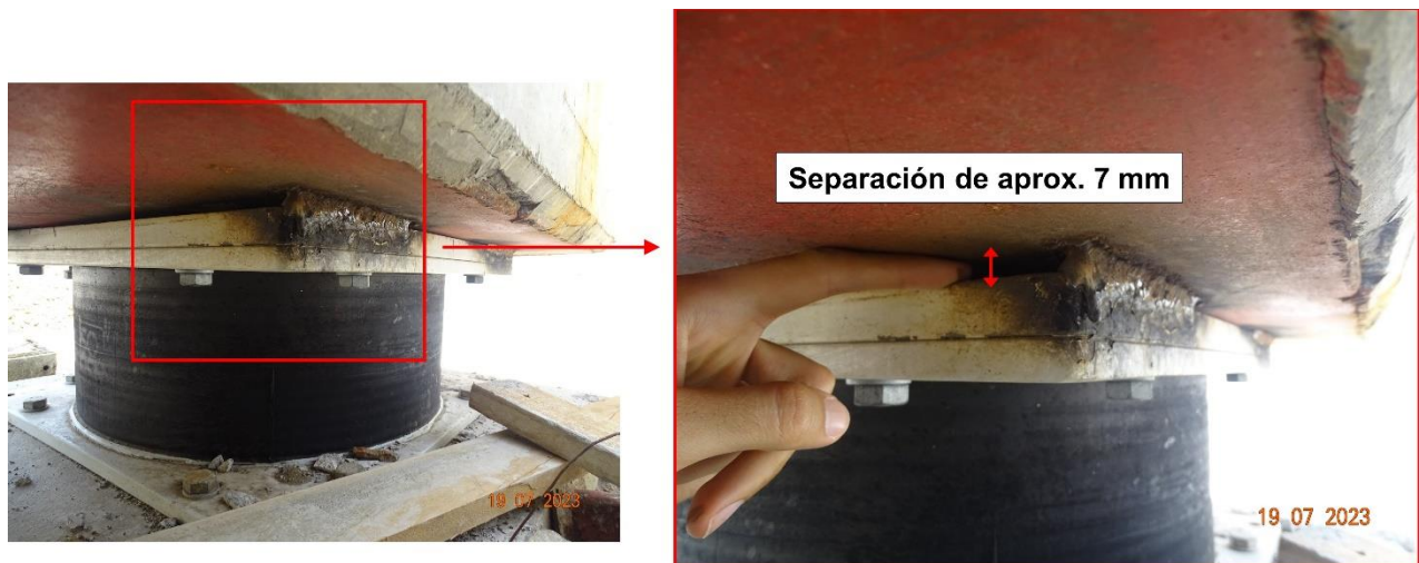
Figura 9. Separación entre la placa superior de aislador sísmico del Bastión 2 y la placa de acero que está embebida en la viga principal.
