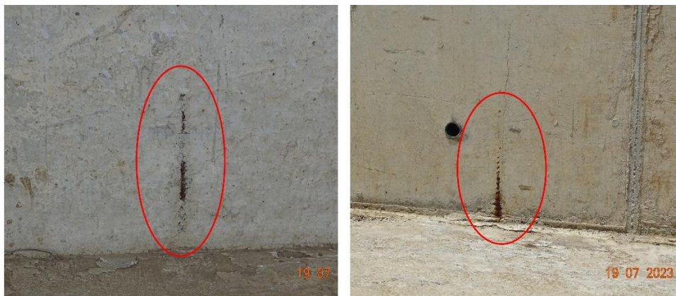
Figura 26. Varillas expuestas en pared de cabezal del bastión sur del paso inferior (Tramo 4). En apariencia las varillas expuestas no forman parte del acero de refuerzo del elemento.
