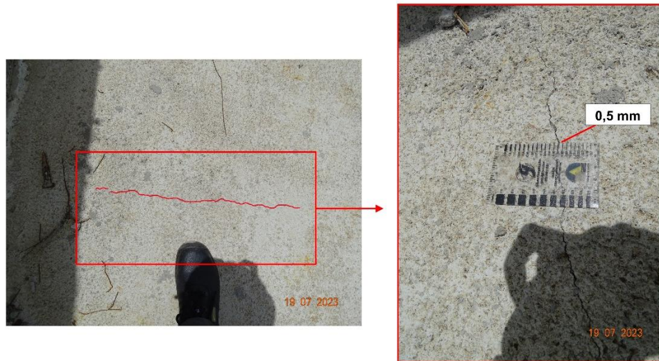
Figura 16. Grieta aislada en viga cabezal del bastión norte del paso inferior (Tramo 2).
