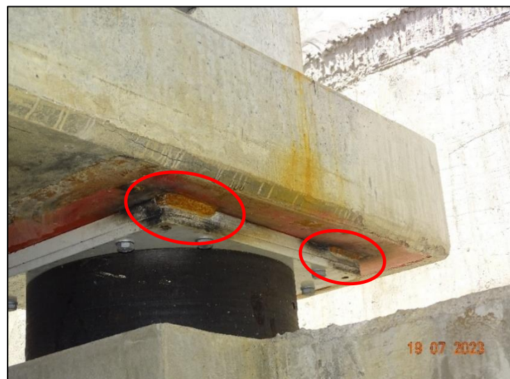
Figura 7. Problemas de oxidación en cordón de soldadura realizada por tractos en aislador sísmico tipo LRB del Bastión 2.
