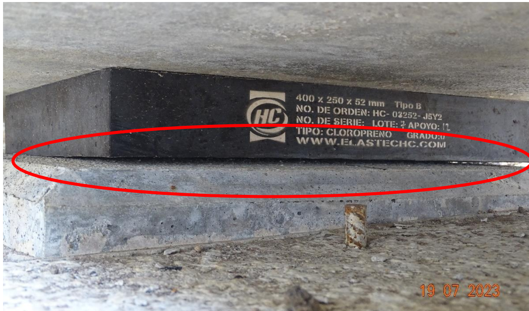
Figura 21. Levantamiento parcial del apoyo elastomérico del extremo norte de una de las vigas principales del paso inferior (Tramo 3).
