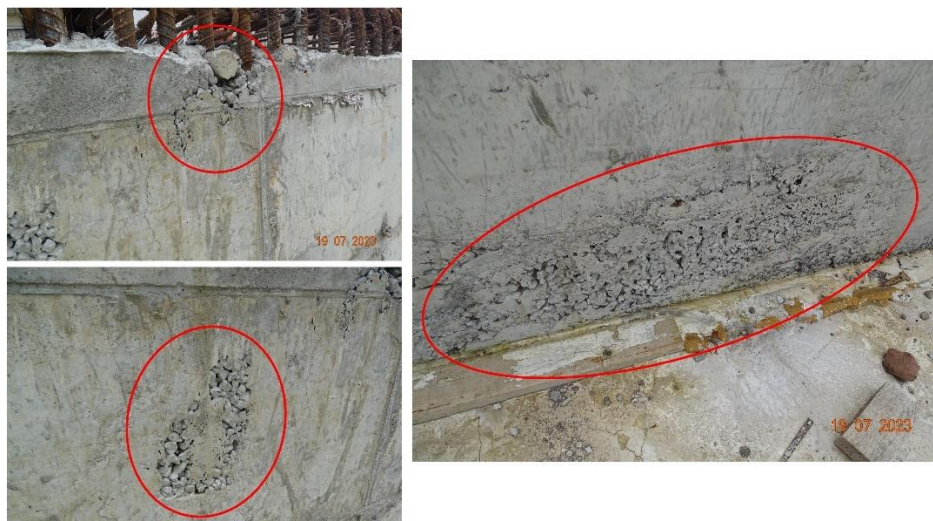
Figura 17. Nidos de piedra en pared de cabezal del bastión norte del paso inferior (Tramo 2).
