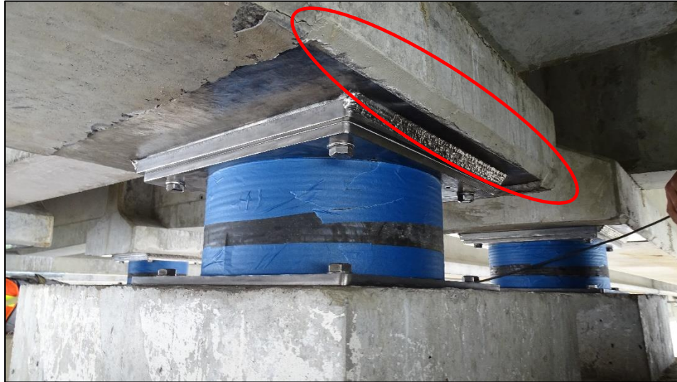
Figura 11. Mortero aplicado para restituir el recubrimiento de concreto desprendido en las vigas principales del viaducto en las Unidades Funcionales III y IV.
