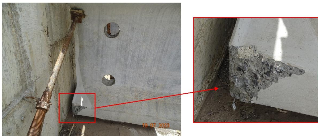
Figura 22. Desprendimiento en el extremo norte de una de las vigas principales del paso inferior (Tramo 3).
