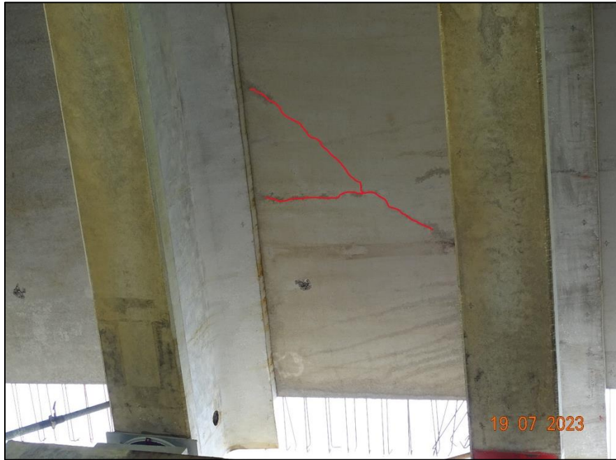
Figura 12. Agrietamiento observado en una de las prelasas del tablero del Tramo 55 del viaducto.
