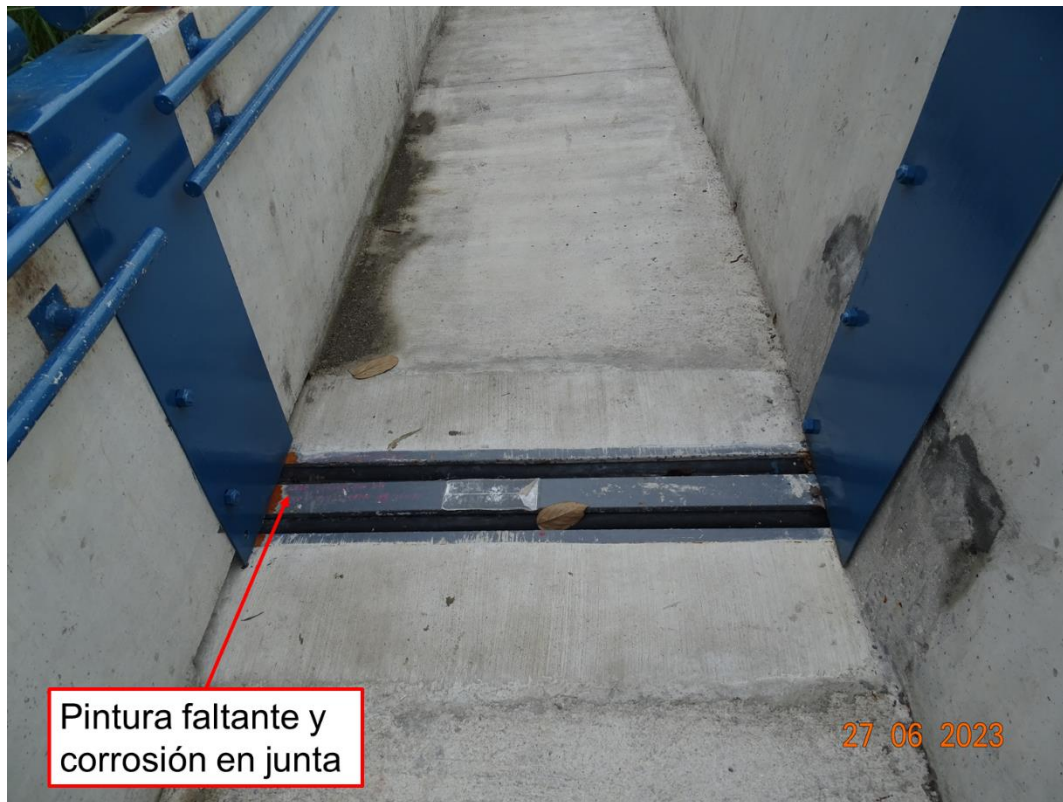
Figura 71. Desprendimientos de pintura y óxido en componentes de la junta de expansión
