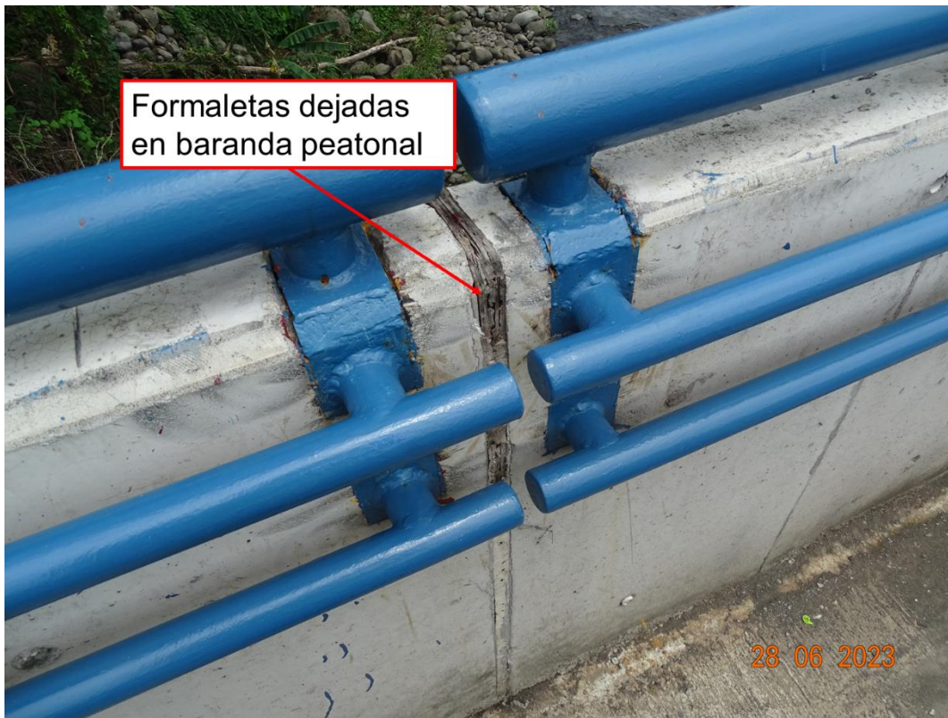
Figura 43. Formaleta no removida en baranda peatonal del puente
