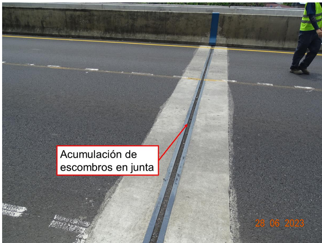
Figura 40. Acumulación de escombros en sello de junta de expansión
