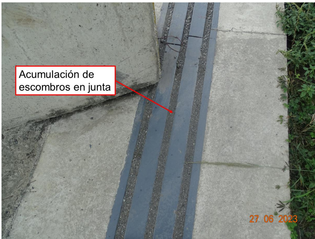
Figura 50. Acumulación de escombros en sello de junta de expansión
