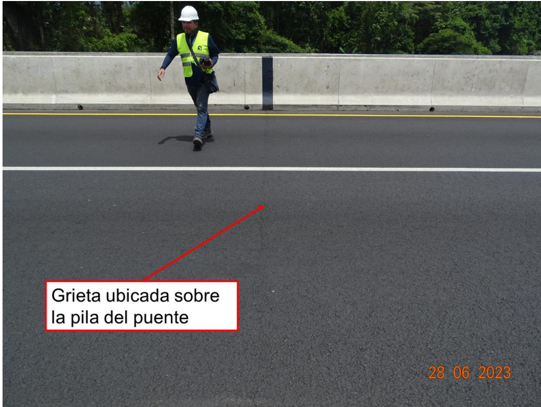
Figura 91. Grieta en la superficie de desgaste del puente sobre la pila n.º 1
