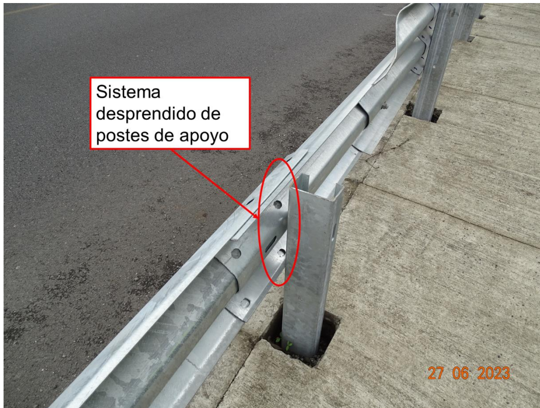
Figura 4. Sistema de contención vehicular desprendido de postes de apoyo
