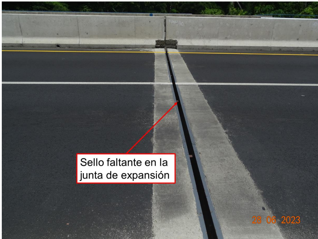
Figura 90. Sello faltante en la junta de expansión
