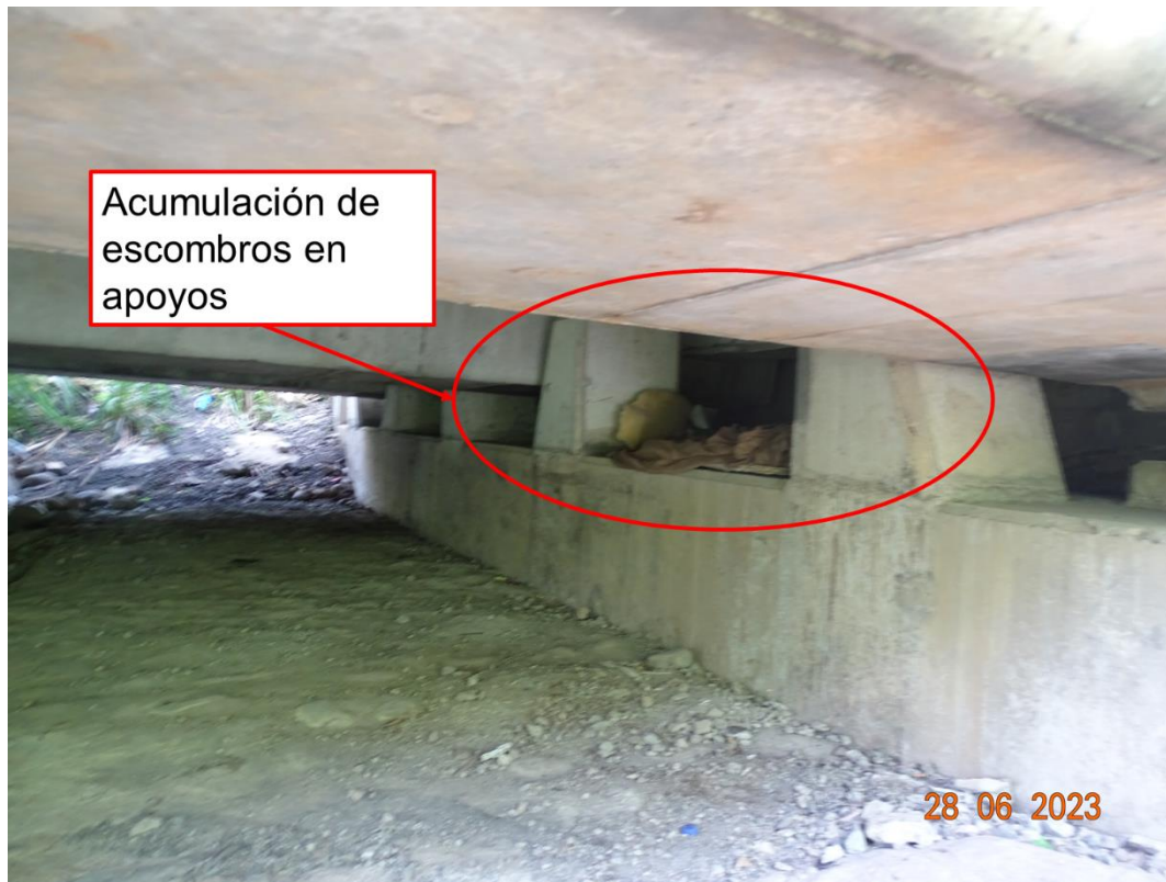
Figura 49. Acumulación de escombros alrededor de dispositivo de apoyo
