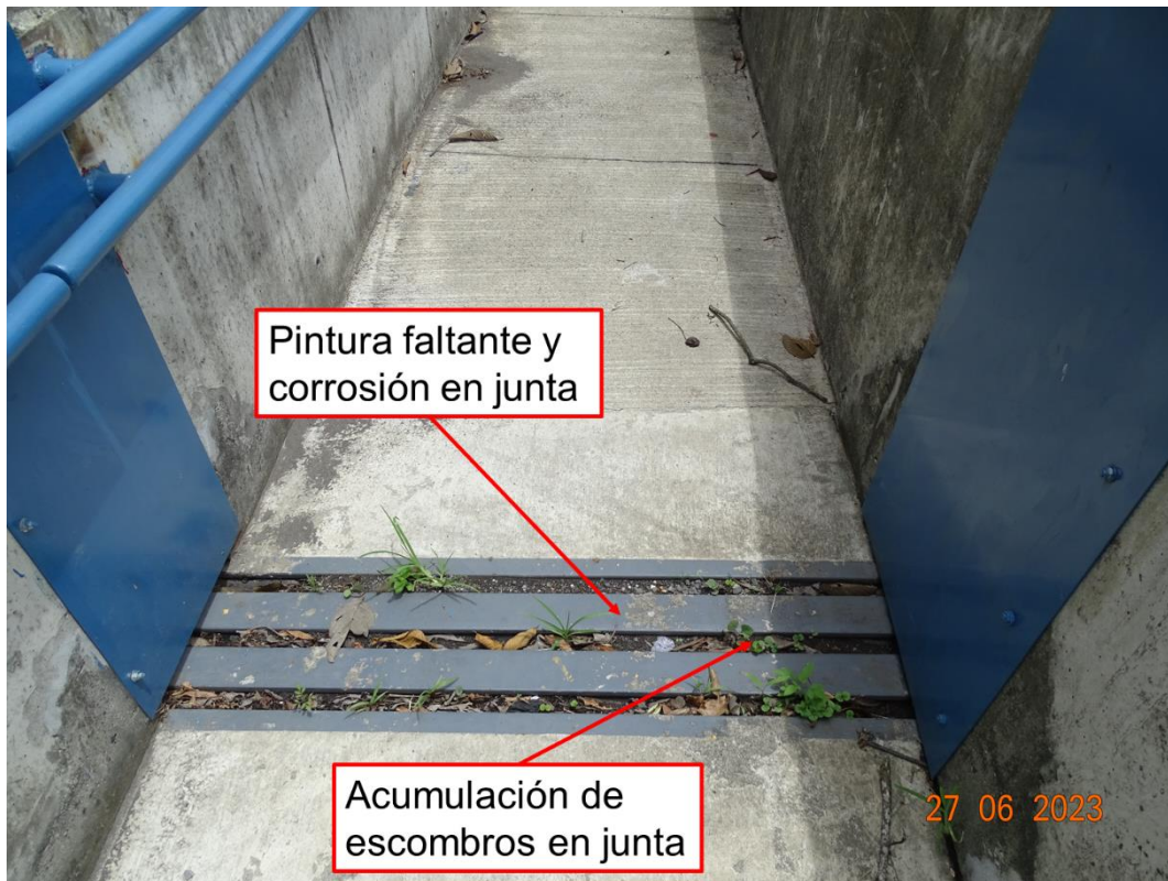
Figura 25. Desprendimientos de pintura y óxido en componentes de la junta y acumulación de escombros en sello
