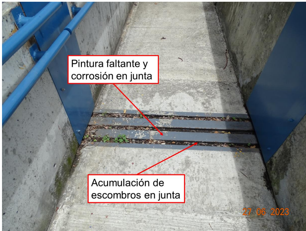
Figura 21. Desprendimientos de pintura y óxido en componentes de la junta y acumulación de escombros en sello
