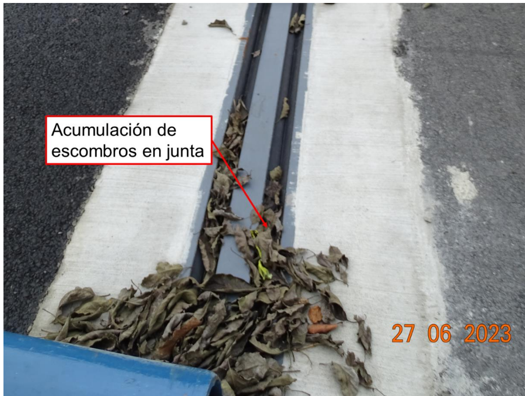
Figura 72. Acumulación de escombros en sello de junta de expansión
