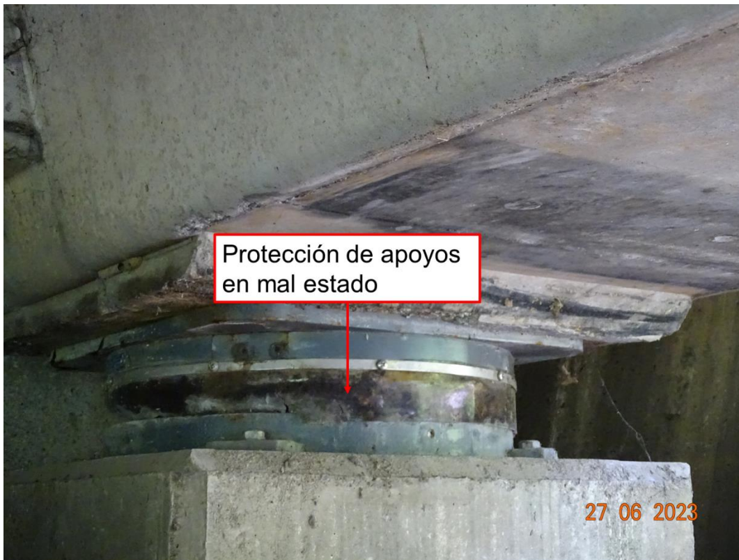
Figura 27. Apoyos de péndulo de fricción con protección en mal estado
