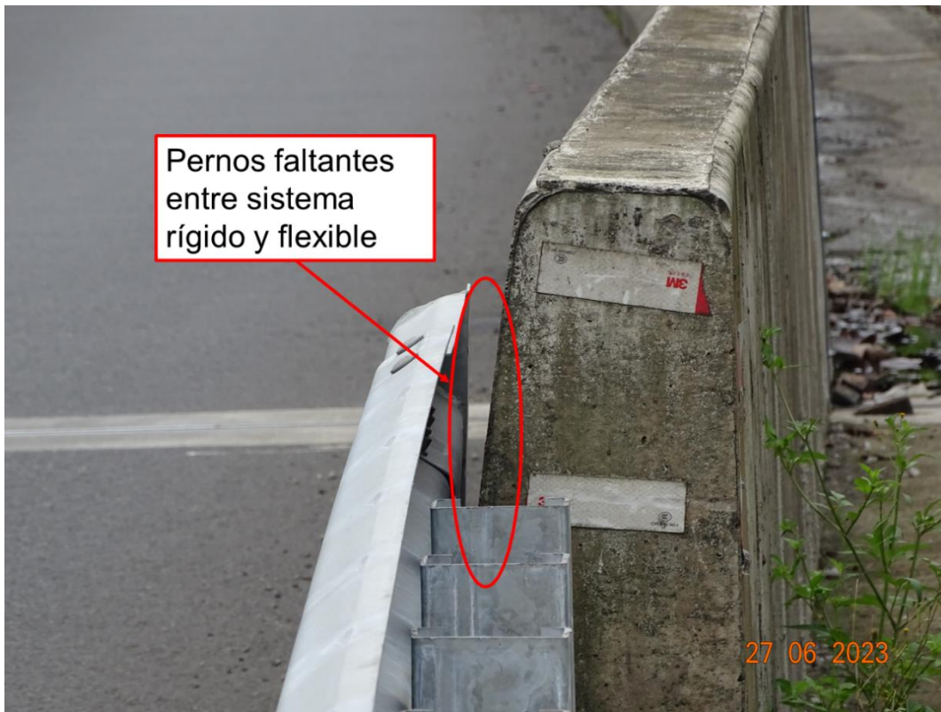
Figura 3. Falta de conexión entre sistemas de contención vehicular rígido y flexible
