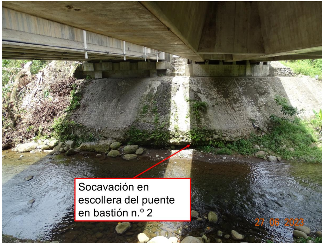
Figura 37. Socavación en escollera del puente en bastión n.º 2
