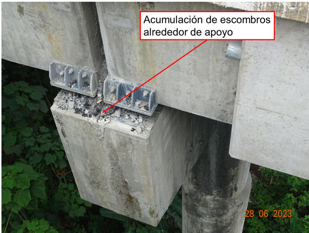
Figura 99. Corrosión en los dispositivos de apoyo del puente
