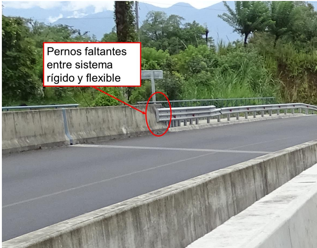
Figura 9. Falta de conexión entre sistemas de contención vehicular rígido y flexible
