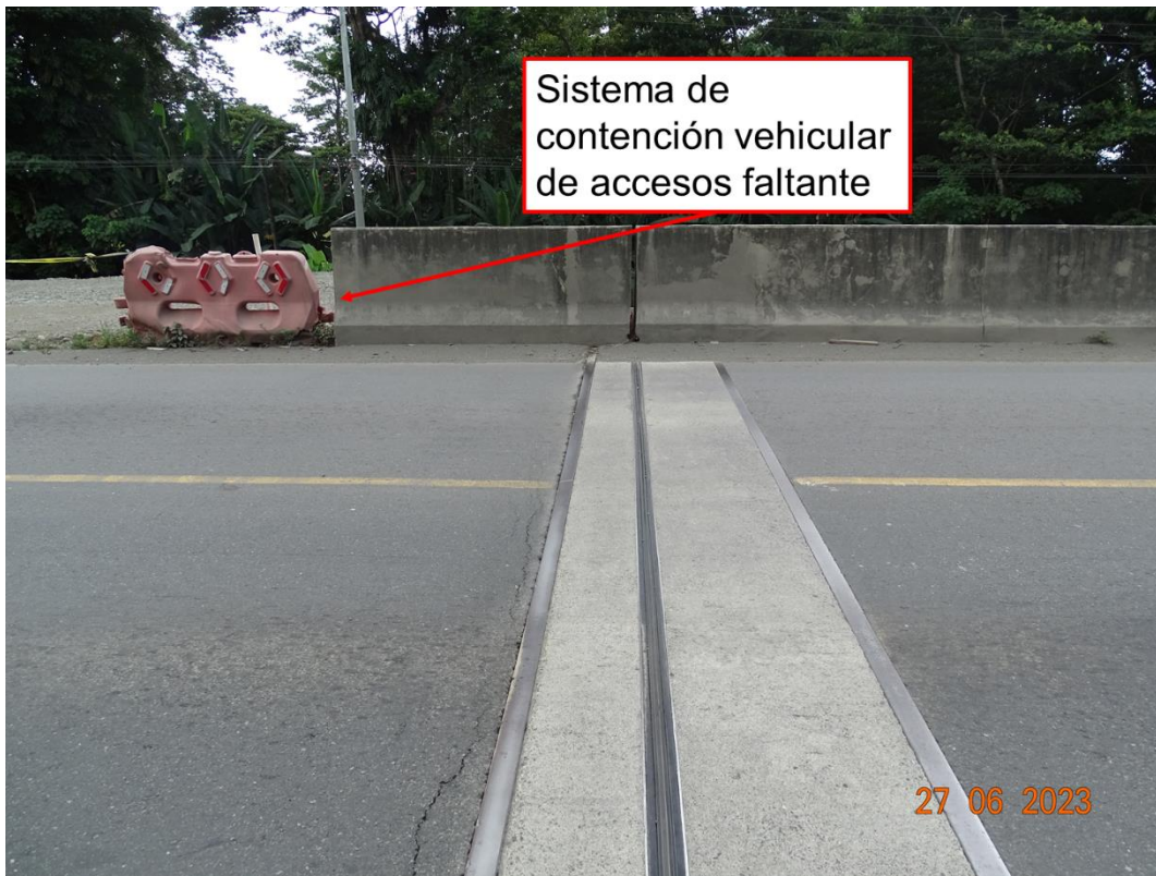
Figura 59. Sistema de contención vehicular faltante en los accesos al puente
