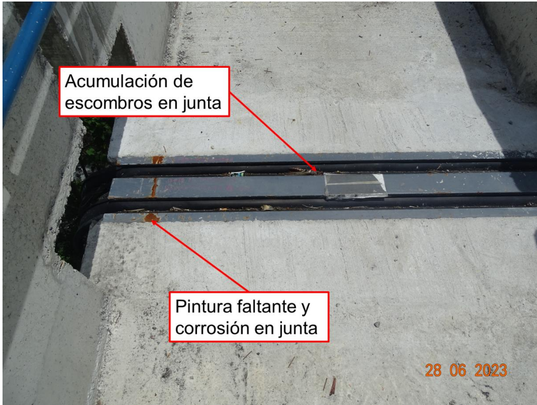
Figura 97. Desprendimientos de pintura, óxido en componentes de la junta y acumulación de escombros en el sello de junta de expansión
