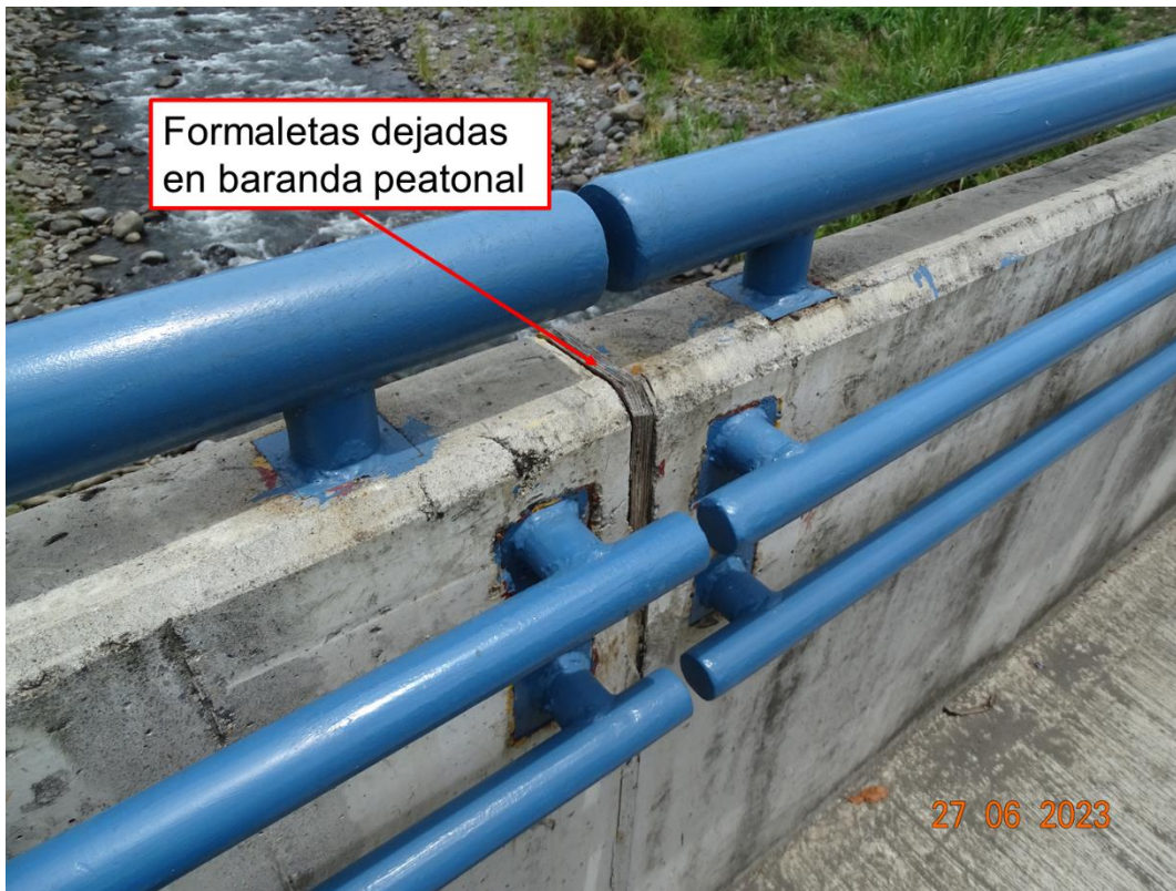
Figura 33. Formaleta dejada en baranda peatonal del puente
