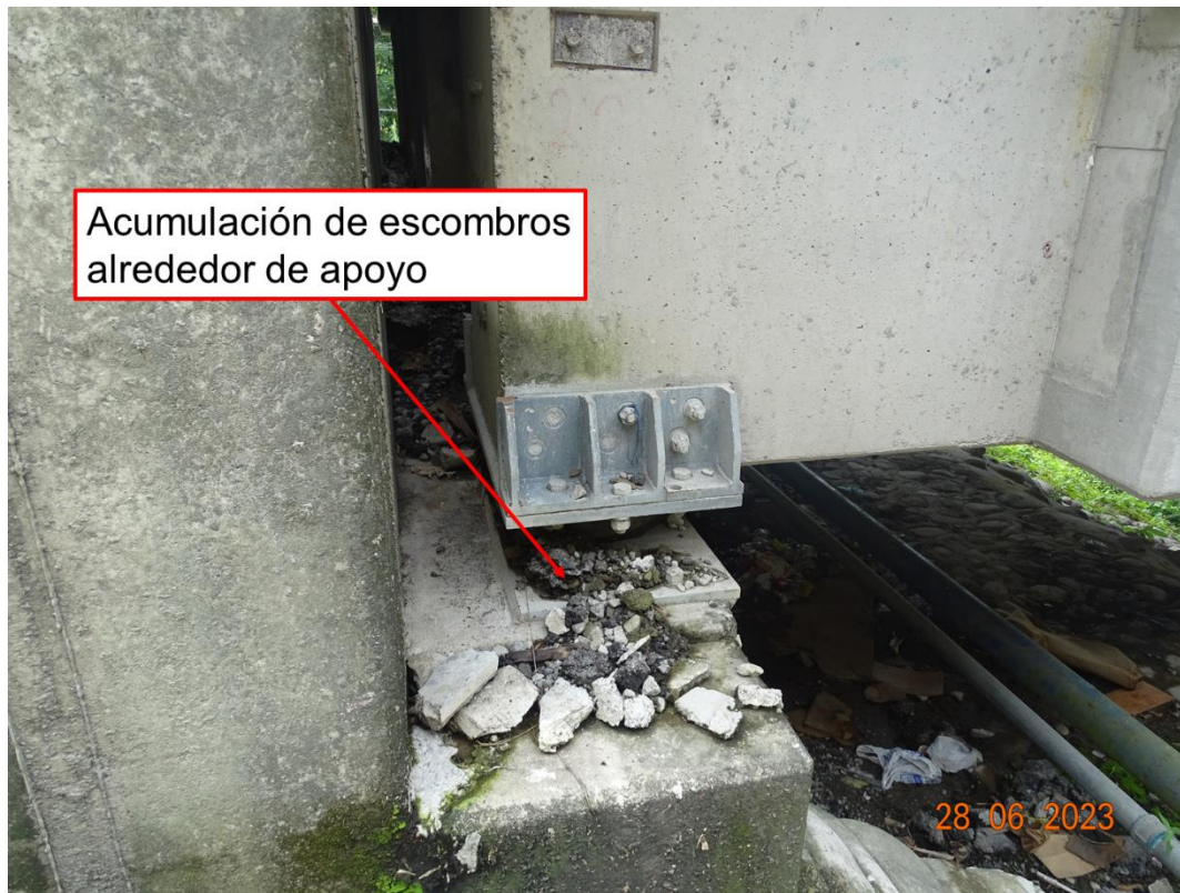
Figura 94. Acumulación de escombros alrededor de dispositivo de apoyo
