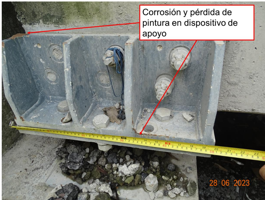
Figura 95. Corrosión en los dispositivos de apoyo del puente
