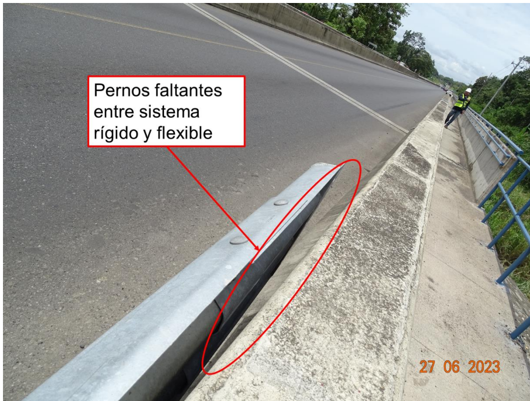
Figura 31. Falta de conexión entre sistemas de contención vehicular rígido y flexible
