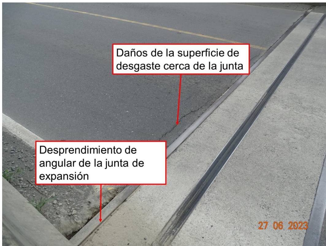
Figura 55. Angulares de la junta de expansión del puente sobre el río Madre LD desprendidos del concreto
