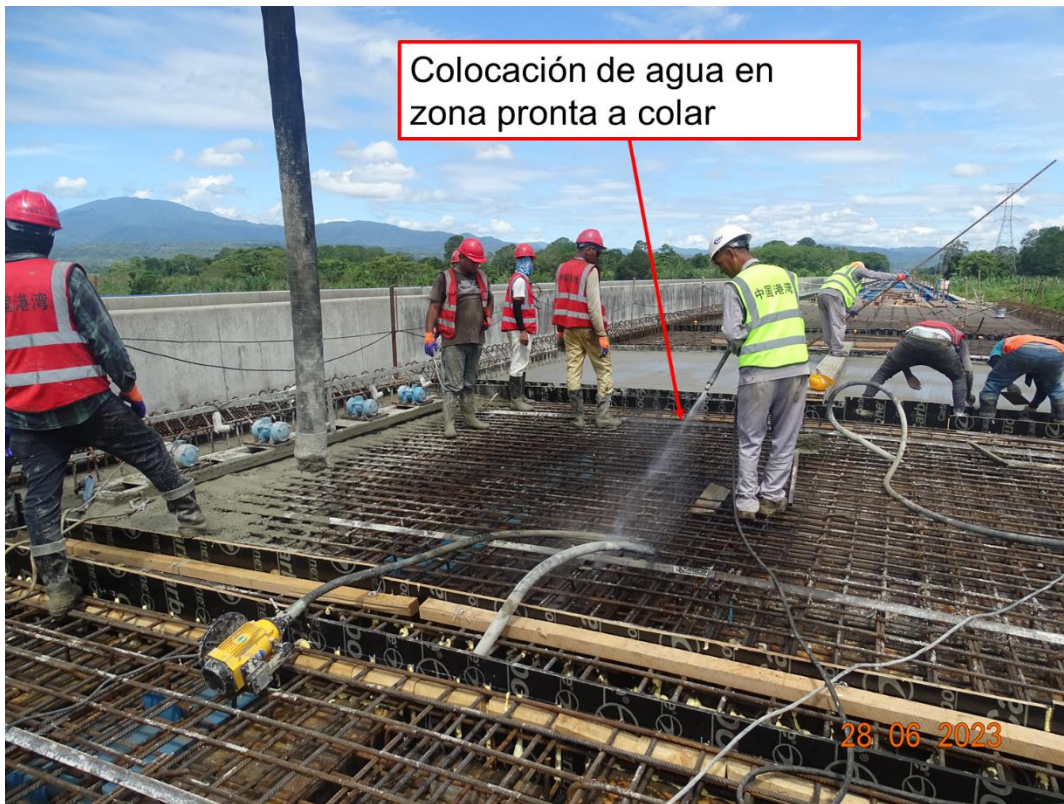
Figura 103. Colocación de agua en la zona pronta a colar minutos antes del colado
