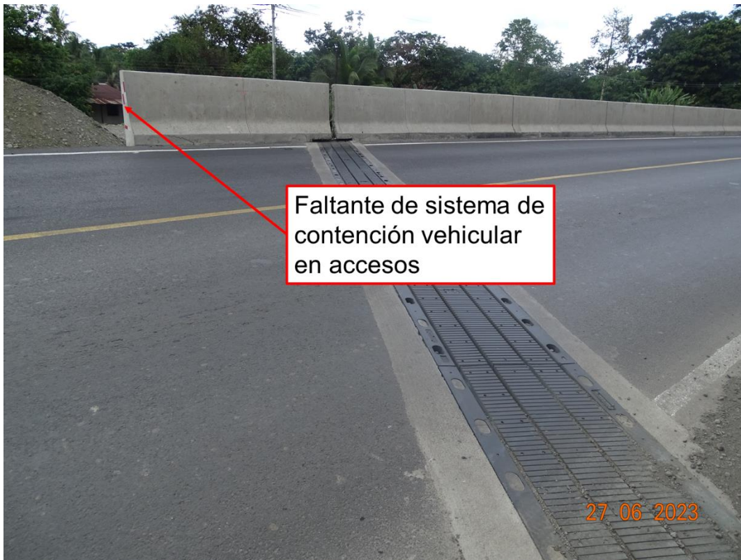
Figura 64. Sistema de contención vehicular faltante en los accesos al puente
