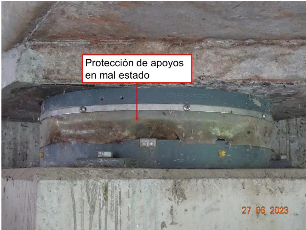
Figura 53. Apoyos de péndulo de fricción con protección en mal estado
