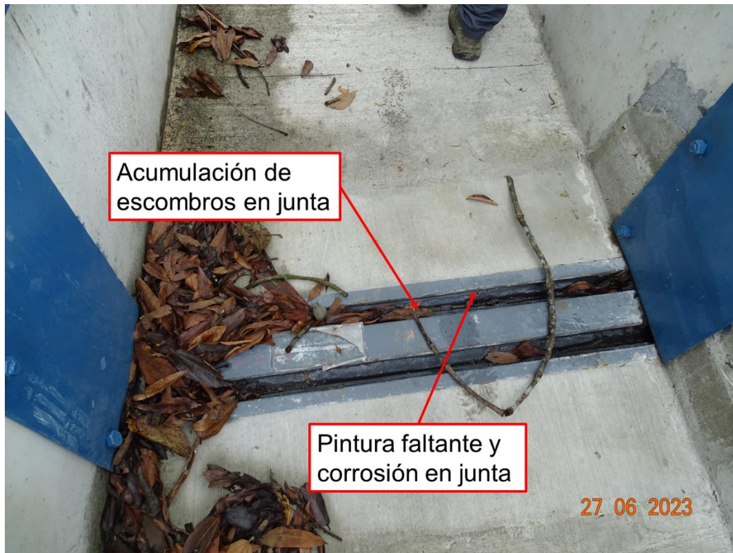
Figura 66. Desprendimientos de pintura y óxido en componentes de la junta y acumulación de escombros en sello
