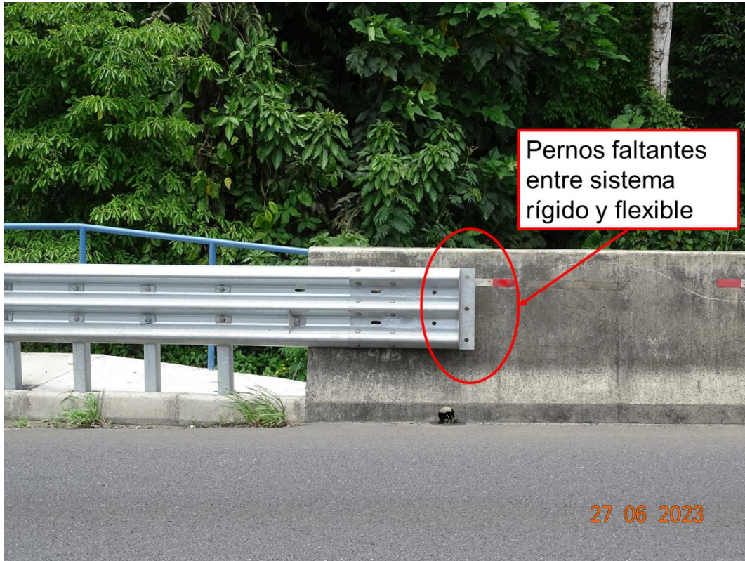
Figura 26. Falta de conexión entre sistemas de contención vehicular rígido y flexible
