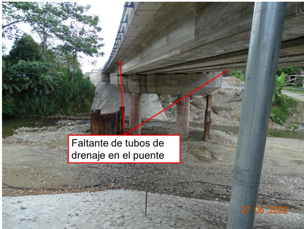
Figura 63. Faltante de tubos de drenaje en todo el puente
