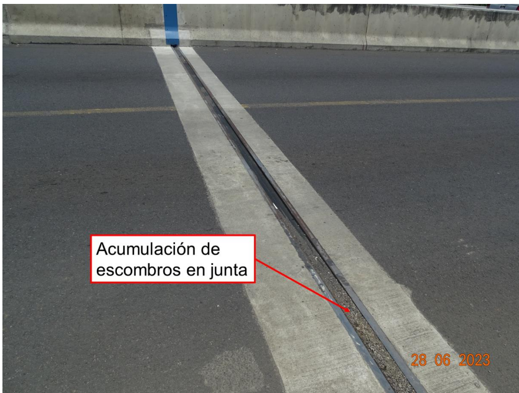
Figura 46. Acumulación de escombros en sello de junta de expansión
