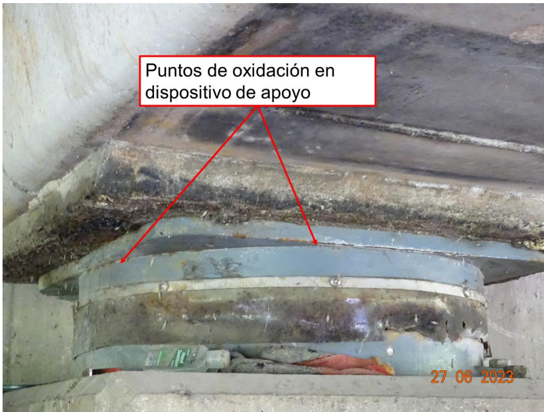
Figura 29. Puntos de oxidación y corrosión en dispositivos de apoyo del puente
