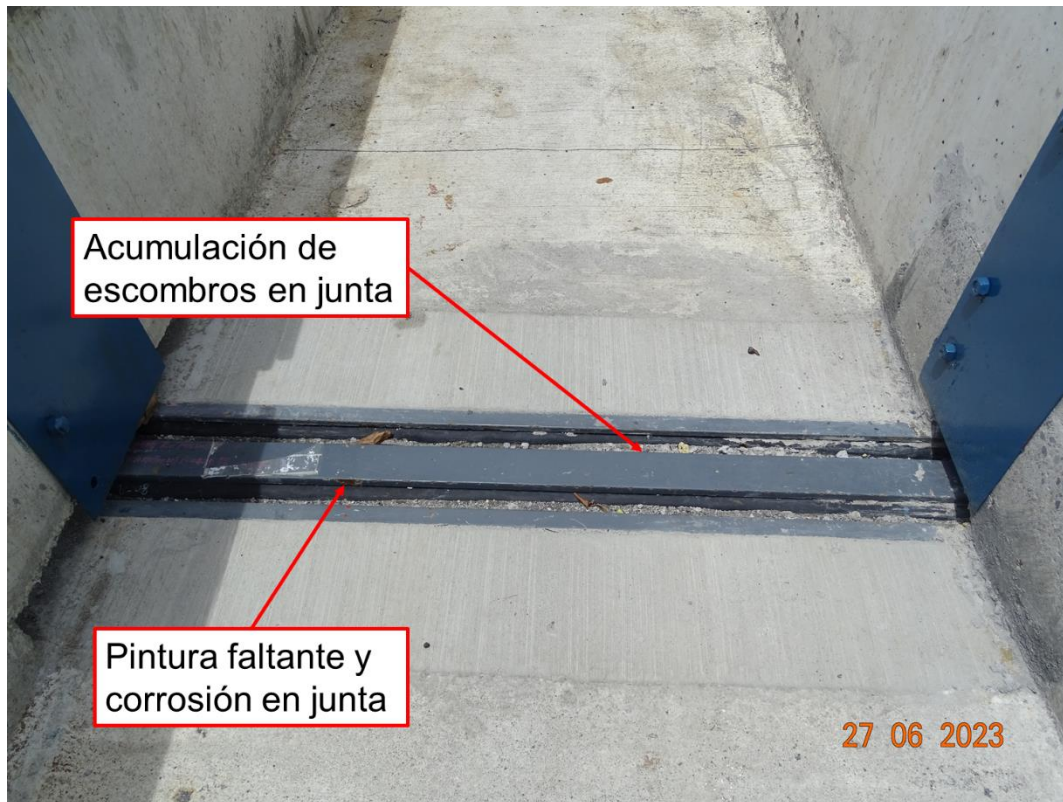
Figura 89. Desprendimientos de pintura, óxido en componentes de la junta y acumulación de escombros en el sello de junta de expansión
