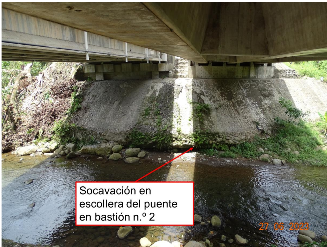
Figura 88. Socavación en la escollera del puente en el bastión n.º 2
