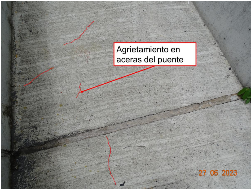
Figura 86. Agrietamiento en las aceras del puente
