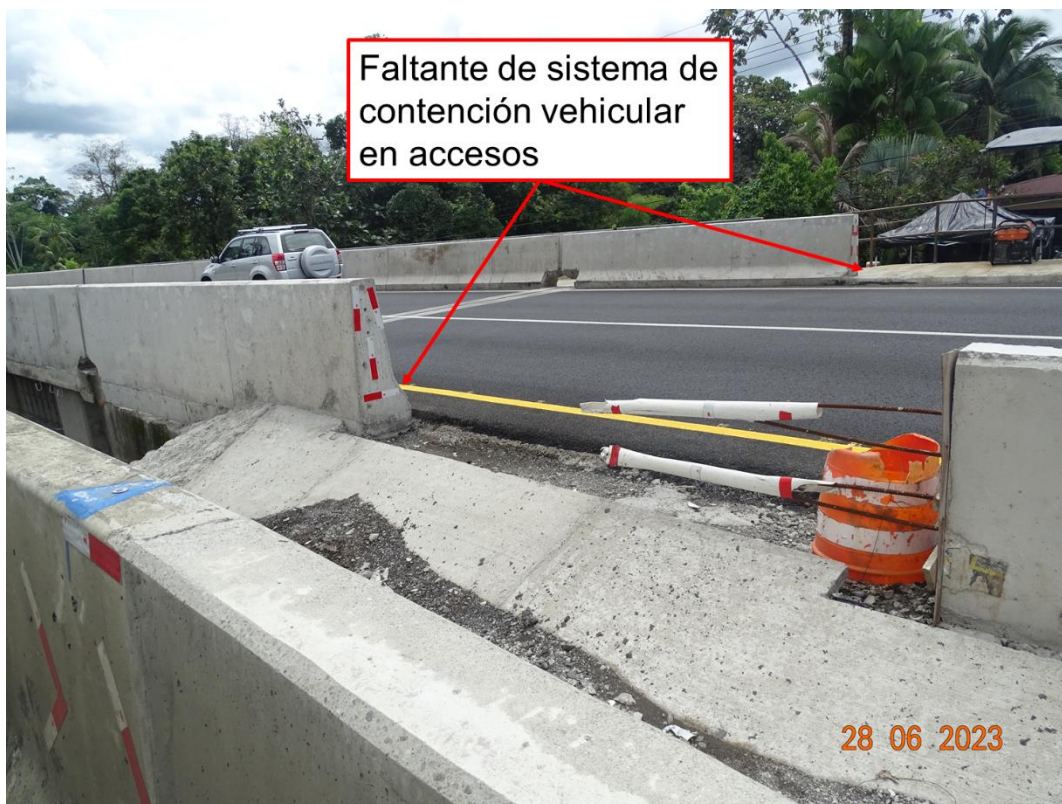
Figura 93. Sistema de contención vehicular faltante en los accesos al puente
