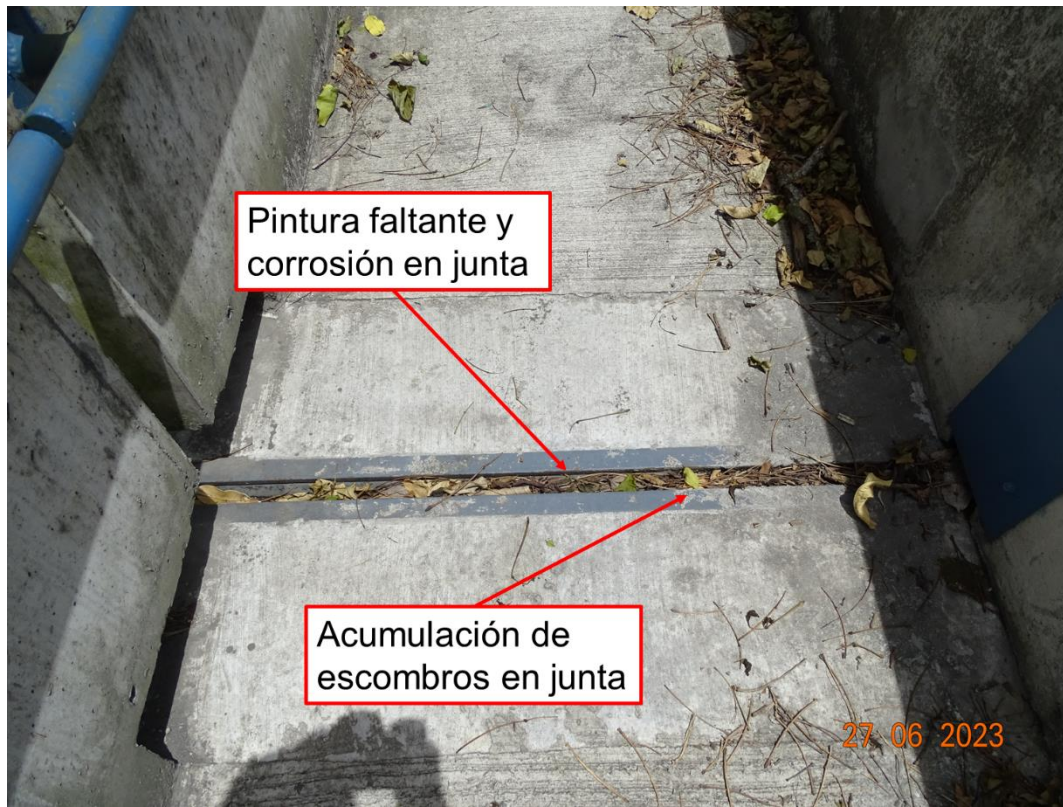
Figura 19. Desprendimientos de pintura y óxido en componentes de la junta y acumulación de escombros en sello
