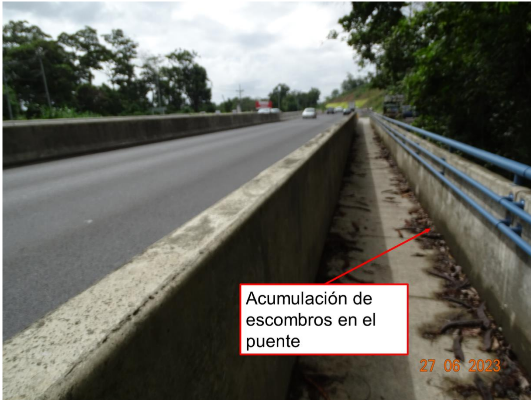
Figura 12. Acumulación de escombros en el puente que ocasiona la obstrucción de drenajes
