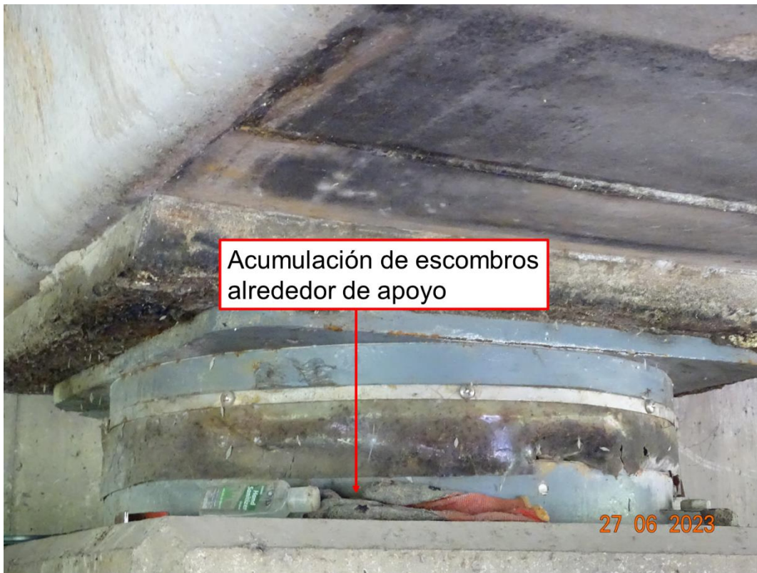
Figura 28. Acumulación de escombros alrededor de dispositivo de apoyo
