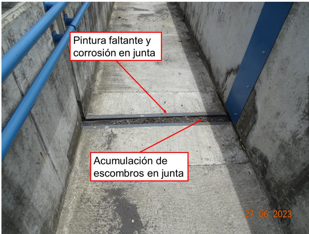
Figura 30. Desprendimientos de pintura y óxido en componentes de la junta y acumulación de escombros en sello
