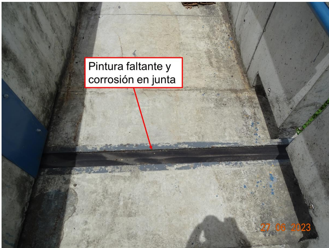
Figura 38. Desprendimientos de pintura y óxido en componentes de la junta
