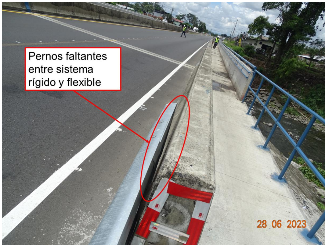
Figura 42. Falta de conexión entre sistemas de contención vehicular rígido y flexible
