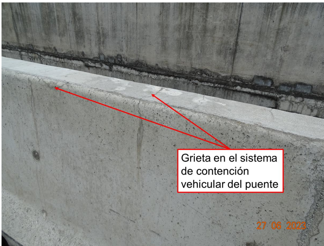
Figura 75. Grieta en el sistema de contención vehicular del puente
