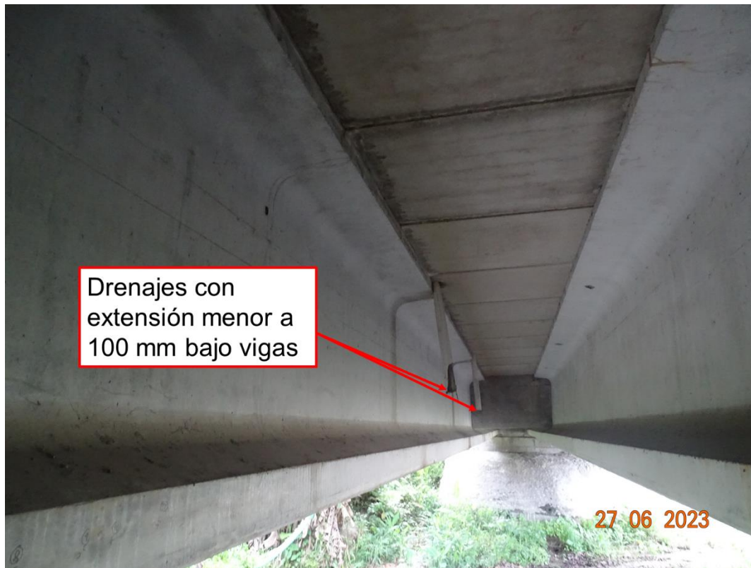
Figura 57. Drenajes con extensión menor a 100 mm por debajo de las vigas de la superestructura
