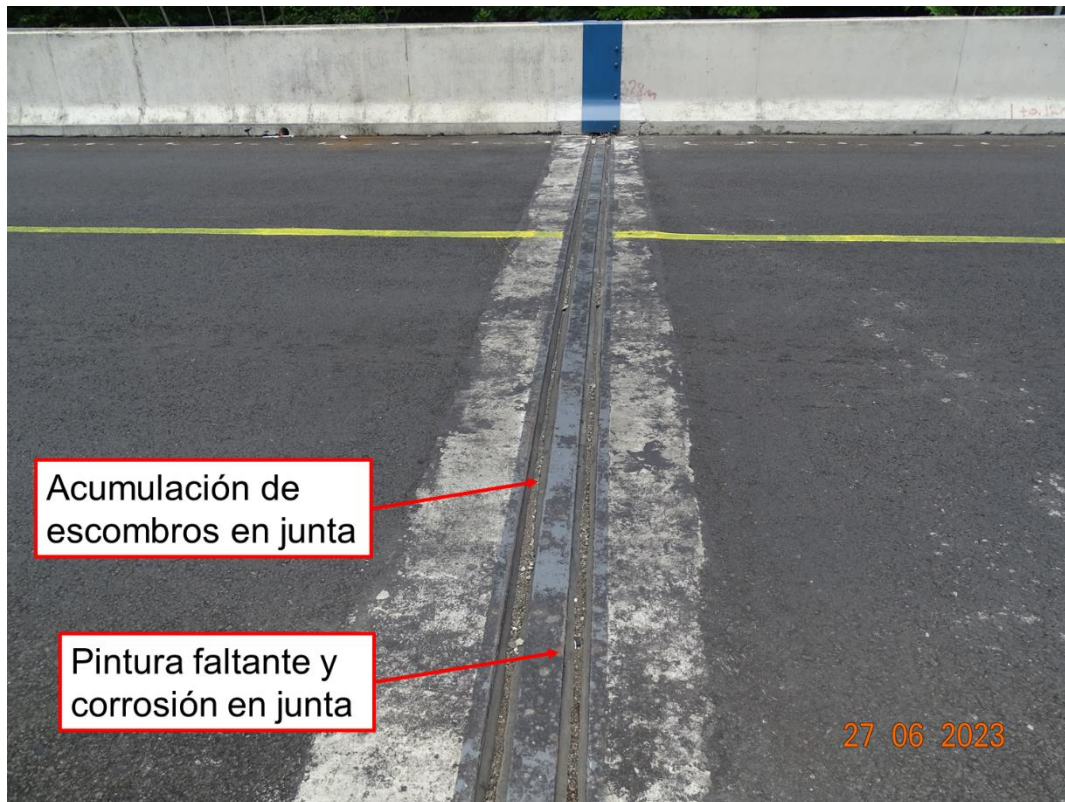
Figura 85. Desprendimientos de pintura, óxido en componentes de la junta y acumulación de escombros en el sello de junta de expansión
