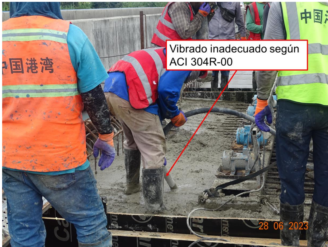
Figura 101. Prácticas inadecuadas de vibrado en el tablero del puente
