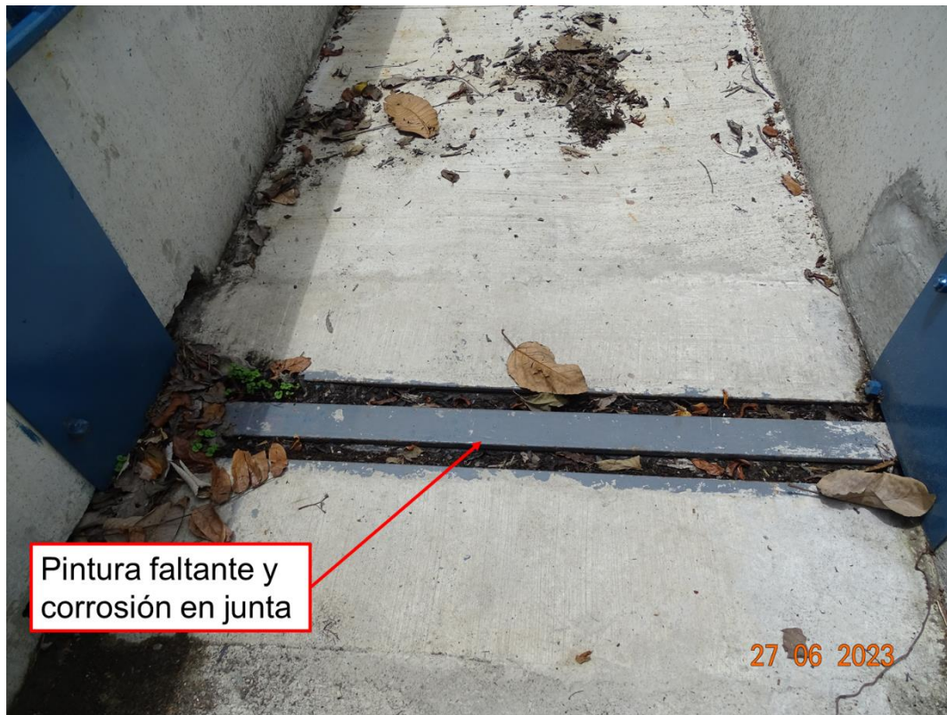
Figura 81. Desprendimientos de pintura y óxido en componentes de la junta de expansión
