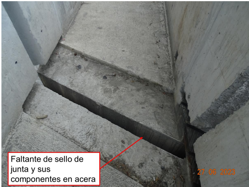
Figura 62. Faltante de instalación de sello de junta de expansión en aceras del puente sobre el río Blanco LD
