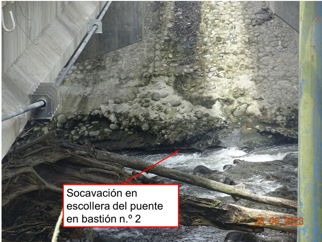
Figura 45. Socavación en escollera del puente en bastión n.º 2
