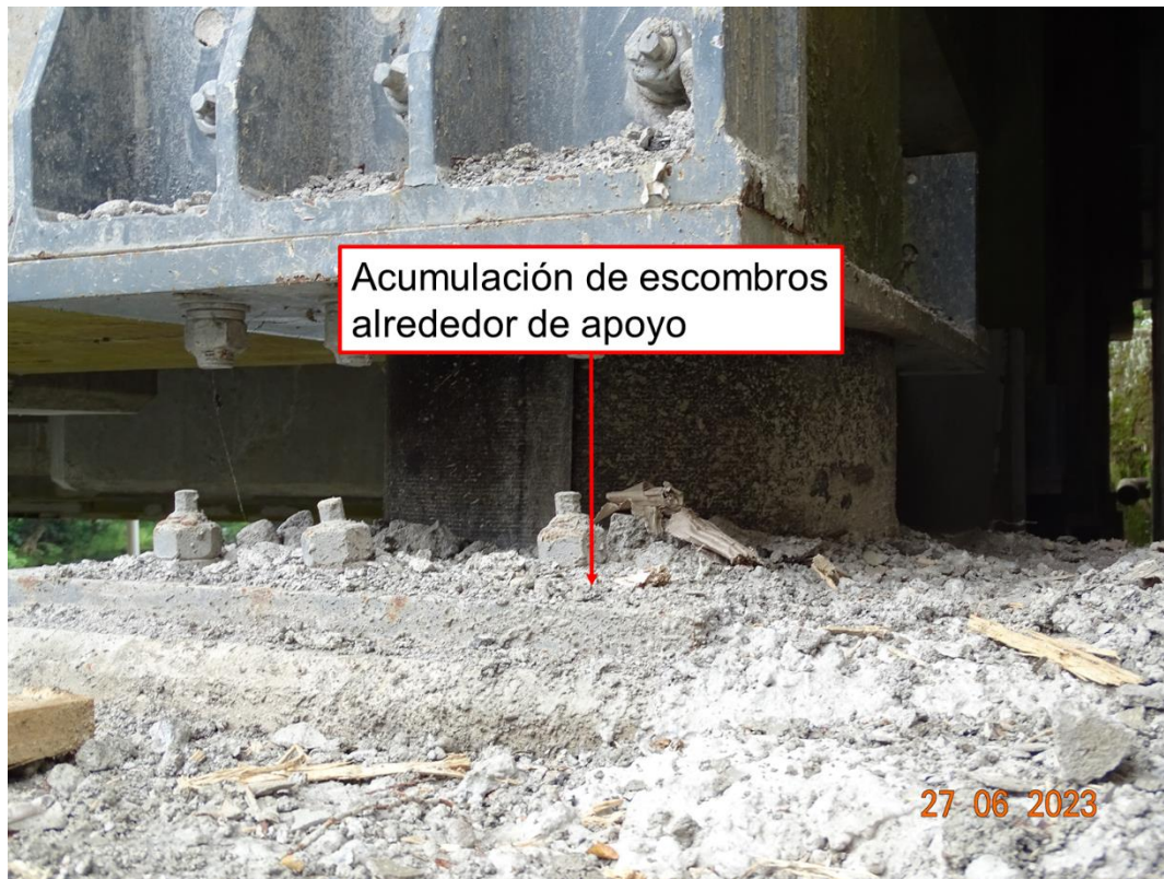
Figura 70. Acumulación de escombros alrededor de dispositivo de apoyo
