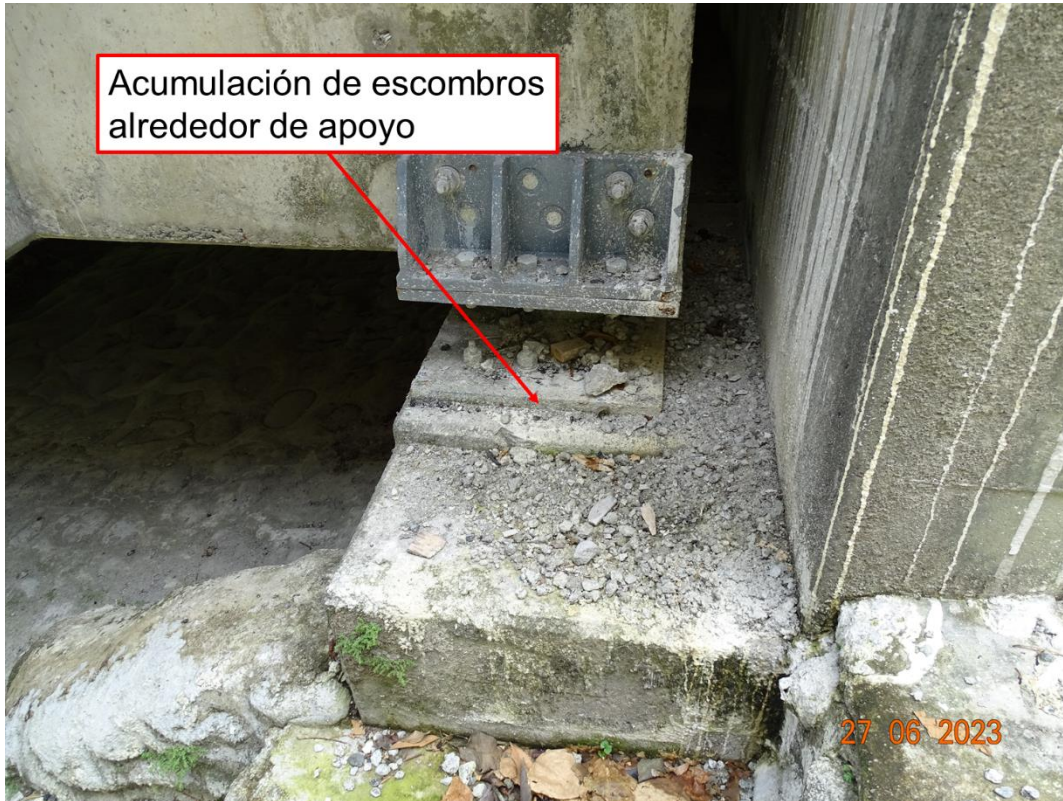
Figura 80. Acumulación de escombros alrededor de dispositivo de apoyo
