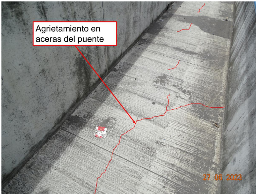
Figura 34. Agrietamiento en las aceras del puente
