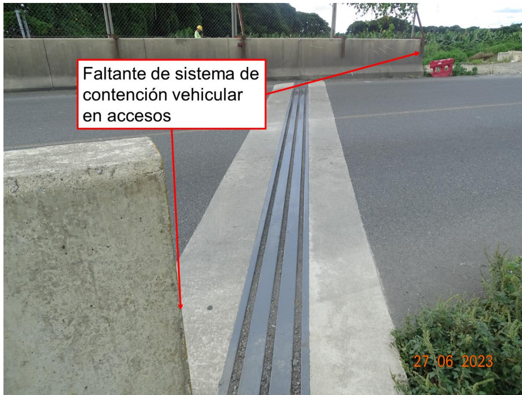
Figura 52. Faltante de sistema de contención vehicular en los accesos al puente
