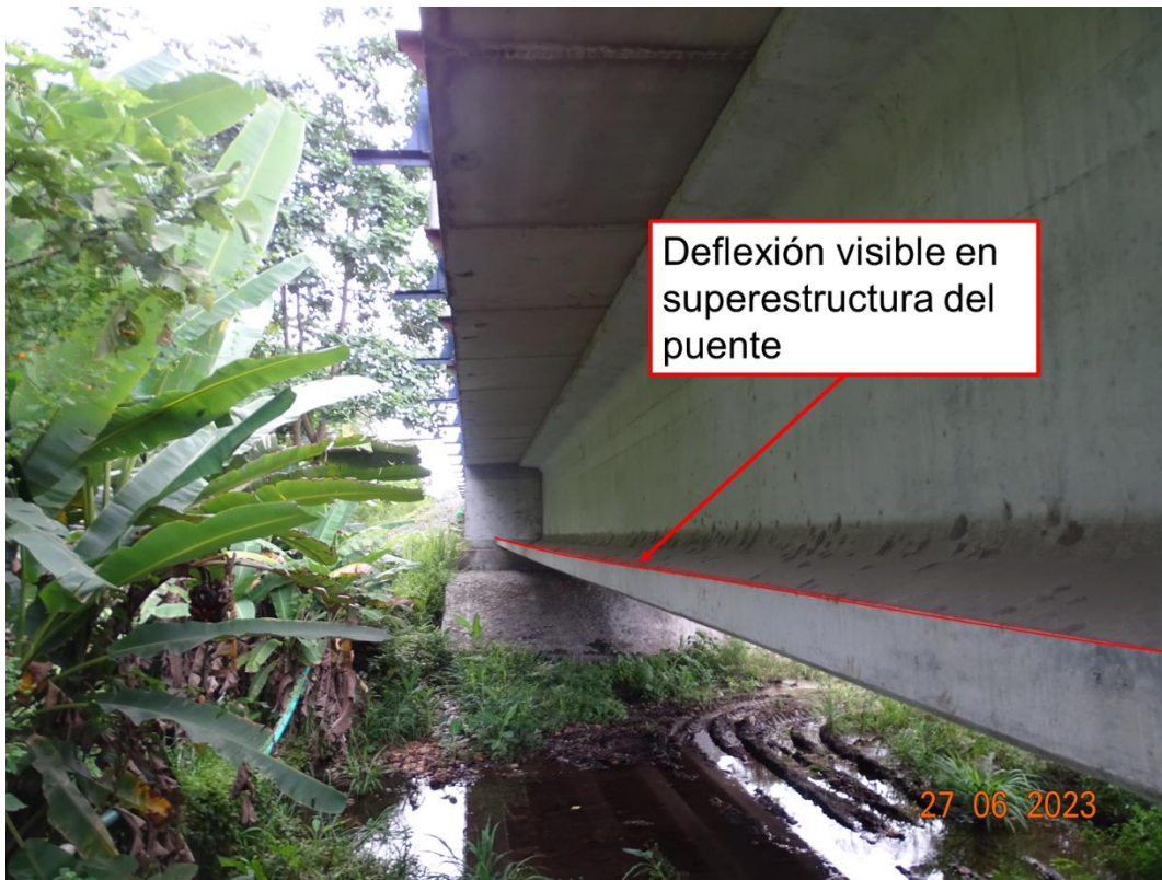
Figura 60. Deflexión visible en la superestructura del puente sobre el río Madre LD
