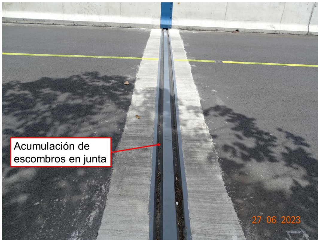
Figura 87. Acumulación de escombros en el sello de junta de expansión
