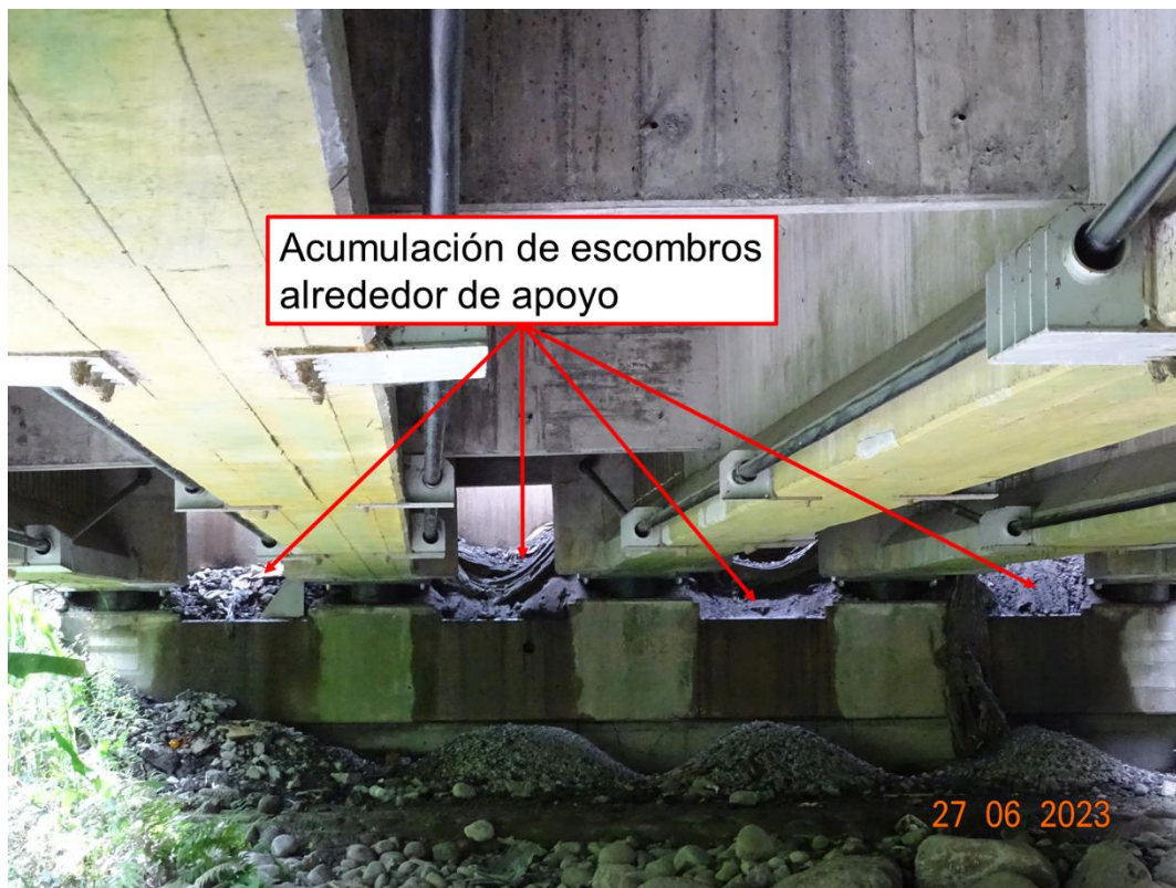
Figura 76. Acumulación de escombros alrededor de dispositivo de apoyo
