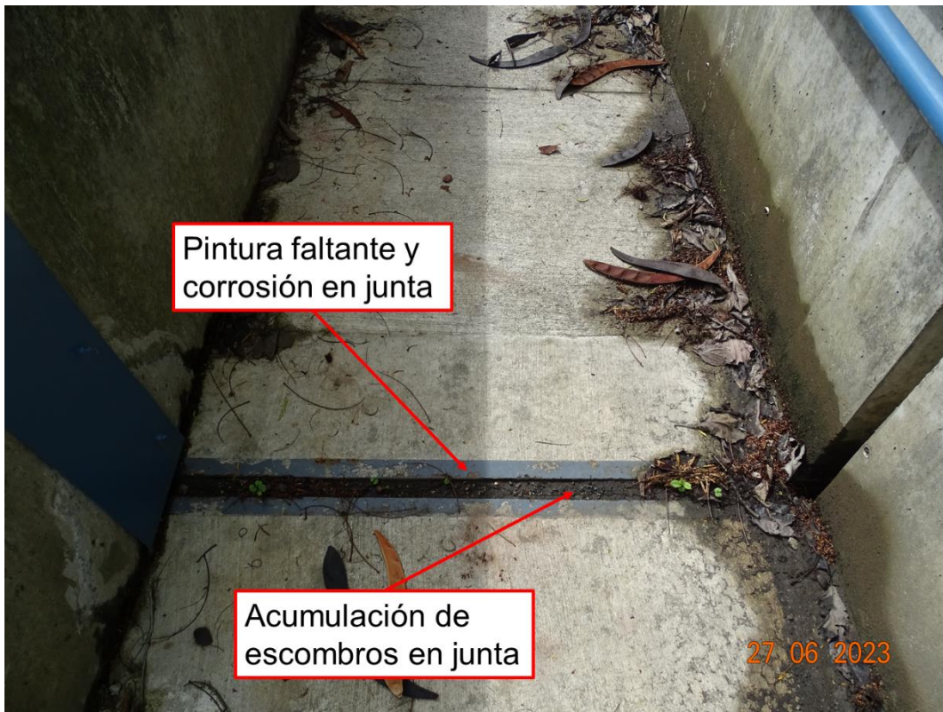
Figura 11. Corrosión y pérdida de pintura en componentes de juntas de expansión, así como acumulación de escombros
