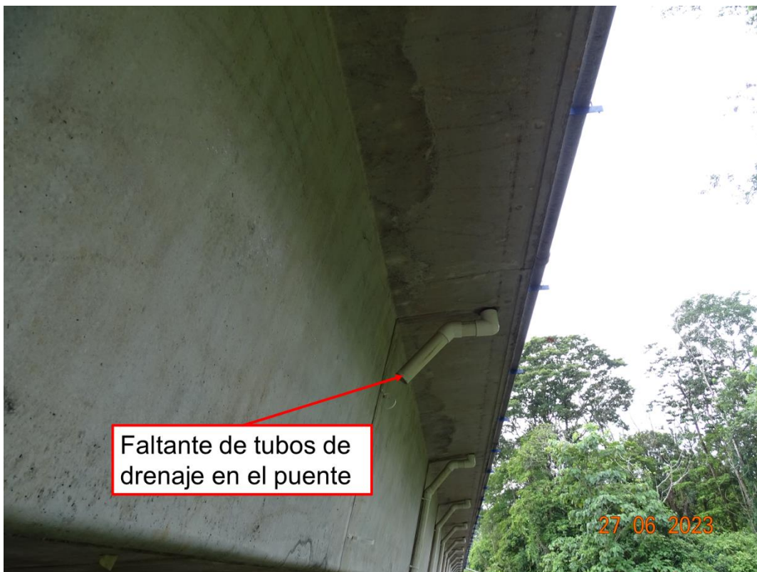
Figura 10. Falta de tubos de drenaje en el sistema de drenaje de salida del puente
