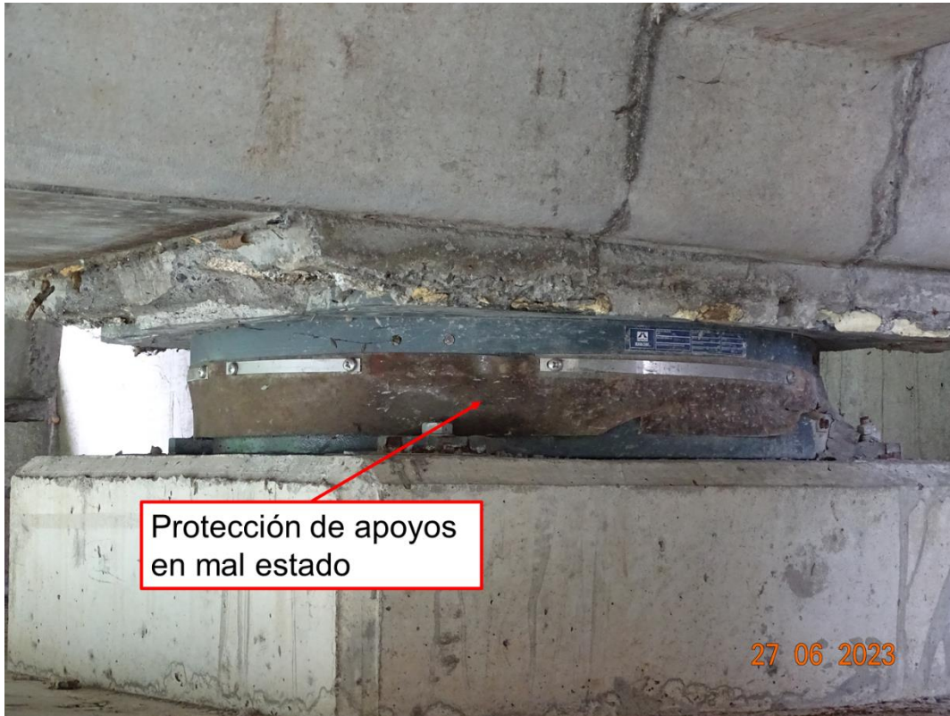
Figura 18. Apoyos con protección contra polvo y escombros deficiente
