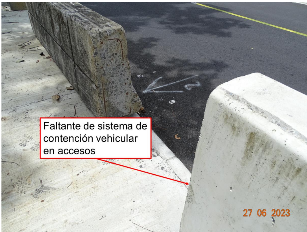
Figura 83. Sistema de contención vehicular faltante en los accesos al puente
