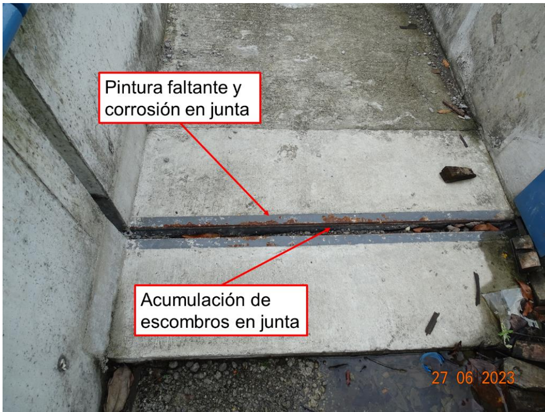
Figura 2. Corrosión y pérdida de pintura en componentes de juntas de expansión, así como acumulación de escombros
