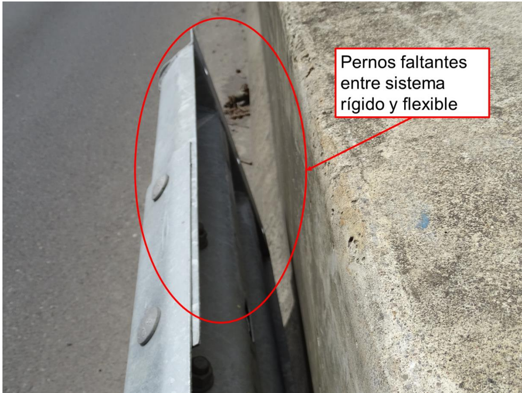
Figura 20. Falta de conexión entre sistemas de contención vehicular rígido y flexible
