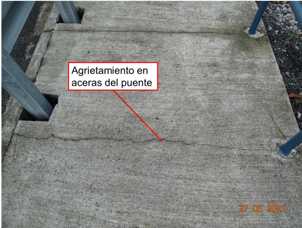
Figura 5. Agrietamiento en las aceras del puente y sus accesos
