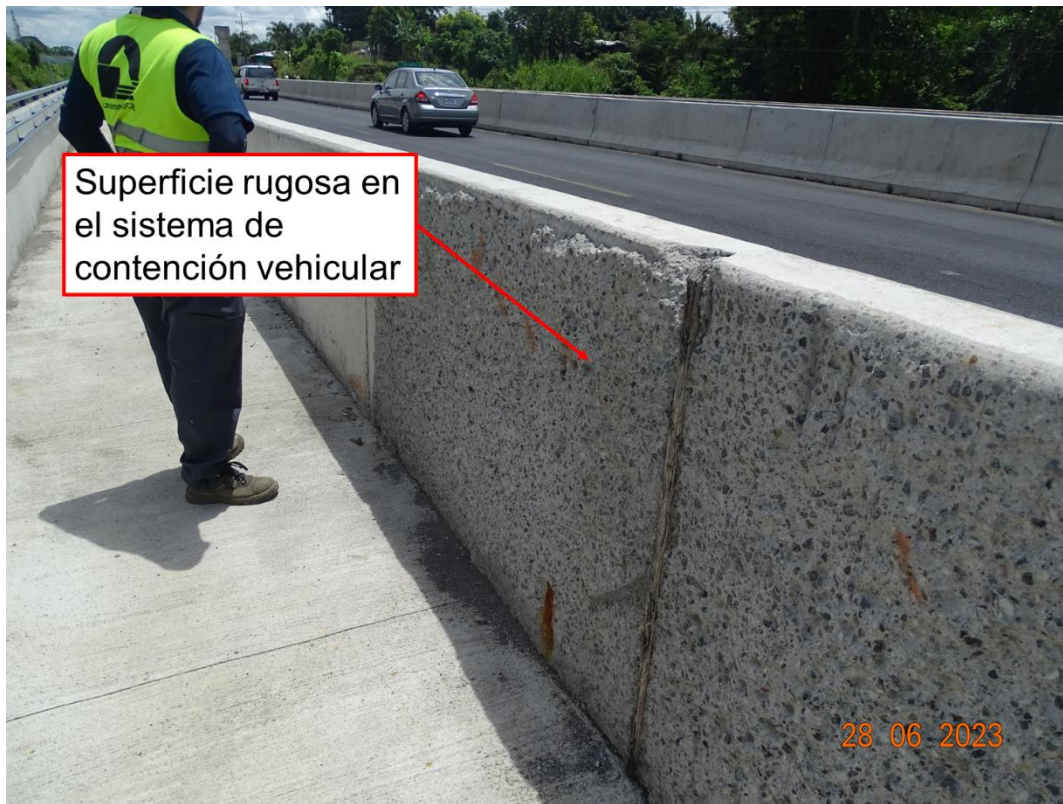
Figura 98. Superficie rugosa en el sistema de contención vehicular de concreto del puente
