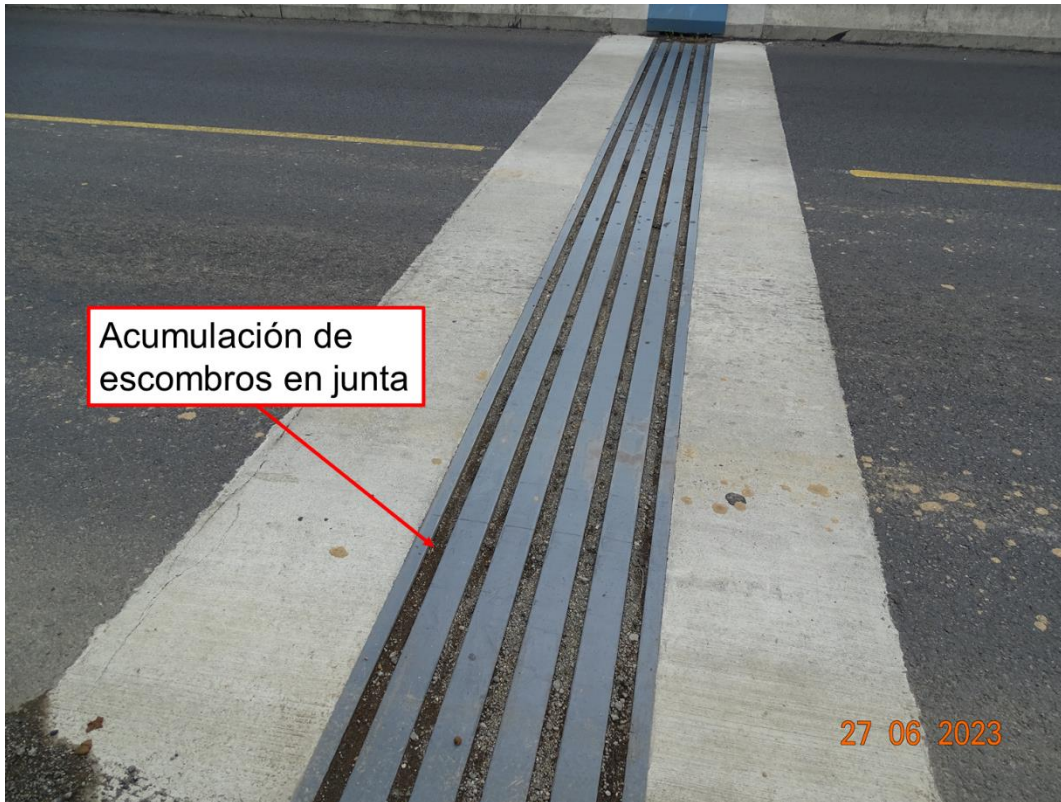
Figura 14. Obstrucción de las juntas de expansión del puente por acumulación de escombros
