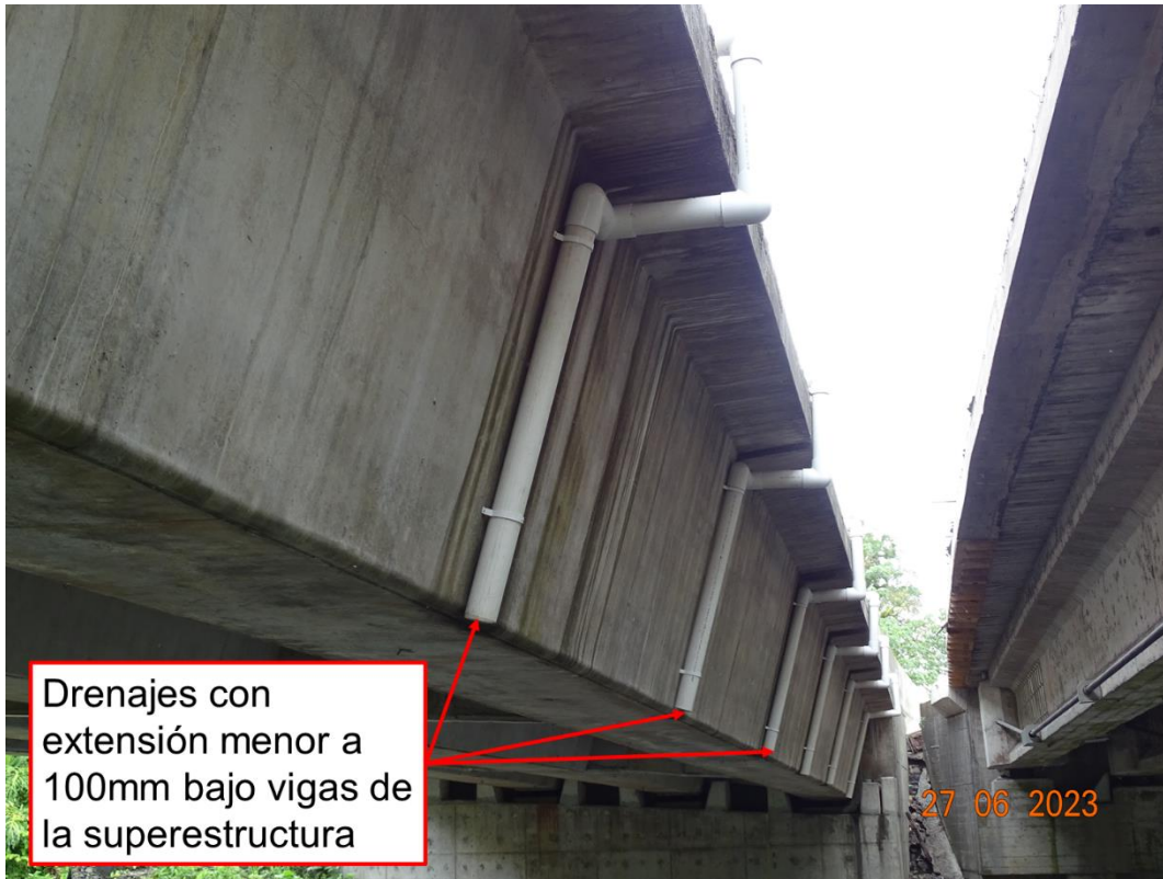
Figura 8. Extensión insuficiente en los tubos de drenaje
