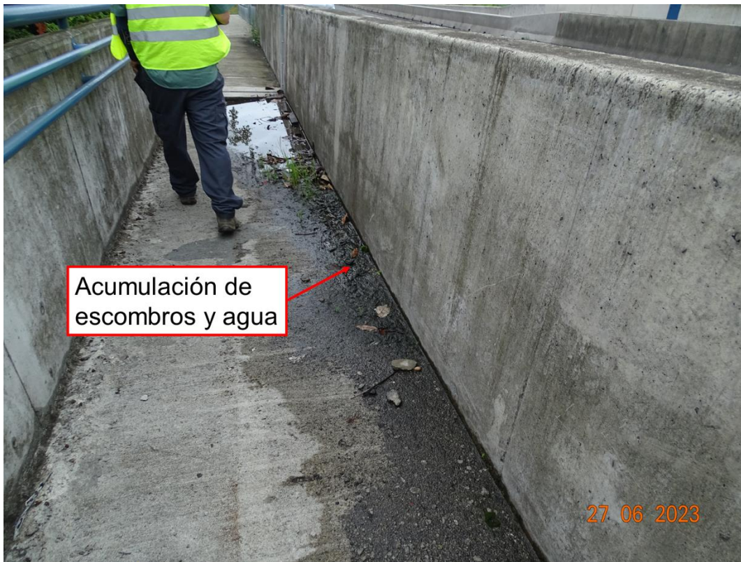
Figura 6. Acumulación de escombros y agua en aceras del puente
