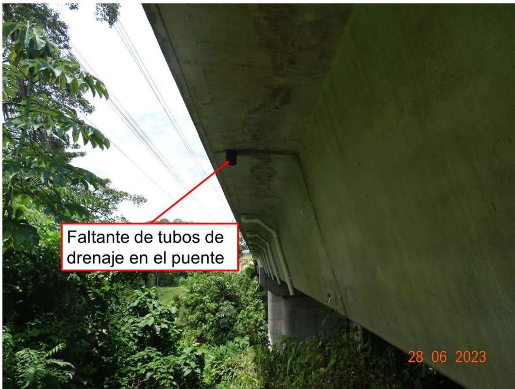
Figura 47. Falta de tubos de drenaje en el sistema de drenaje de salida del puente
