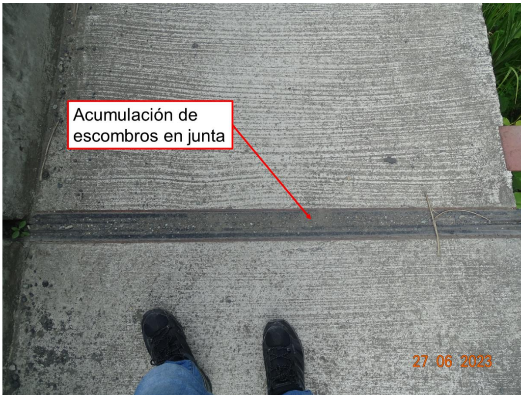
Figura 56. Acumulación de escombros en sello de junta de expansión
