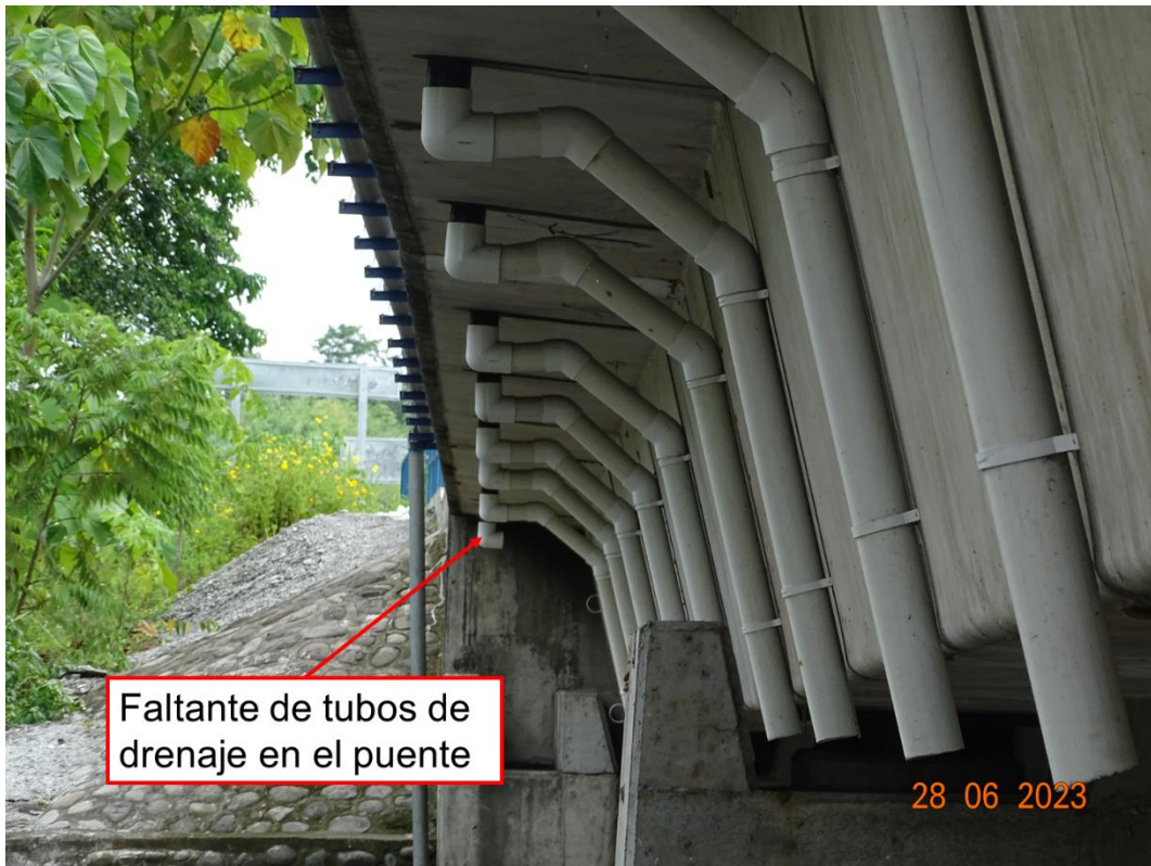
Figura 41. Falta de tubos de drenaje en el sistema de drenaje de salida del puente
