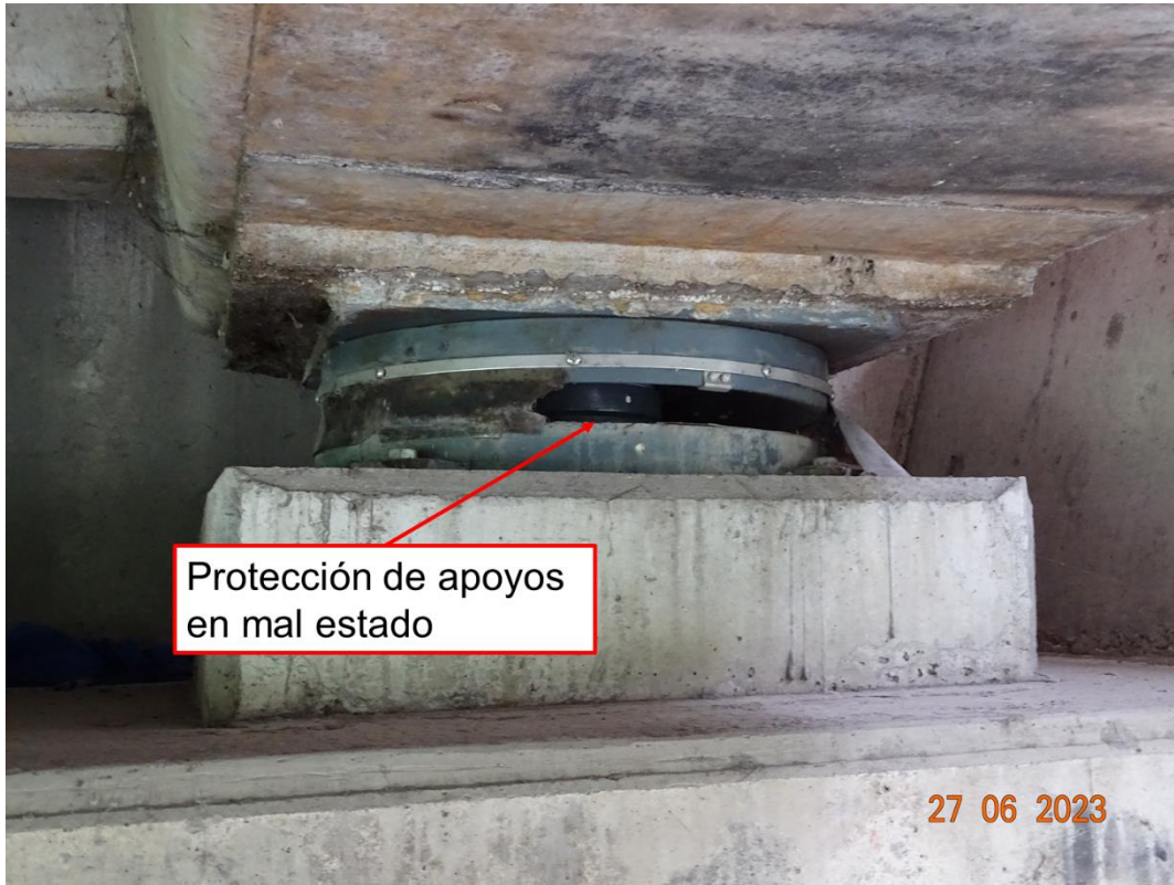
Figura 24. Apoyos de péndulo de fricción con protección en mal estado
