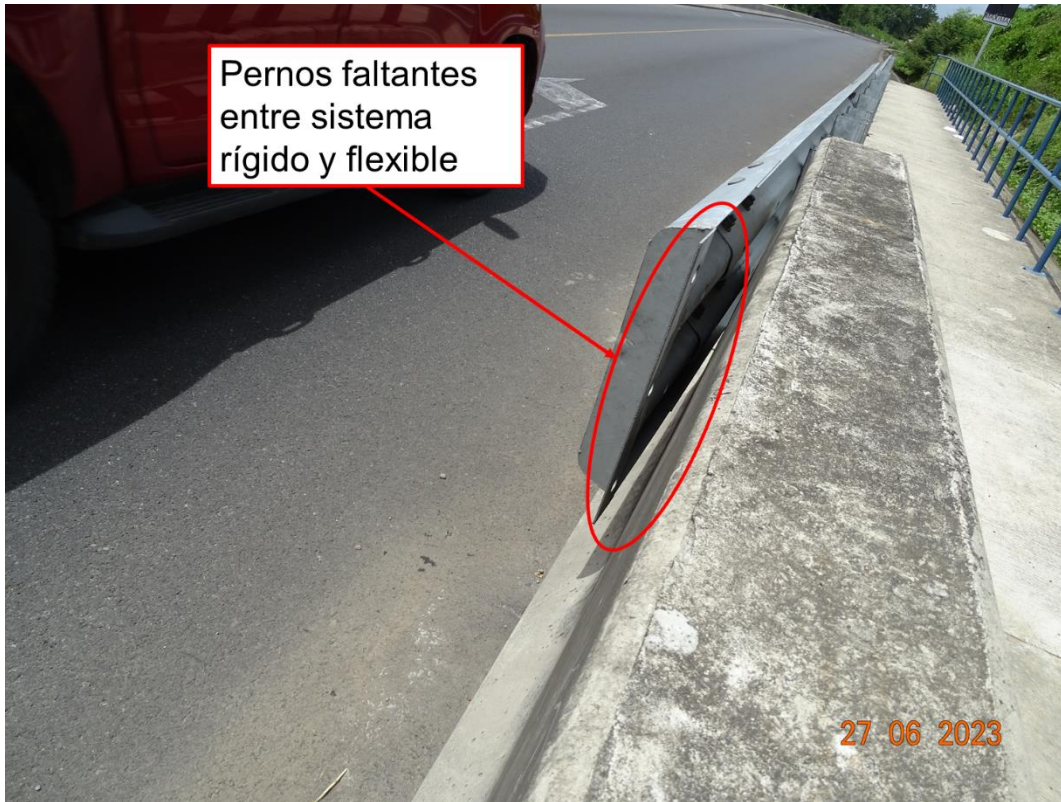
Figura 39. Falta de conexión entre sistemas de contención vehicular rígido y flexible
