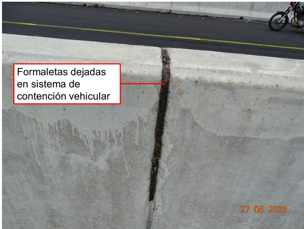
Figura 84. Formaleta no removida en el sistema de contención vehicular del puente.
