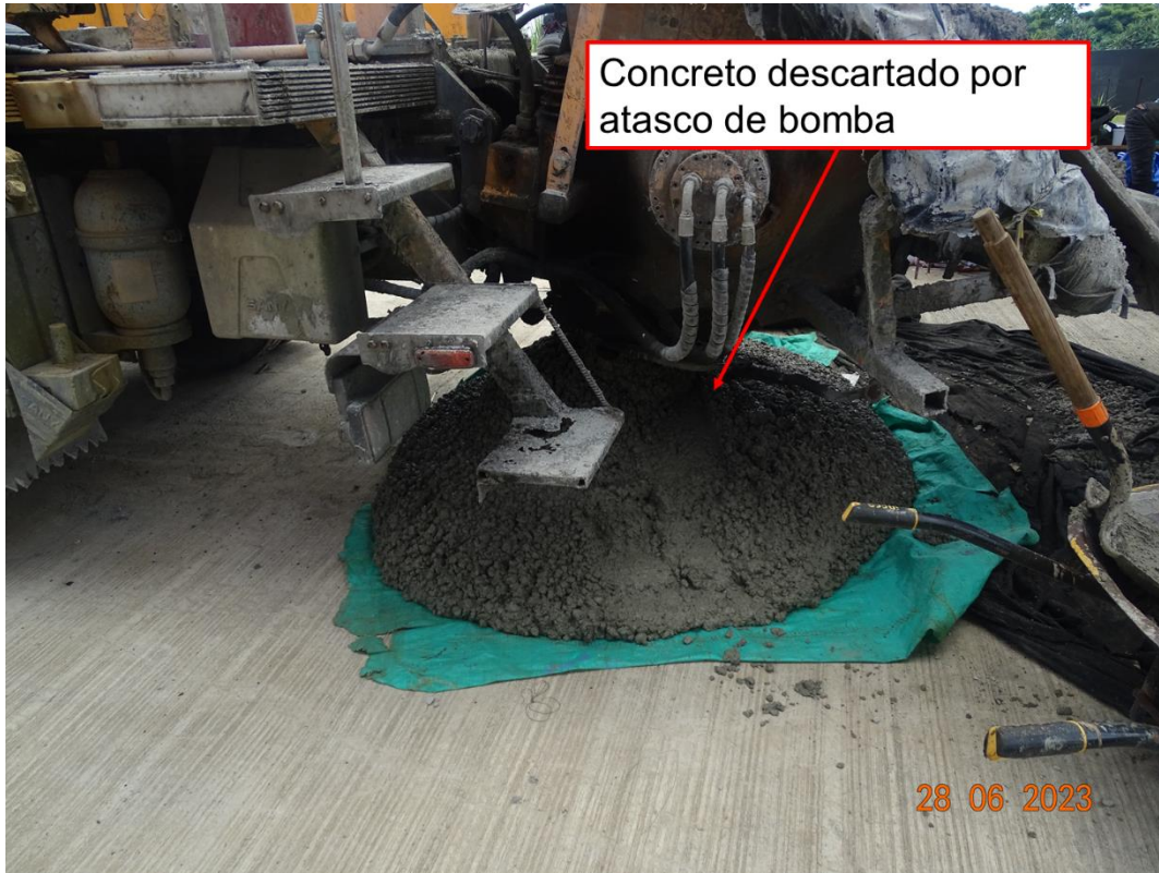
Figura 102. Descarte de concreto de la bomba por atasco
