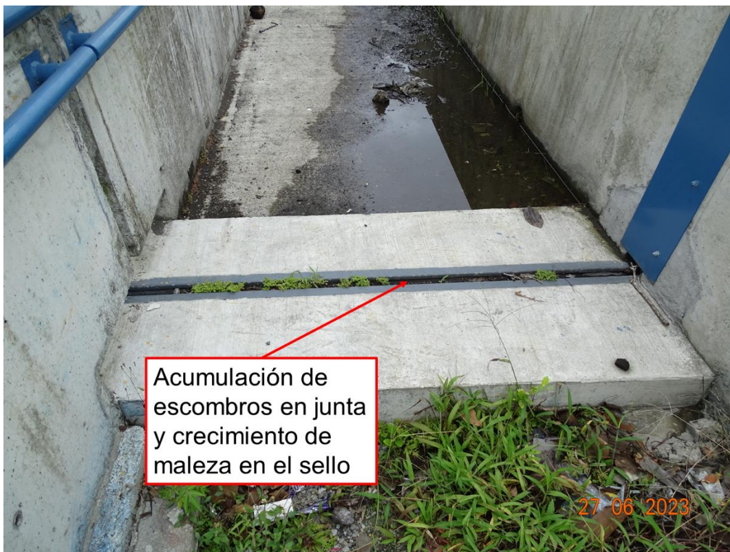
Figura 7. Acumulación de escombros en la junta de expansión
