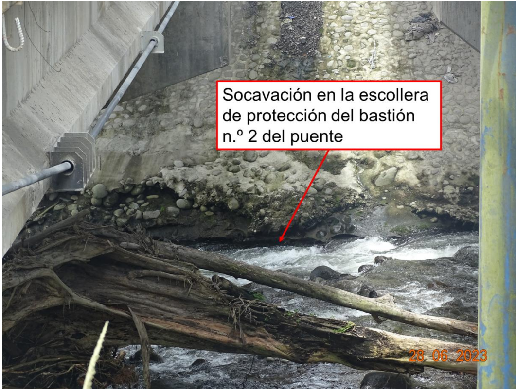
Figura 96. Socavación en la escollera de protección del bastión n.º 2
