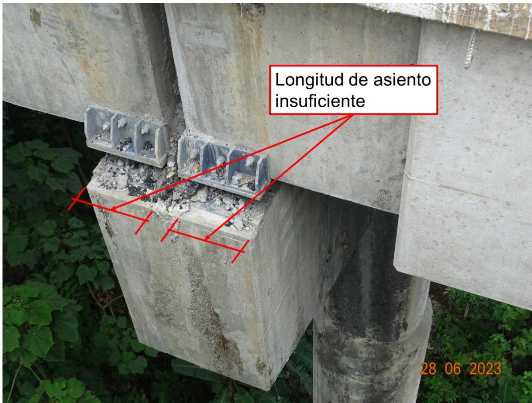
Figura 100. Longitud de asiento insuficiente en pilas del puente sobre el río Destierro LD
