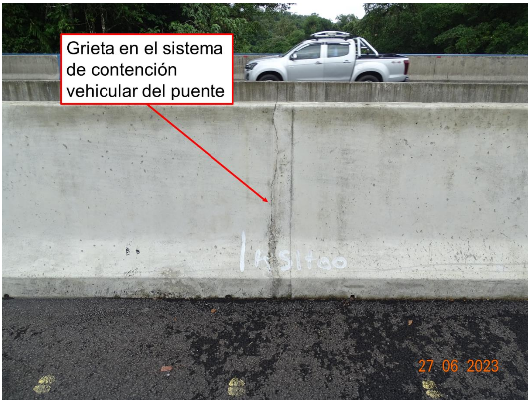
Figura 68. Grieta en el sistema de contención vehicular del puente
