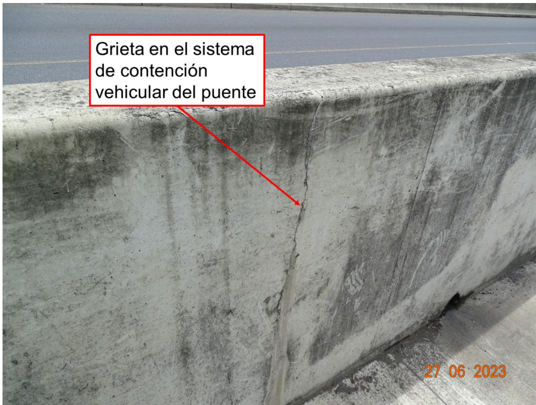
Figura 32. Grieta en el sistema de contención vehicular del puente
