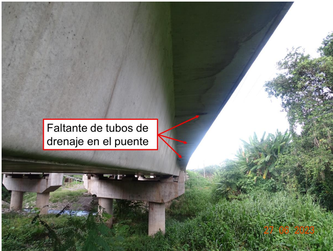
Figura 51. Falta de tubos de drenaje en el sistema de drenaje de salida del puente
