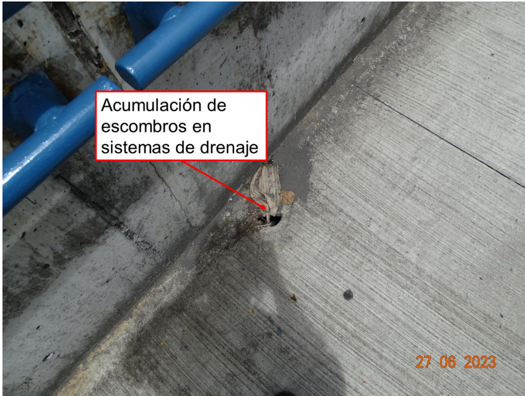
Figura 22. Obstrucción del sistema de drenaje del puente por acumulación de escombros
