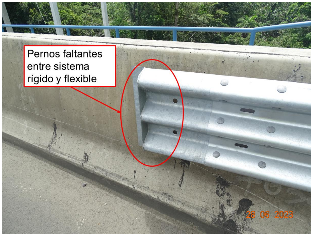
Figura 48. Falta de conexión entre sistemas de contención vehicular rígido y flexible
