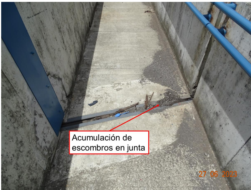
Figura 36. Acumulación de escombros en sello de la junta de expansión
