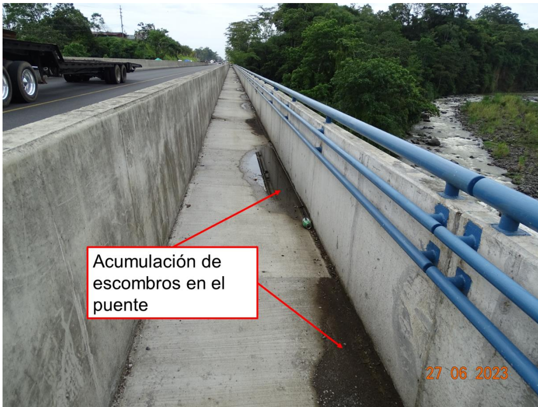
Figura 17. Acumulación de escombros y agua en el borde de la acera
