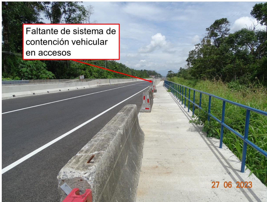
Figura 79. Sistema de contención vehicular faltante en los accesos al puente
