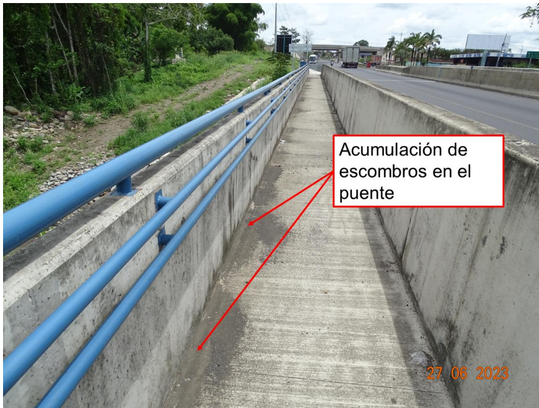
Figura 35. Acumulación de escombros y agua en el borde de la acera
