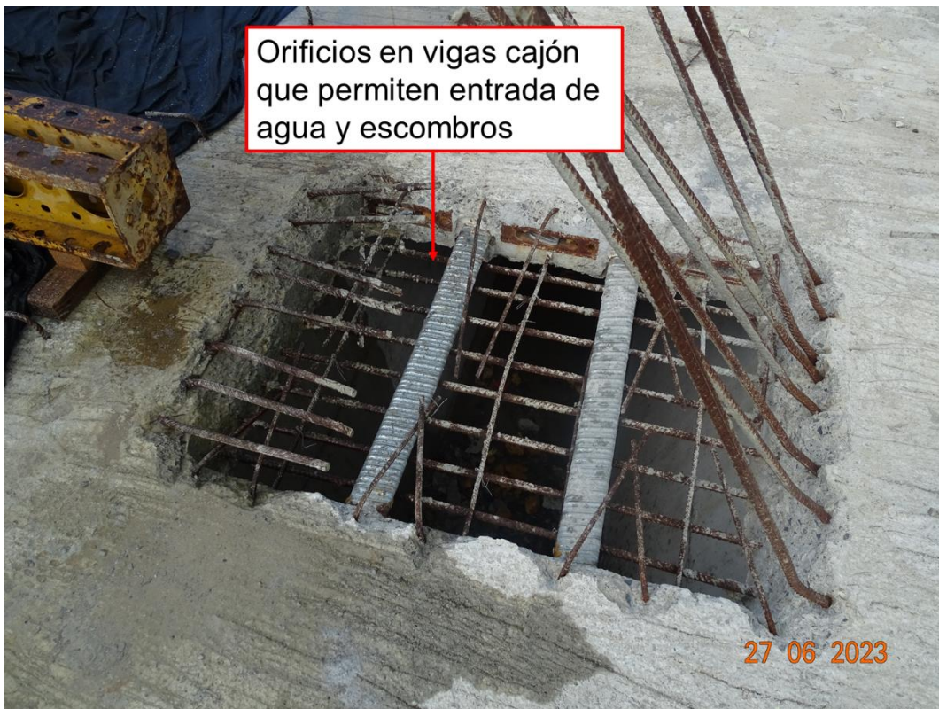
Figura 54. Orificios en vigas cajón que permiten entrada de aguas y escombros en puente sobre río Cuba LI
