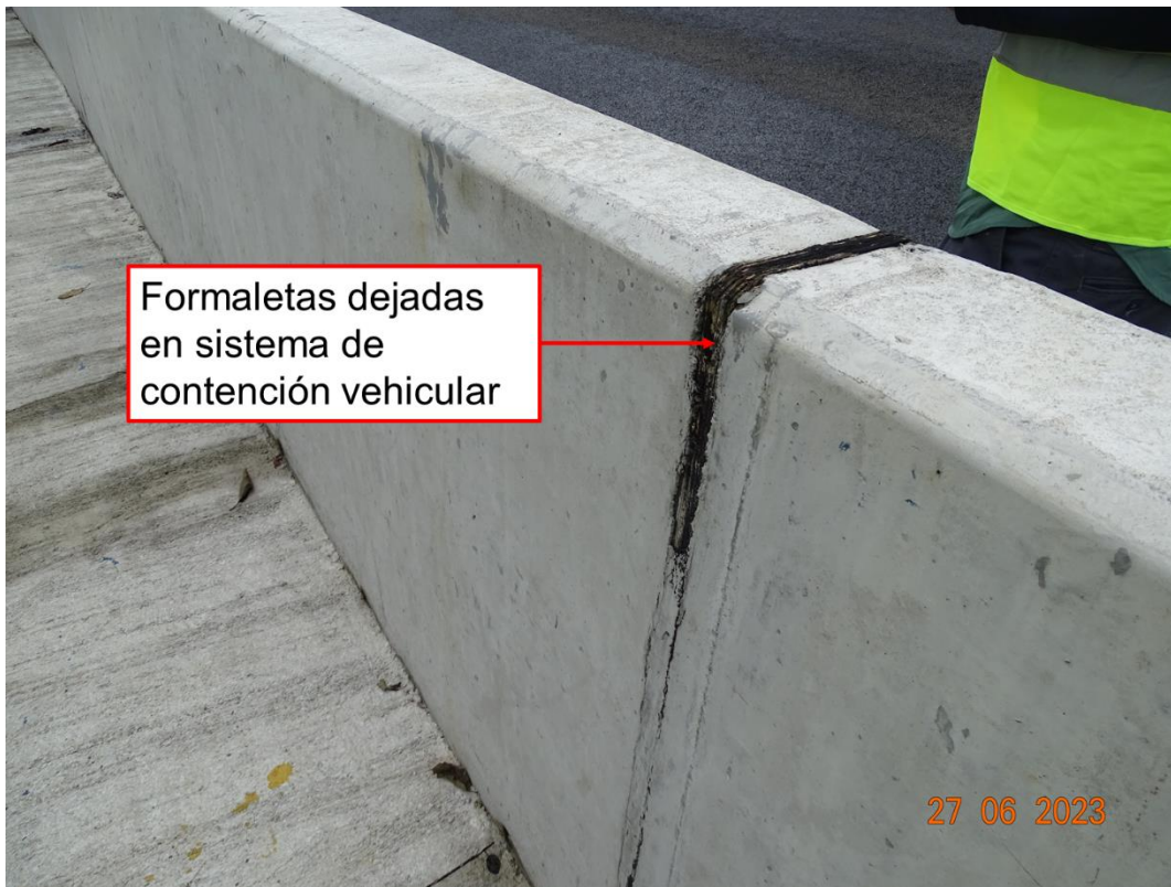
Figura 73. Formaleta no removida en el sistema de contención vehicular del puente.
