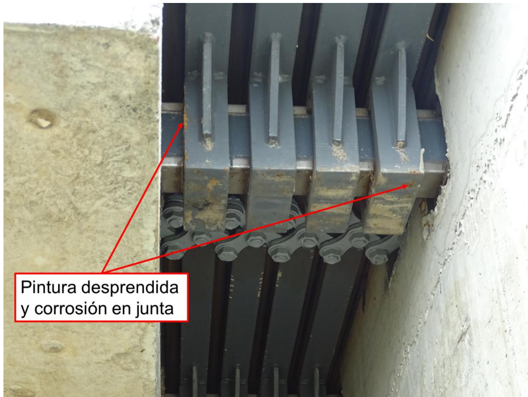
Figura 13. Oxidación y pérdida de pintura en componentes de la junta de expansión
