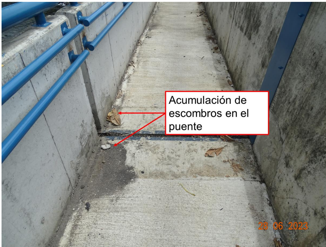
Figura 44. Acumulación de escombros y agua en el borde de la acera
