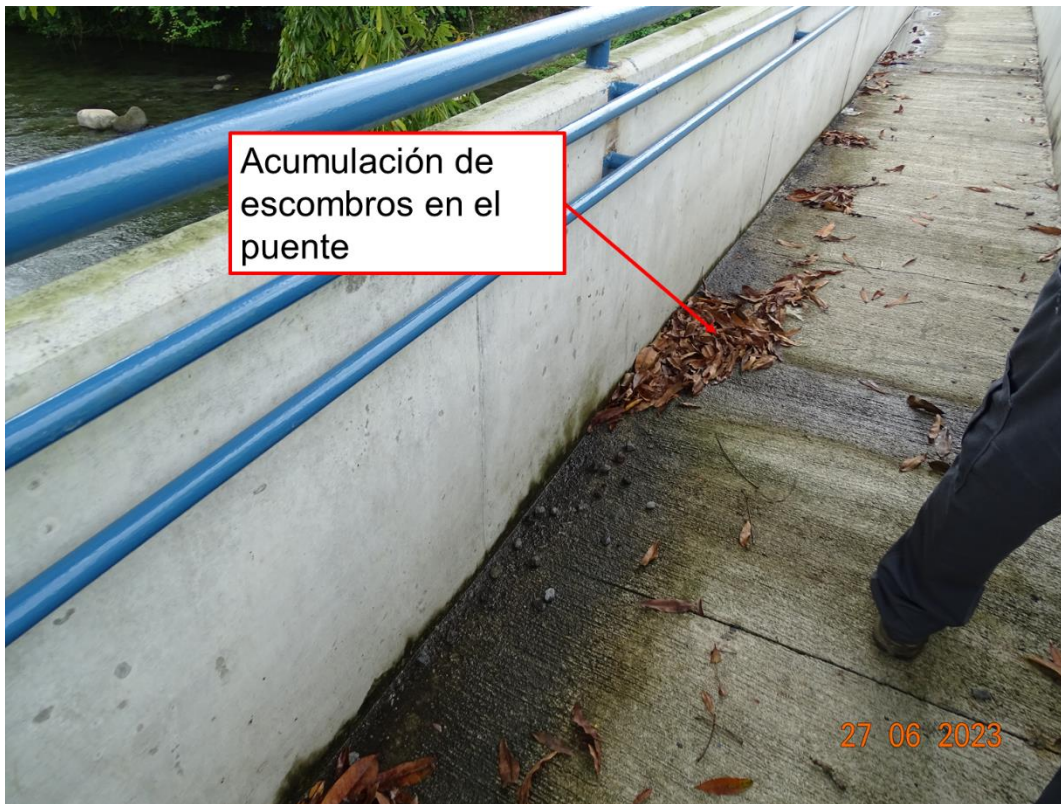
Figura 69. Acumulación de escombros y agua en el borde de la acera
