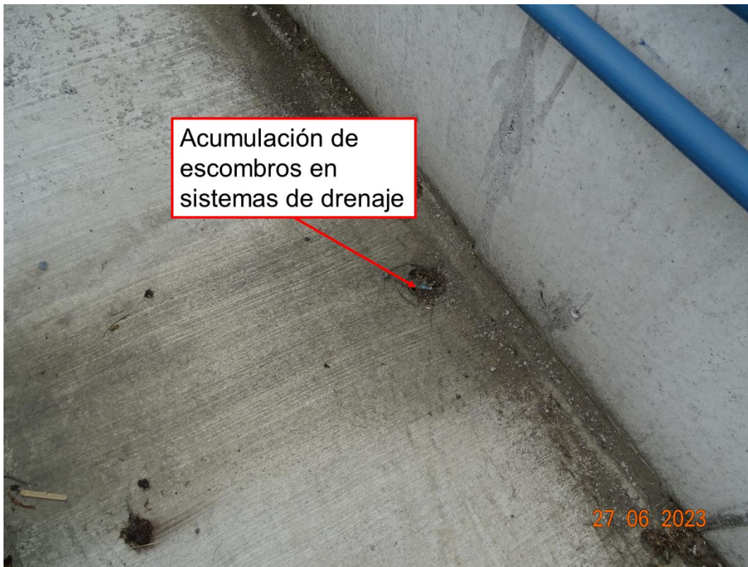
Figura 15. Obstrucción del sistema de drenaje del puente por acumulación de escombros
