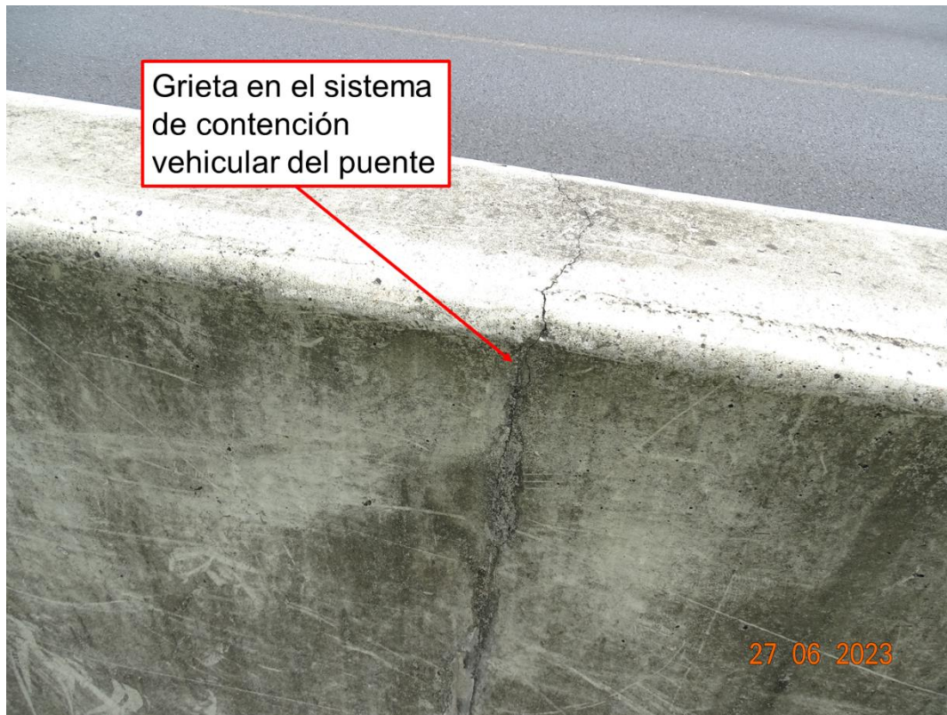
Figura 23. Grieta en el sistema de contención vehicular del puente
