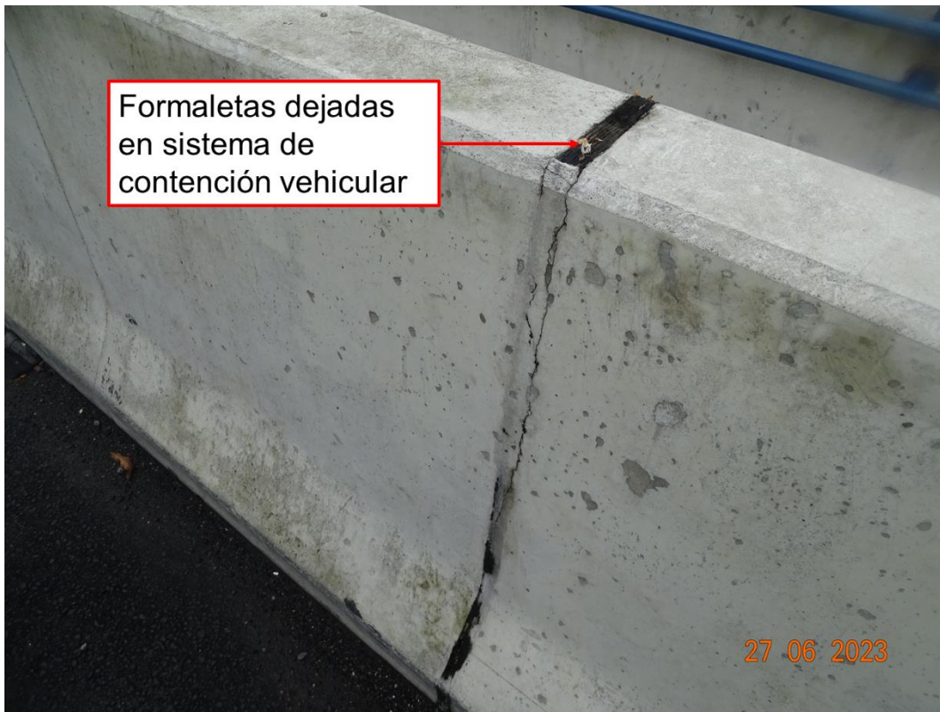
Figura 67. Formaleta no removida en sistema de contención vehicular del puente
