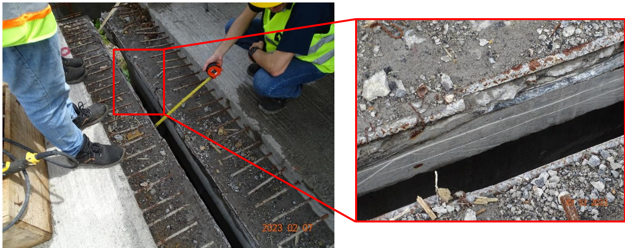
Figura 25. Construcción de la junta de expansión sobre la Pila 2 del puente existente sobre el río Destierro, donde se observa acero de refuerzo transversal expuesto.
