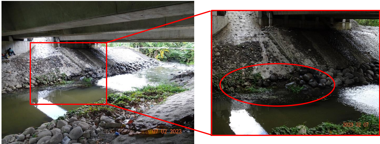
Figura 43. Socavación bajo la punta de las escolleras ligadas con mortero de los bastiones del puente nuevo sobre el río Rojo.
