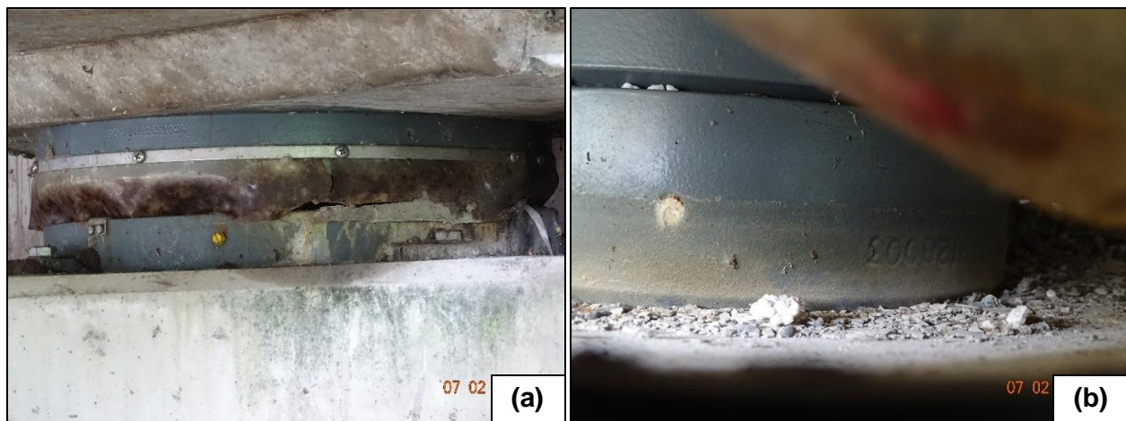
Figura 36. Aisladores sísmicos tipo péndulo de fricción del puente nuevo sobre el río Cuba. (a) Sello de protección roto. (b) Acumulación de suciedad en la parte interna del dispositivo.
