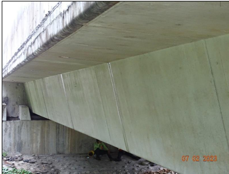
Figura 45. Ausencia de bajantes en el puente nuevo sobre el río Rojo y escurrimiento de agua por el costado de la viga cajón.
