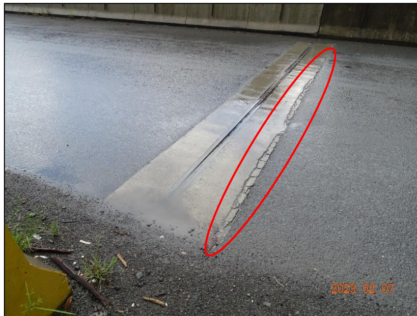
Figura 41. Agrietamiento del concreto en el borde de la junta de expansión del Bastión 1.
