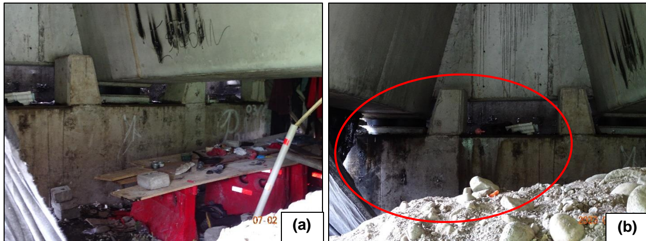
Figura 19. Apoyos elastoméricos y viga cabezal del Bastión 1 del puente nuevo sobre el río Destierro. (a) Posible presencia de personas viviendo bajo el puente. (b) Acumulación de sedimentos y humedad.
