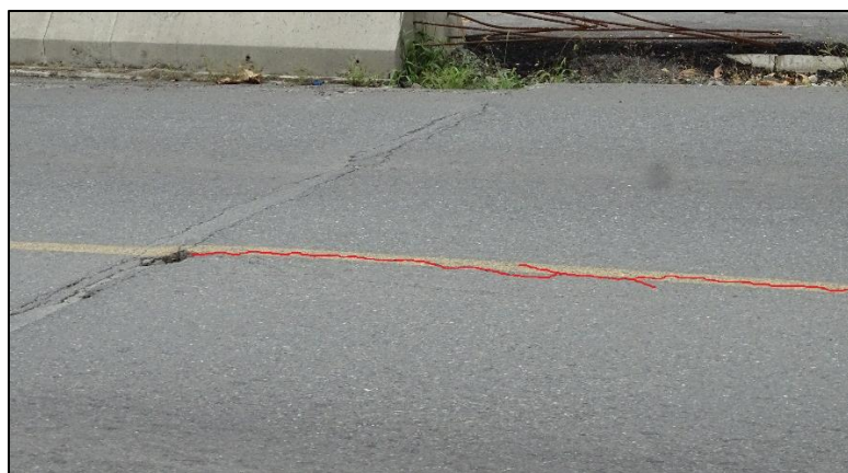
Figura 31. Agrietamiento de la carpeta asfáltica a lo largo de la junta intermedia entre módulos de la losa de aproximación del Acceso 1 del puente nuevo sobre la Quebrada Calderón.
