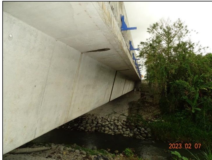
Figura 48. Ausencia de bajantes en el puente nuevo sobre el río Toro y escurrimiento de agua por el costado de la viga cajón.
