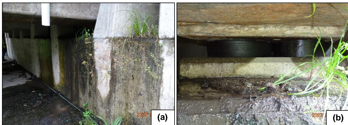
Figura 11. Acumulación de sedimentos y humedad en la viga cabezal del bastión del puente nuevo sobre el río Guacimito, alrededor de los apoyos elastoméricos.
