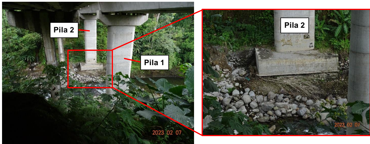
Figura 21. Placa de cimentación parcialmente expuesta en la Pila 2 del puente nuevo sobre el río Destierro.
