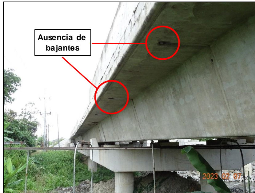
Figura 40. Ausencia de bajantes en el puente nuevo sobre el río Cuba y escurrimiento de agua por el costado de la viga cajón.
