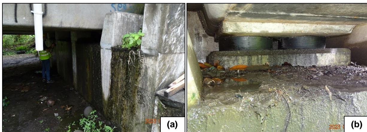
Figura 5. Acumulación de sedimentos y humedad en la viga cabezal del bastión del puente nuevo sobre el río Guácimo, alrededor de los apoyos elastoméricos.
