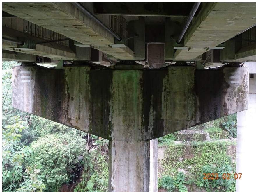
Figura 24. Viga cabezal de la Pila 1 del puente existente sobre el río Destierro, donde no se observa la ampliación indicada en la memoria de cálculo de CHEC (2020).
