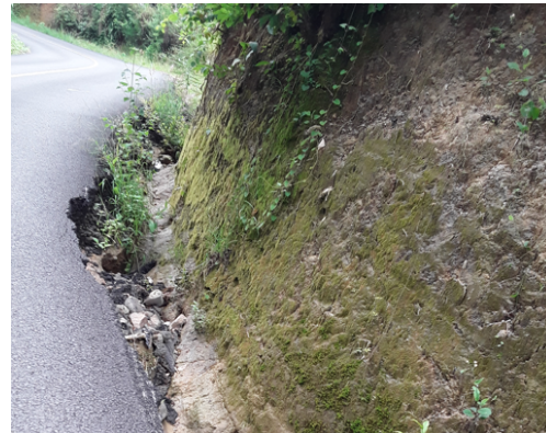
Socavación de estructura de pavimento
