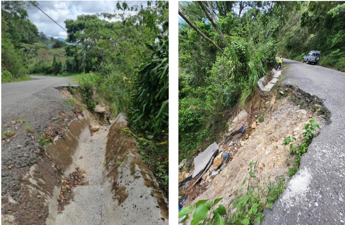
Figura 11. Punto 7, Ruta Nacional No.206. Deslizamiento al costado de la carretera.
