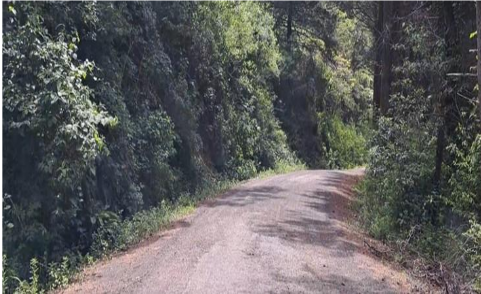
Figura 18. Ruta Nacional No.206. Sección 10230, sector de montaña. Se observa el deterioro en la carpeta asfáltica, la cual en algunos tramos ya es inexistente.
