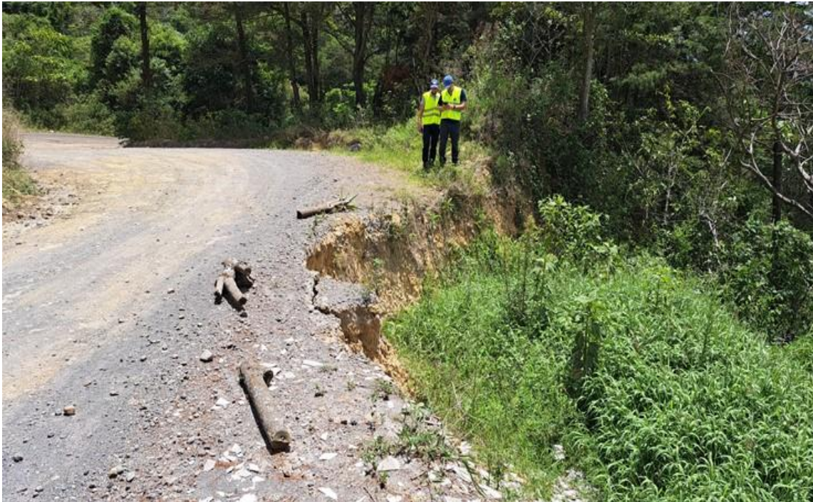
Figura 12. Punto 8, Ruta Nacional No.206. Deslizamiento al costado izquierdo de la vía, en sentido San Miguel – Corralillo.
