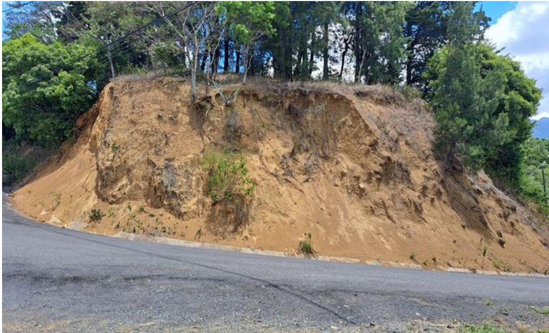
Figura 8. Punto 4, Ruta Nacional No.206. Deslizamientos y erosión en talud al costado derecho de la vía (sentido San Miguel – Corralillo).
