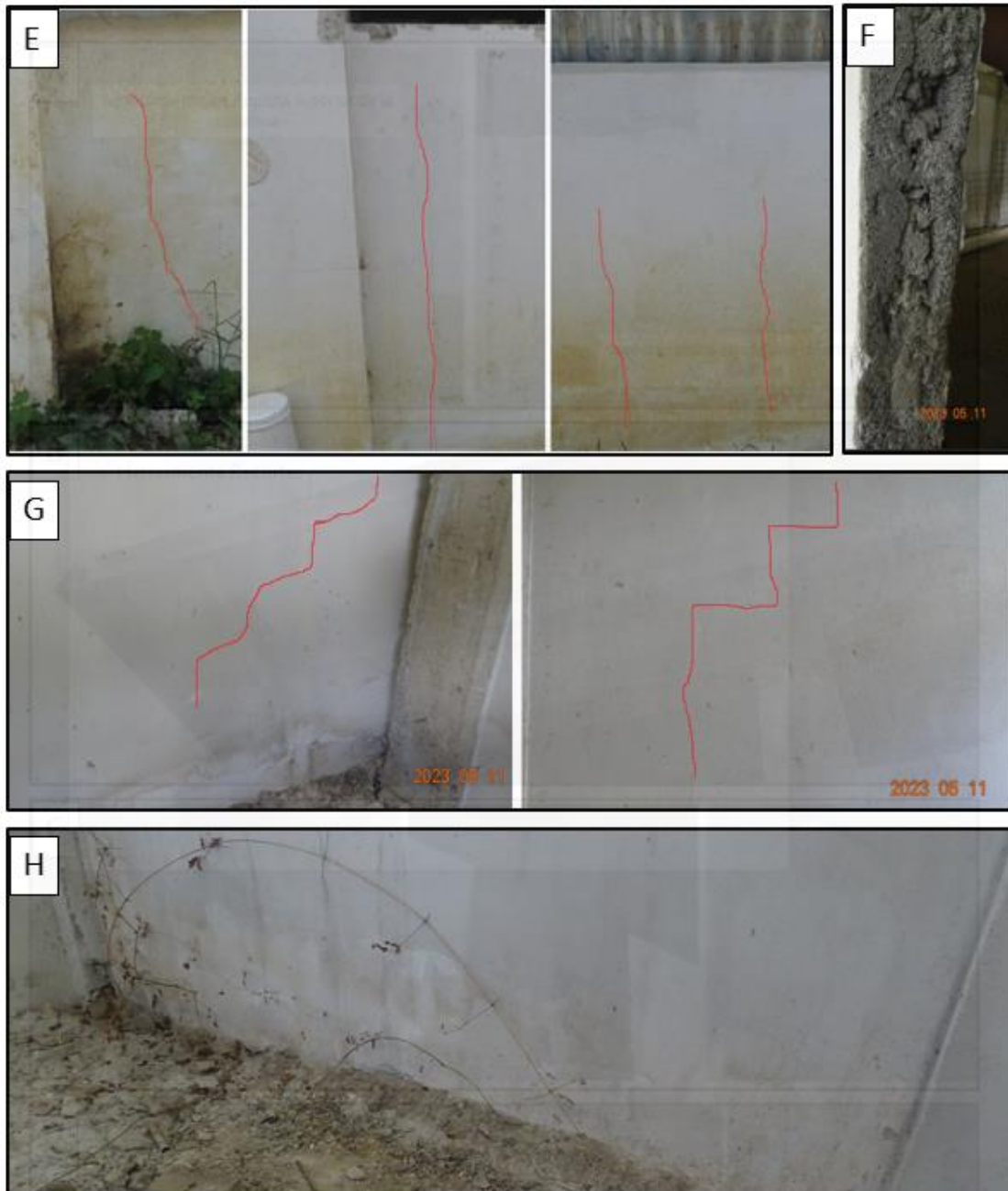
Figura 19. Deficiencia constructiva de (E) Agrietamiento vertical en muros de mampostería, (F) Corte inadecuado de bloques de mampostería, (G) Falla por retracción del mortero en muro de mampostería, y (H) Filtraciones en borde inferior de los muros de mampostería, del edificio de aulas no.3 del CTP José María Zeledón Brenes
