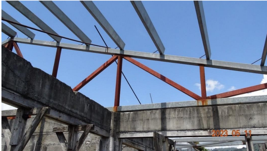
Figura 12. Vista interior del grado de avance constructivo del segundo nivel del edificio de aulas No.4 del CTP José María Zeledón Brenes
