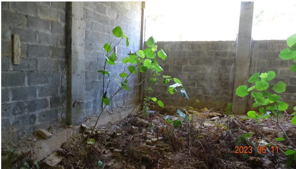
Figura 11. Vista interior del grado de avance constructivo del primer nivel del edificio de aulas No.4 del CTP José María Zeledón Brenes
