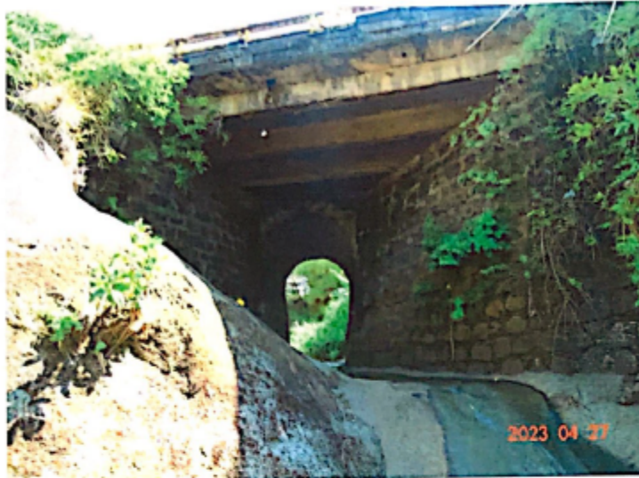
Figura 7. Vista de la salida de aguas abajo del puente. Se aprecia la magnitud de los muros que protegen los rellenos de aproximación al puente y la obstrucción que generan en el cauce.
