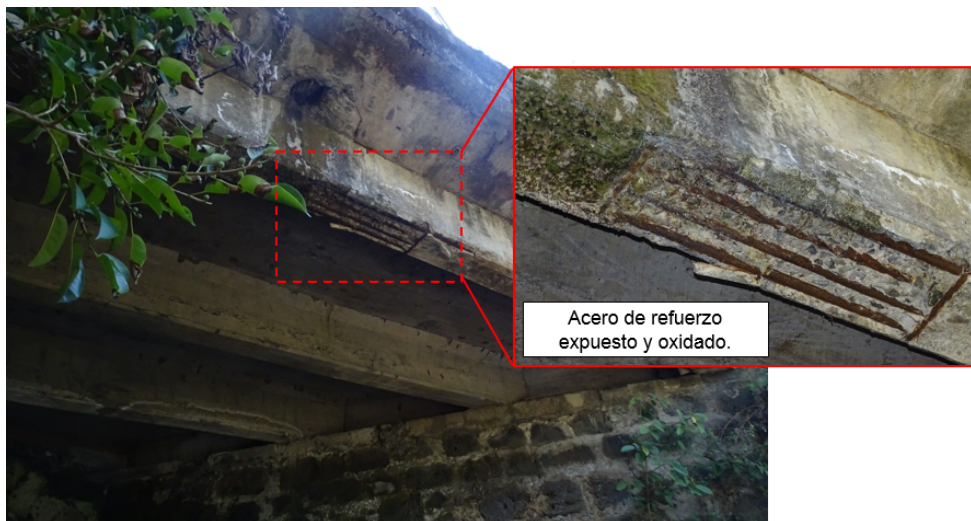
Figura 5. Presencia de acero de refuerzo expuesto en superestructura de vigas de concreto del puente del río Pirro Fuente: LanammeUCR, 2023.
