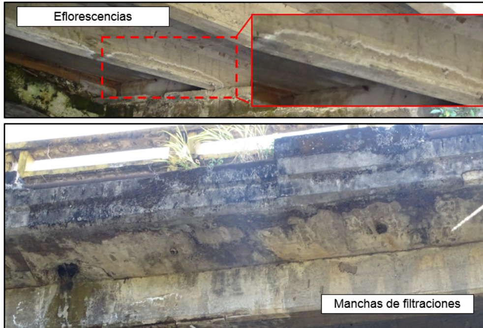
Figura 6. Presencia de eflorescencias en superestructura de vigas de concreto del puente del rio Pirro Fuente: LanammeUCR, 2023.
