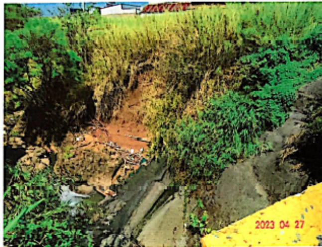
Figura 5. Vista del cauce en dirección aguas abajo, se observan señales de erosión de la margen derecha del cauce inmediatamente aguas abajo del final de la protección de concreto lanzada. El lecho del cauce se observa rocosa.
