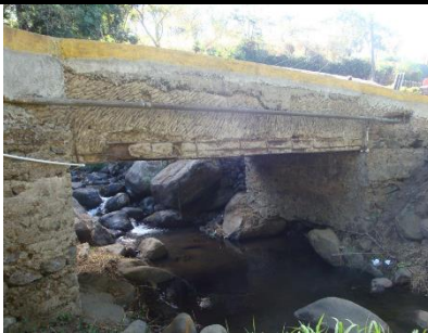
Nota: Notar socavación en bastión n.º 2. Tomado del SAEP (CONAVI, 2015b)
