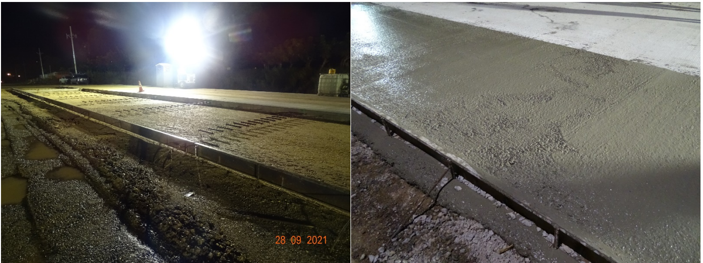
Figura 42. Espacio entre los moldes de formaleta y la superficie de apoyo y filtración de concreto en los trabajos de colocación manual de concreto para pavimento
