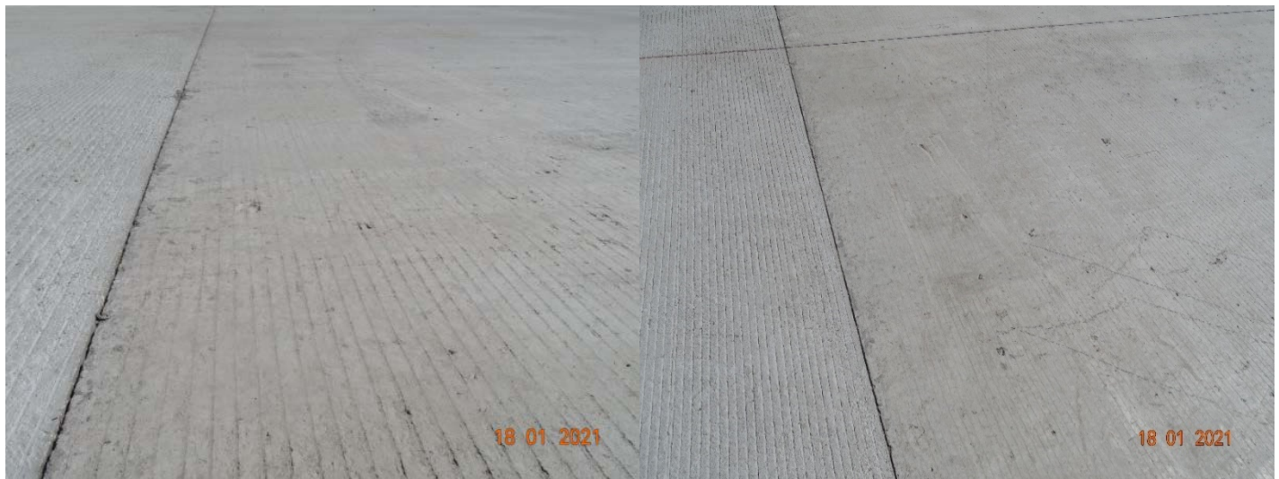
Figura 43. Texturizado deficiente en algunas losas de la superficie de rodamiento en las cercanías del río San Miguel. Estacionamiento: 160+000. Fecha de las fotografías: 18/01/2021
