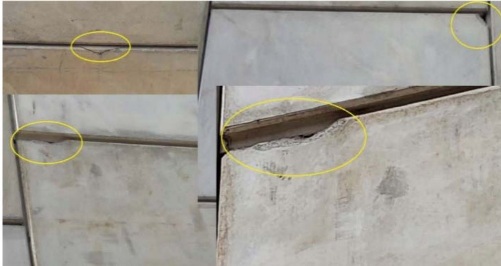
Figura 80. Deterioros observados en los paneles de concreto de los muros de relleno reforzado en el paso a desnivel San Miguel. Fecha de las fotografías: 31/01/2022
