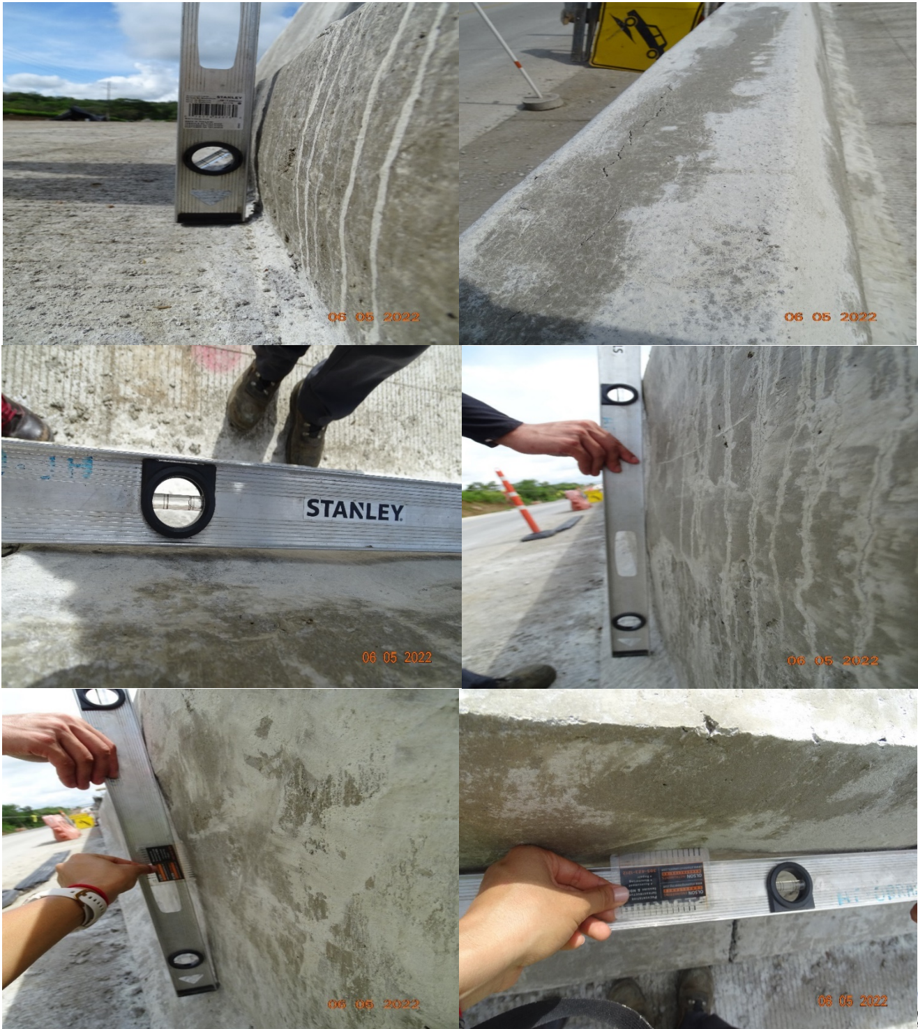
Figura 100. Acabado irregular en las barreras de contención construidas el 5 de mayo de 2022
