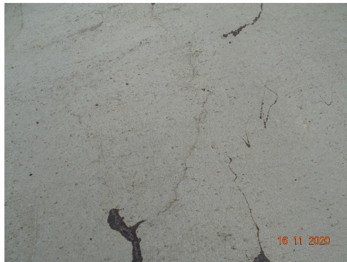
Figura 70. Propagación de los agrietamientos en el tablero del puente aguas abajo sobre el río Salitral. Fecha de la fotografía: 16/11/2020
