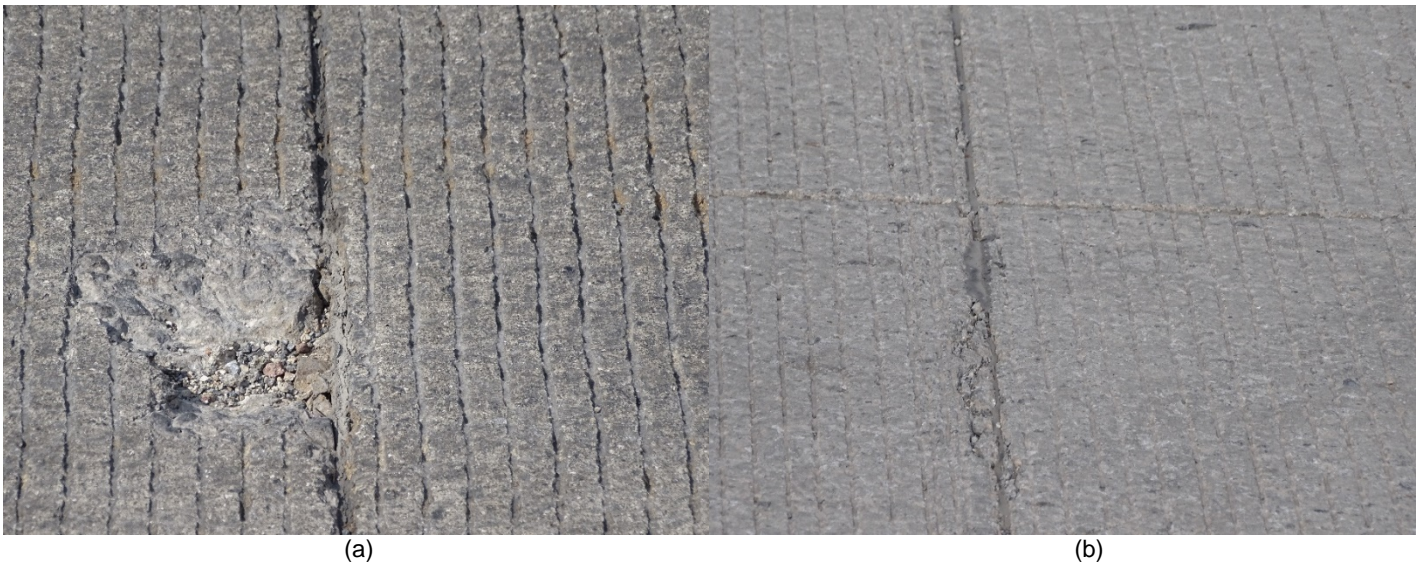
Figura 58. Fractura de junta. Estacionamiento: (a) 156+404, carril externo, lado izquierdo (b) 158+316, carril interno, lado derecho. Fecha de las fotografías: 19/04/2022
