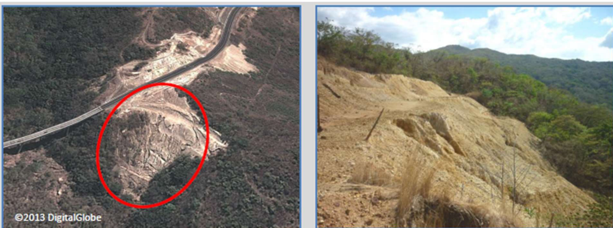
Figura 1. Condición observada en talud de relleno del estacionamiento 48+000 en el año 2013 (Fuente: Informe LM-PI-UGERVN-007-2013)
