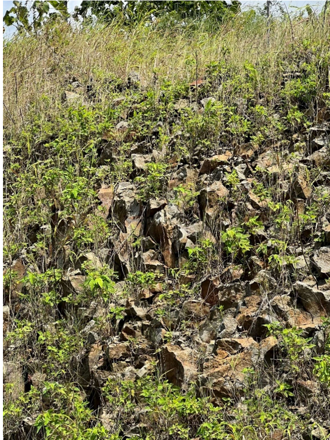
Figura 13. Condición del macizo rocoso observado en las proximidades del km 44+300 de la Ruta Nacional 27
