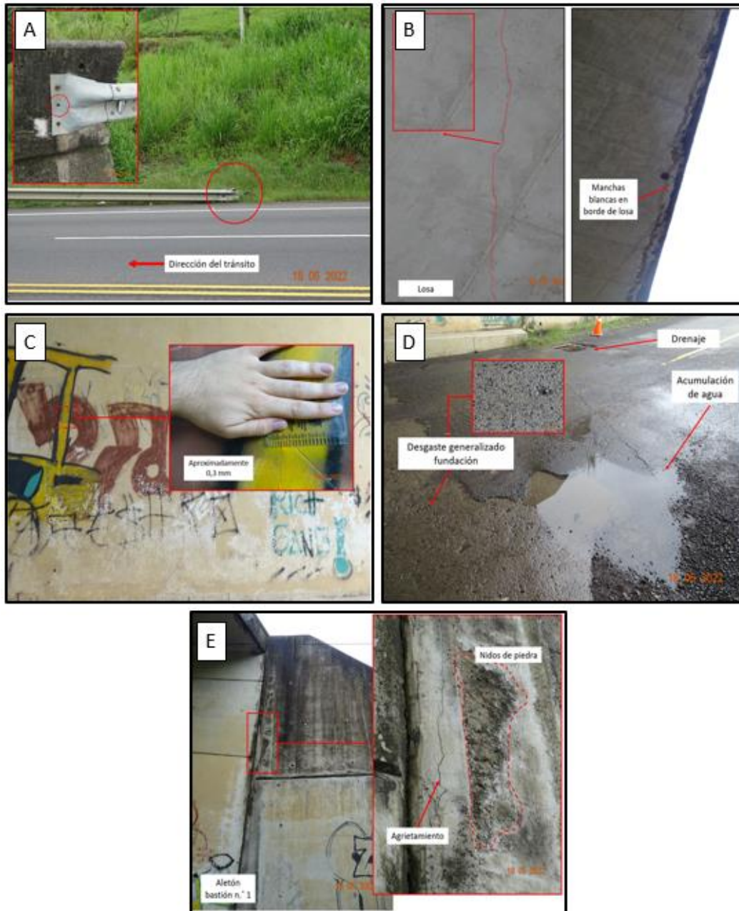
Figura 5.21. (A) Deficiencias en sistema de contención vehicular de los accesos, (B) Deficiencias en elementos principales de la superestructura, (C) Deficiencias en cuerpo de bastiones, (D) Deficiencias en fundaciones, y (E) Deficiencias en aletones
