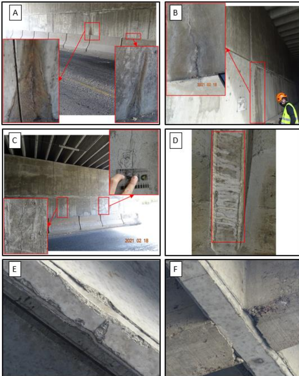
Figura 5.17. (A, B y C) Deficiencias en obras de retención no integrales, (D y E) Deficiencias en elementos principales de la superestructura, y (F) Deficiencias en elementos secundarios de la superestructura
