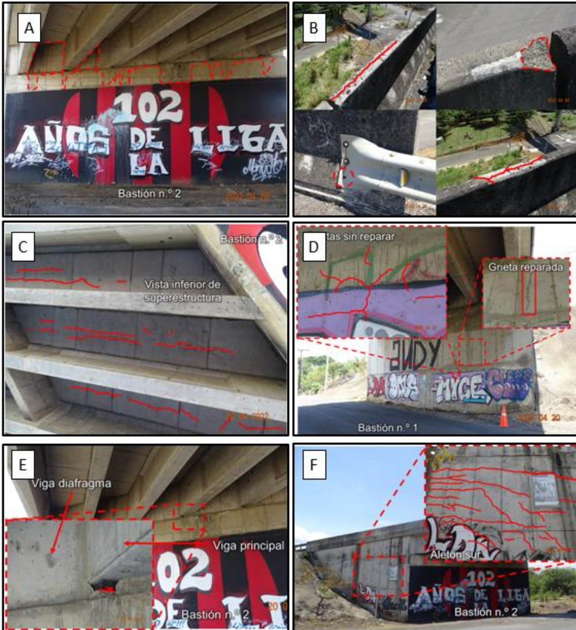
Figura 5.26. (A) Deficiencias en junta de expansión, (B) Deficiencias en sistema de contención vehicular de los accesos, (C) Deficiencias en tablero de la superestructura, (D) Deficiencias en cuerpo del bastión, y (E) Deficiencias en apoyos
