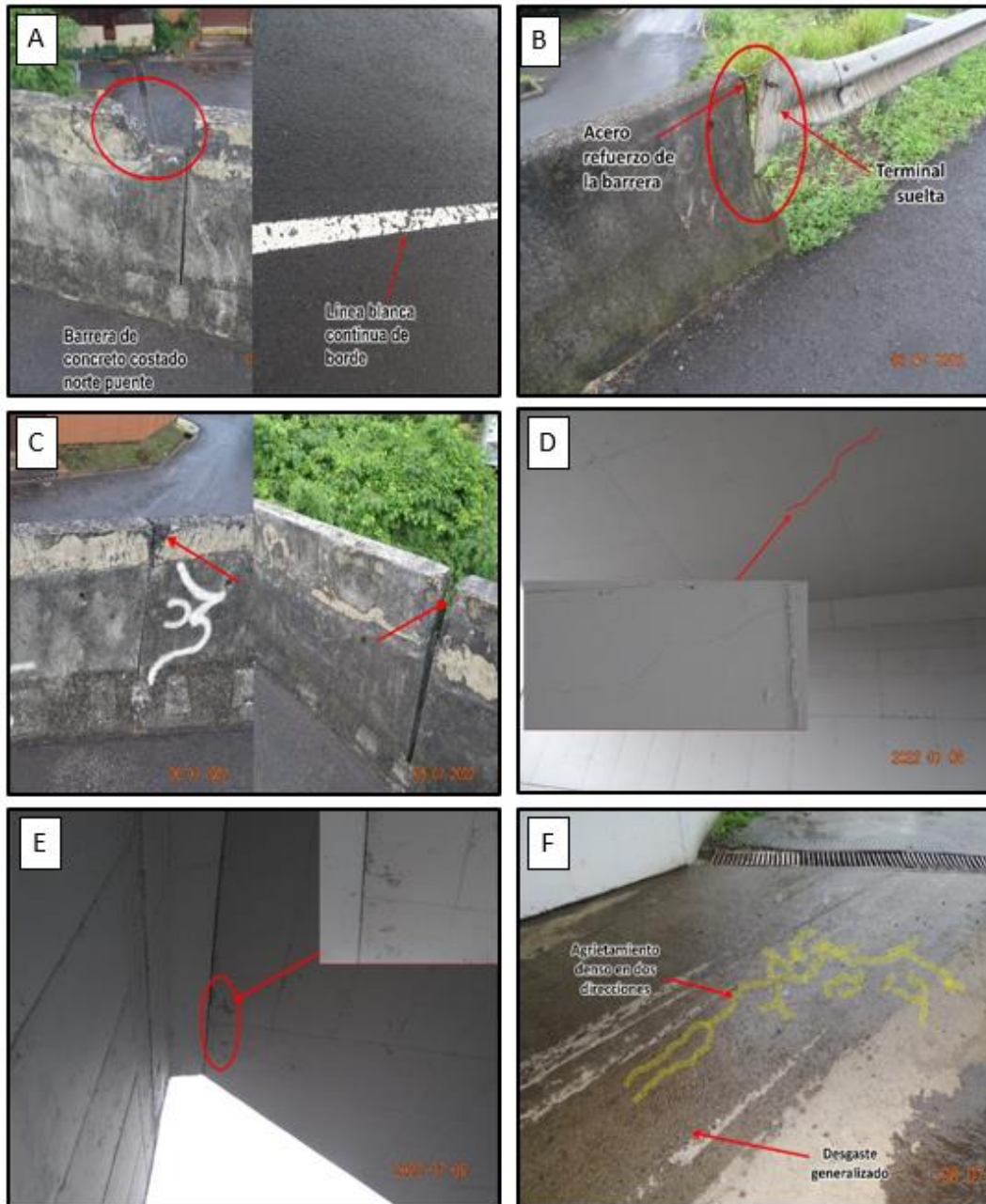
Figura 5.36. (A) Deficiencias en sistema de contención vehicular del puente, (B y C) Deficiencias en sistema de contención vehicular de los accesos, (D y E) Deficiencias en elementos principales de la superestructura, y (f) Deficiencias en fundaciones
