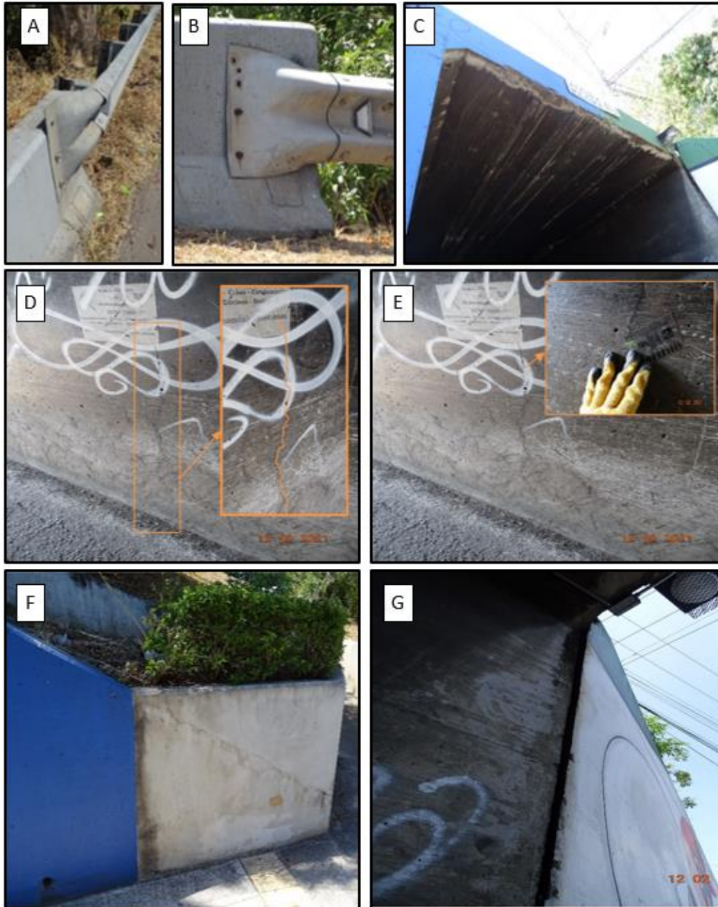
Figura 5.12. (A y B) Deficiencias en sistema de contención vehicular de los accesos, (C) Deficiencias en elementos principales de la superestructura, (D y E) Deficiencias en cuerpo de bastiones, y (F y G) Deficiencias en alerones
