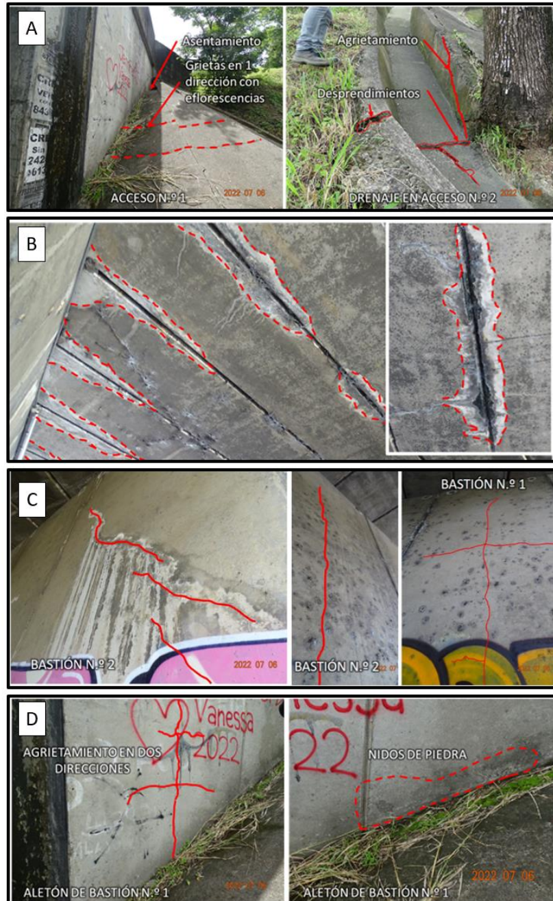
Figura 5.38. (A) Deficiencias en obras de retención no integrales, (B) Deficiencias en elementos principales de la superestructura, (C) Deficiencias en cuerpo de bastiones, y (D) Deficiencias en aletones
