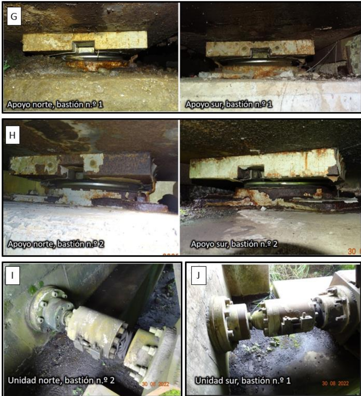
Figura 5.24. (G y H) Deficiencias en apoyos, y (I y J) Deficiencias en sistema de protección sísmica
