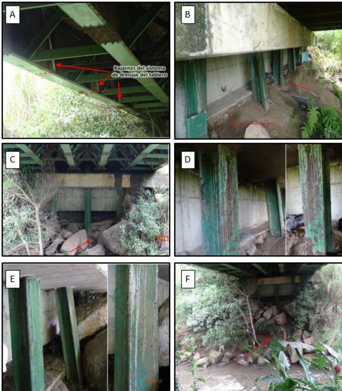
Figura 5.23. (A) Deficiencias en sistema de salida del drenaje del tablero, (B, C, D y E) Deficiencias en cuerpo de bastiones, y (F) Deficiencias en sistemas de protección hidráulica
