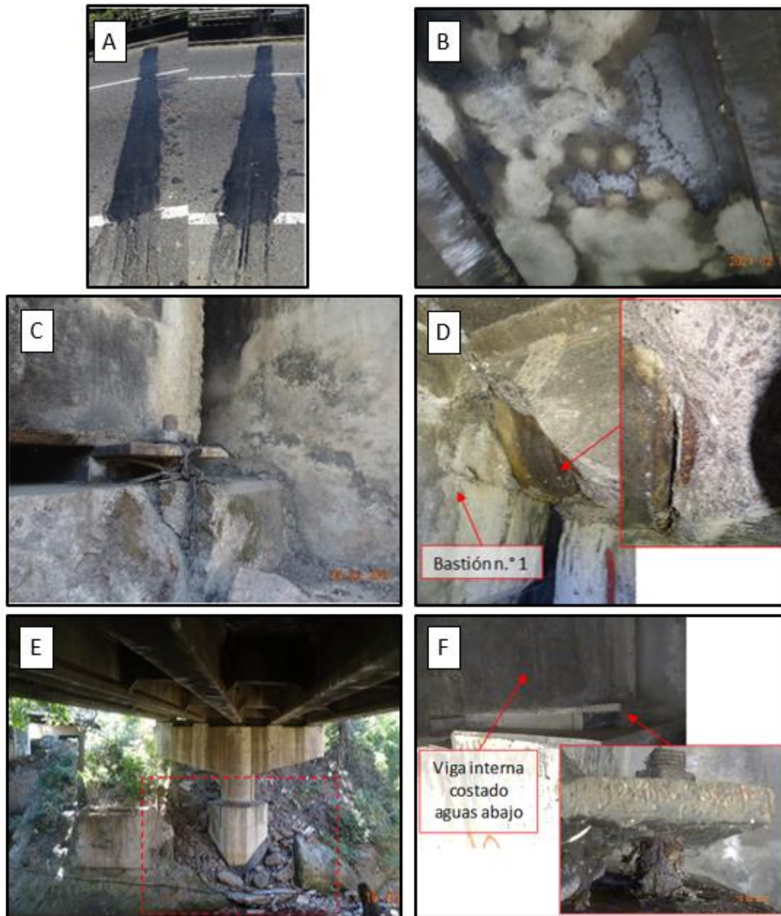
Figura 5.9. (A) Deficiencias en junta de expansión, (B y D) Deficiencias en tablero de la superestructura, (C, D y E) Deficiencias en cuerpo de pilas y bastiones, y (F) Deficiencias en apoyos
