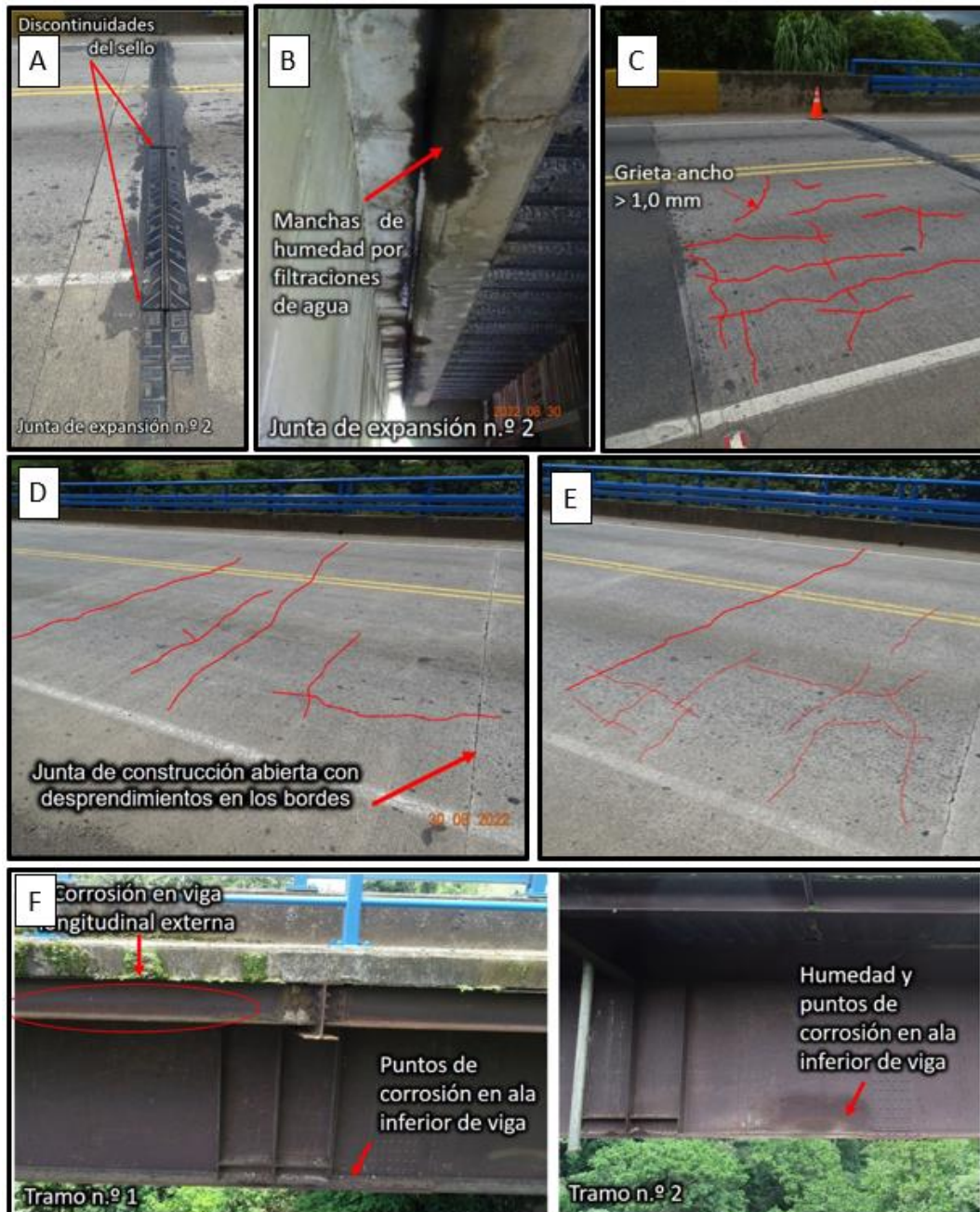
Figura 5.24. (A y B) Deficiencias en junta de expansión, (C) Deficiencias en losa de aproximación, (D y E) Deficiencias en tablero de la superestructura, (F) Deficiencias en elementos principales de la superestructura
