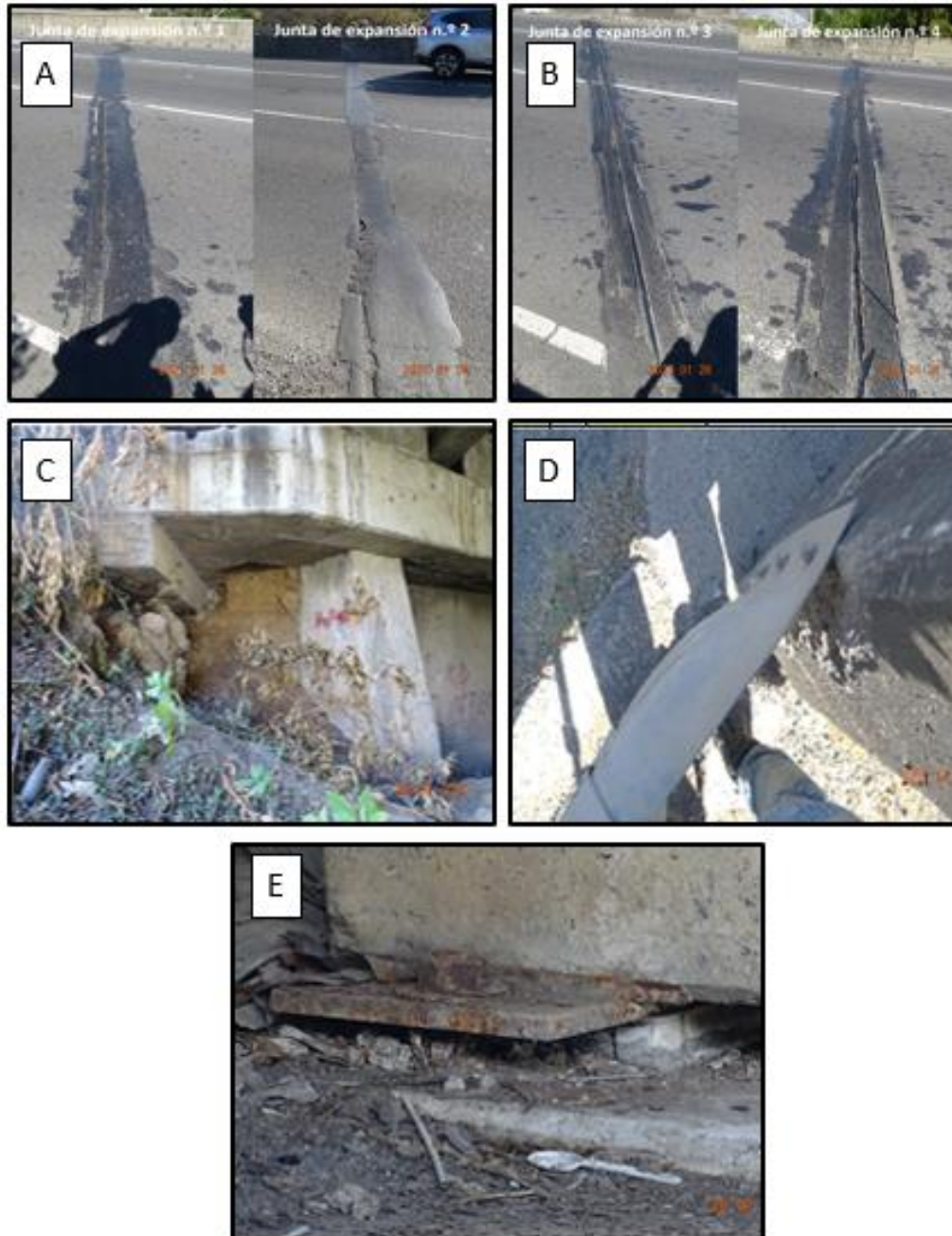
Figura 5.4. (A y B) Deficiencias en junta de expansión, (C) Deficiencias en sistema de drenaje de los accesos y bordillo, (D) Deficiencias en sistema de contención vehicular de los accesos, y (E) Deficiencias en apoyos
