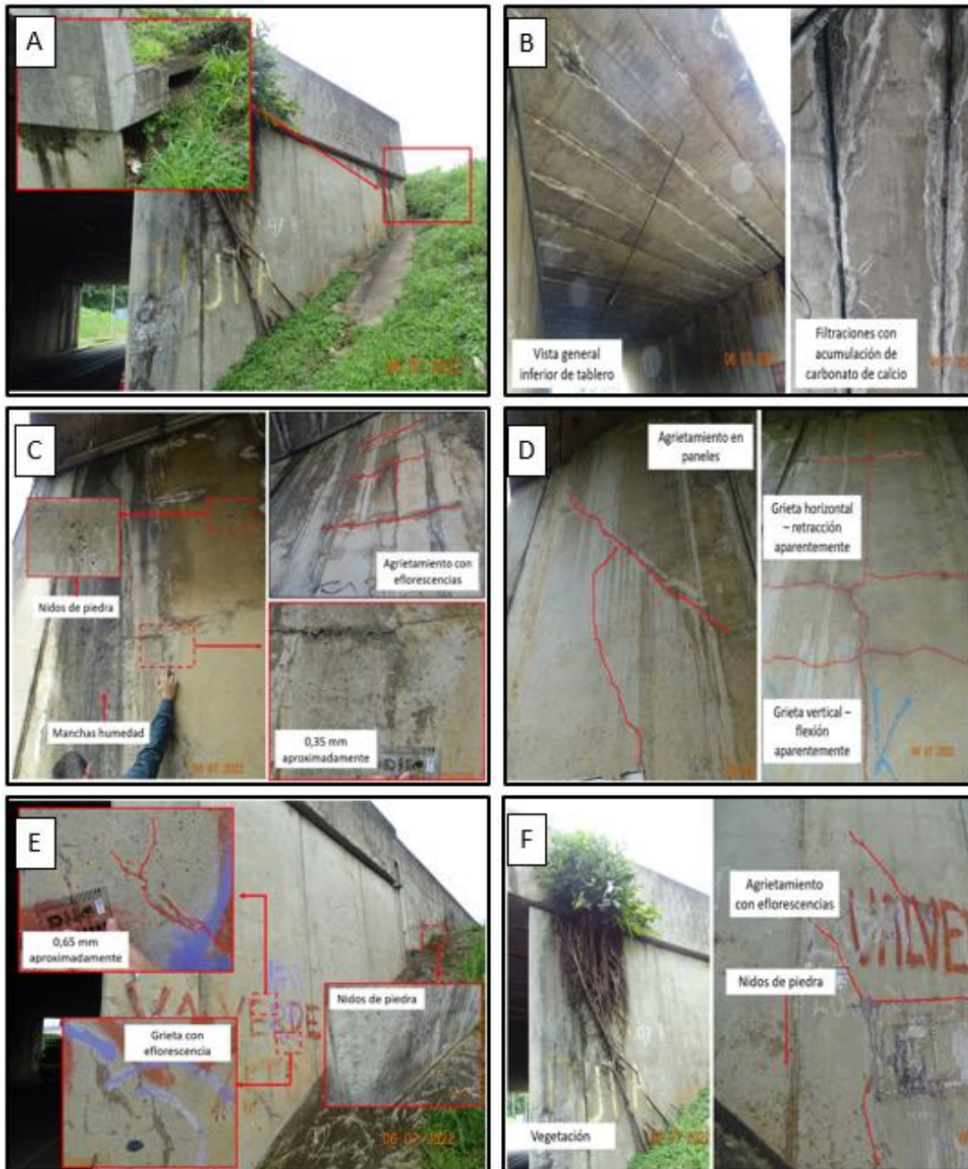
Figura 5.37. (A) Deficiencias en sistema de drenaje de los accesos, (B y C) Deficiencias en elementos principales de la superestructura, (D y E) Deficiencias en cuerpo de bastiones, y (f) Deficiencias en aletones
