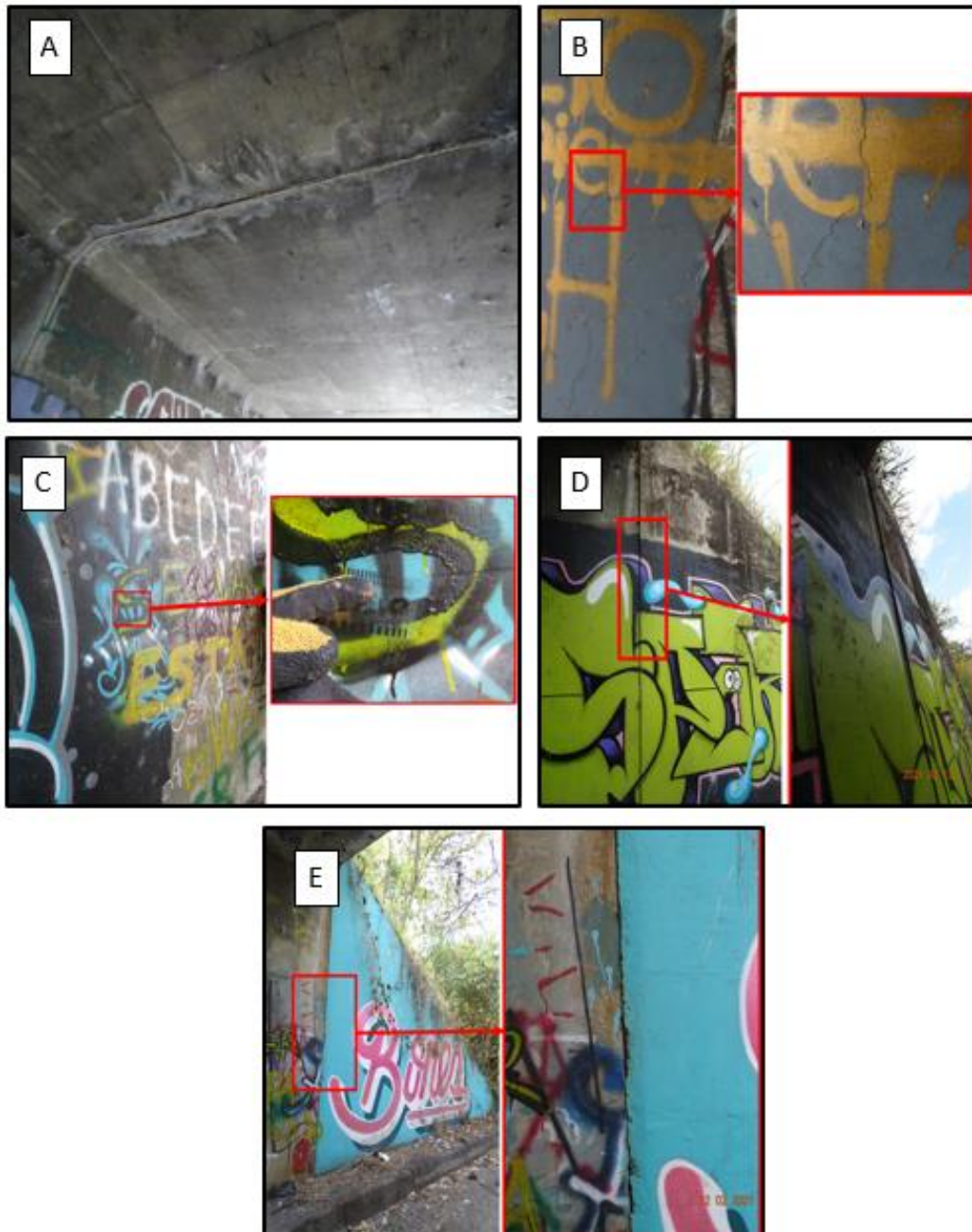
Figura 5.16. (A) Deficiencias en elementos principales de superestructura tipo losa, (B y C) Deficiencias en cuerpo de bastiones, y (D y E) Deficiencias en aletones
