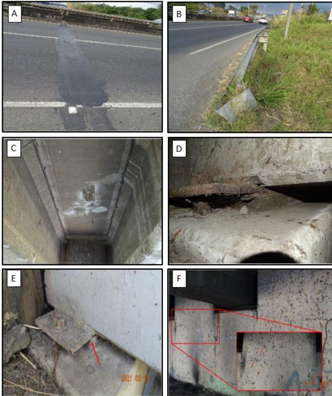
Figura 5.20. (A) Deficiencias en junta de expansión, (B) Deficiencias en sistema de contención vehicular de los accesos, (C) Deficiencias en tablero de la superestructura, (D y E) Deficiencias en apoyos y (F) Deficiencias en sistema de protección sísmica
