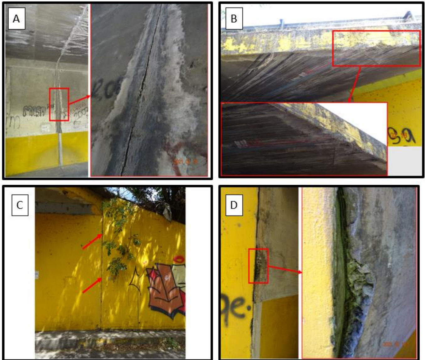
Figura 5.18. (A y B) Deficiencias en elementos principales de la superestructura, (C) Deficiencias en cuerpo de bastiones, y (D) Deficiencias en aletones
