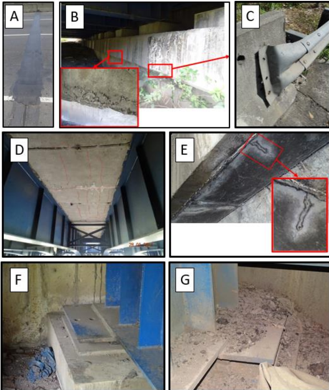
Figura 5.1. (A y B) Deficiencias en juntas de expansión, (C) Deficiencias en sistema de contención vehicular de los accesos, (D) Deficiencias en tablero, (E) Deficiencias en cabezal de bastiones, y (F y G) Deficiencias en apoyos
