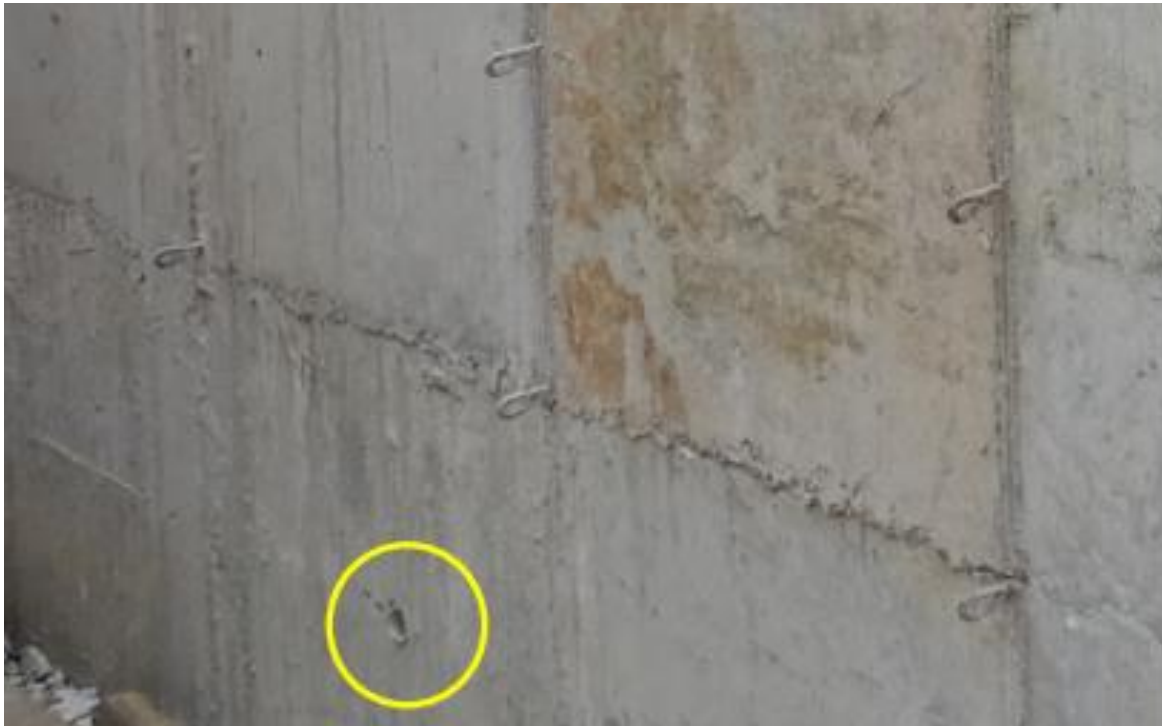
Figura 18. Colocación de tubo de PVC para poder recuperar varillas en el puente sobre quebrada Sube y Baja. Fecha 17 de agosto de 2022
