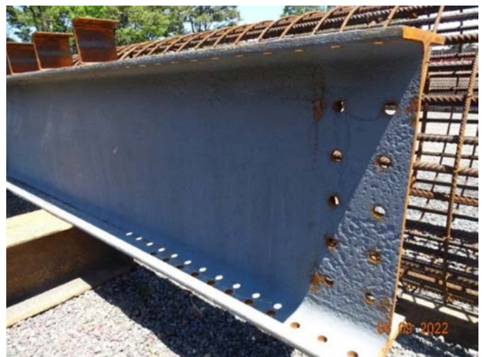
Corrosión por picadura en vigas del proyecto que requirió tratamiento adicional
