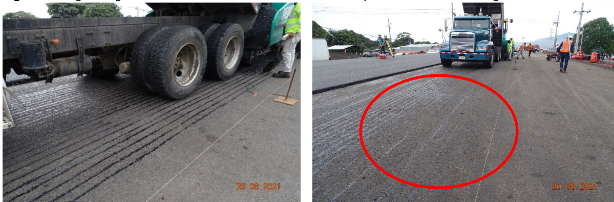
Figura 8. Riego de liga no uniforme con escasa cobertura de la superficie. Fecha: 20 de agosto de 2021.
