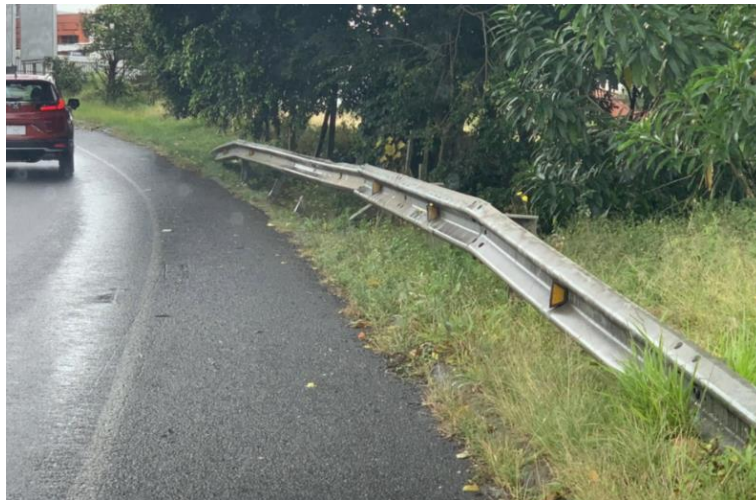
Figura 3. Sistema de contención vial impactado sobre el talud de entrada de la alcantarilla sobre la Quebrada Ocloro.
