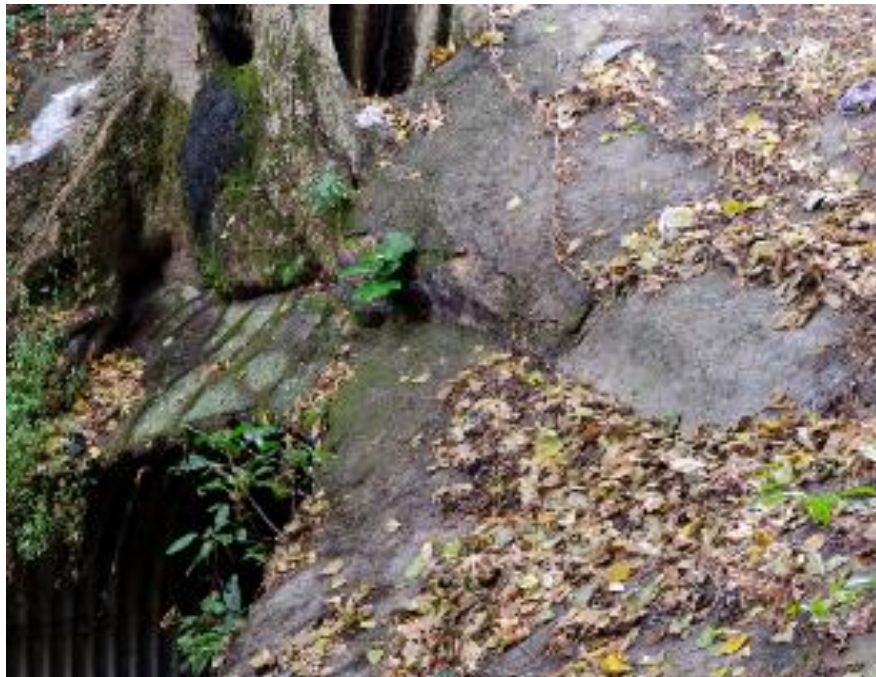
Figura 1. Grietas en los elementos de concreto producto del crecimiento del árbol en el relleno sobre la tubería de la alcantarilla.
