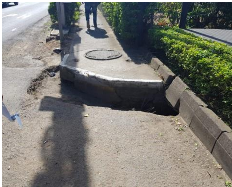
Figura 7. Punto de ingreso del agua que se desborda del Río María Aguilar hacia la alcantarilla de la quebrada Zopilote.
