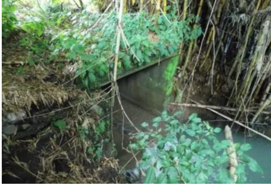
Figura 6. Condición registrada en el 2013 de la salida de la Alcantarilla 002-01, la cual da paso al Río Ocloro por debajo de la Ruta Nacional No.2.
