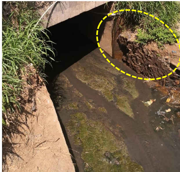
Figura 8. Talud en el cauce a la entrada de la alcantarilla vulnerable a la erosión.
