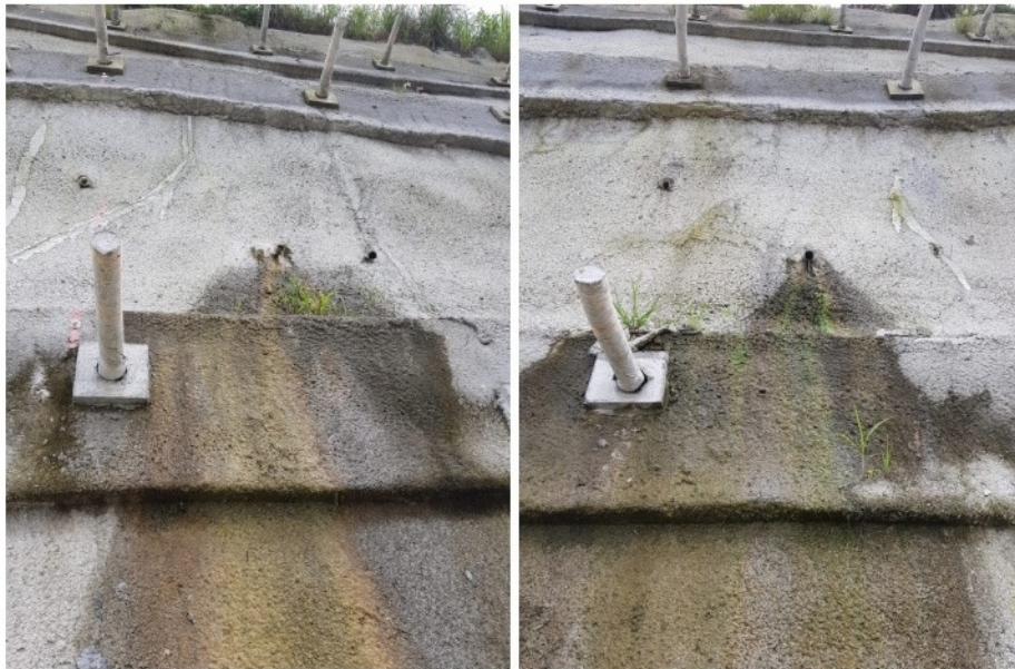
Figura 77. Grieta al pie del muro anclado construido en el estacionamiento 44+500..
