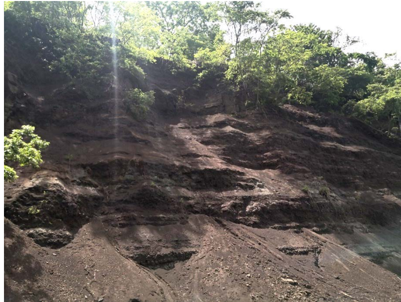
Figura 86. PK 73 +000. Acumulación de materiales finos al pie del talud.
