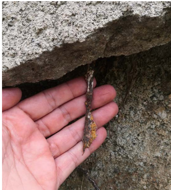
Figura 80. PK 47+000 Deterioro en el acero que está en contacto con el medio ácido del talud
