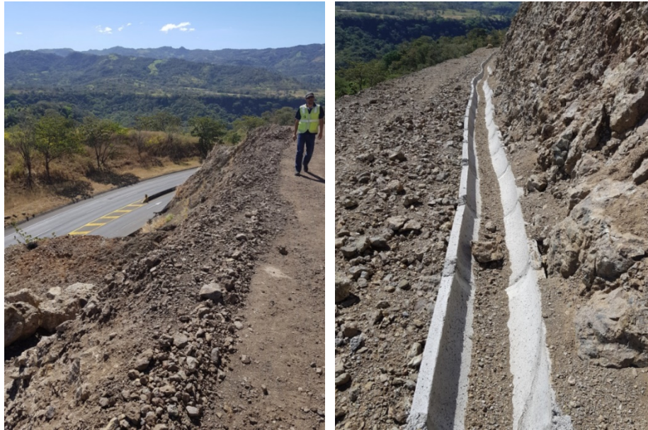
Figura 59. Condición actual del talud al costado derecho del kilómetro 37+500.
