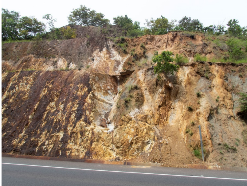
Figura 84. Condición actual del talud al costado derecho del estacionamiento 47+000, sentido Caldera – San José.
