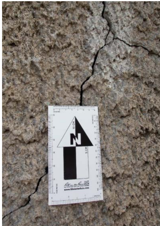
Figura 83. Grietas observadas en el concreto lanzado del talud en el estacionamiento 47+000
