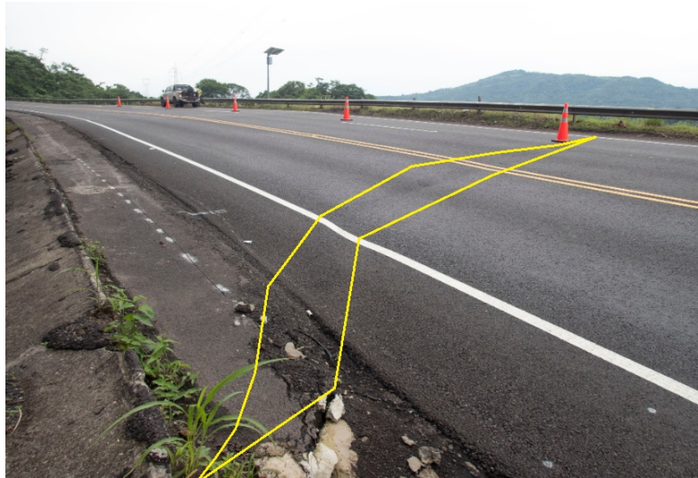
Figura 74. Dentro del polígono de color amarillos se muestra el hundimiento principal en la ruta, se localiza en carril con sentido San José – Caldera.
