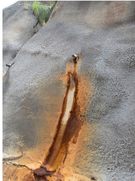
Figura 81. PK 47+000 Manchas amarillentas características de depósitos generados en medios ácidos, lo que genera deterioro acelerado del concreto
