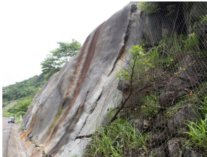
Figura 78. PK 47+000 Algunos deterioros observados en el concreto lanzado
