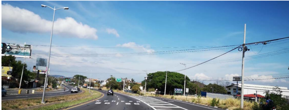
Figura 93. Luminarias en mediana y vía de velocidad reglamentaria de 80 km/h
