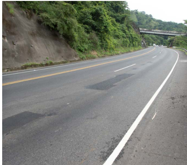
Figura 75. Baches de asfalto colocados para nivelar los hundimientos en el carril externo en el sentido Caldera- San José.
