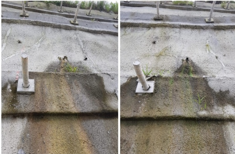
Figura 76. Fotografías donde se observa agua saliendo de los drenajes en el frente del muro anclado.
