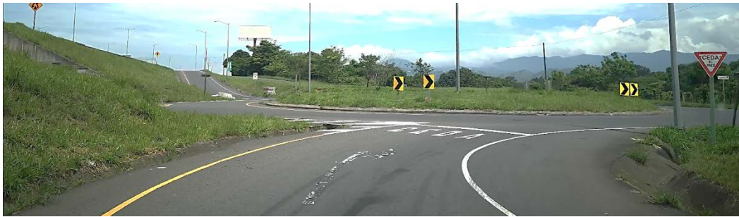
Figura 111. Demarcación horizontal borrosa
