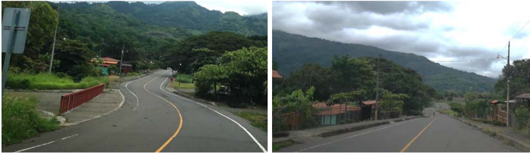
Figura 115. Demarcación horizontal borrosa y ausencia de captaluces
