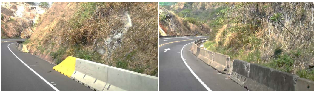
Figura 104. Barreras de concreto aisladas, deterioradas y con discontinuidades
