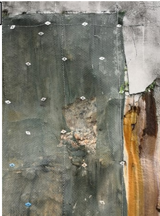
Figura 61, Talud intervenido, PK 38+600. A) Geosintético con refuerzo de malla metálica. B) Deterioro en el manto para control de erosión y en el concreto adyacente.
