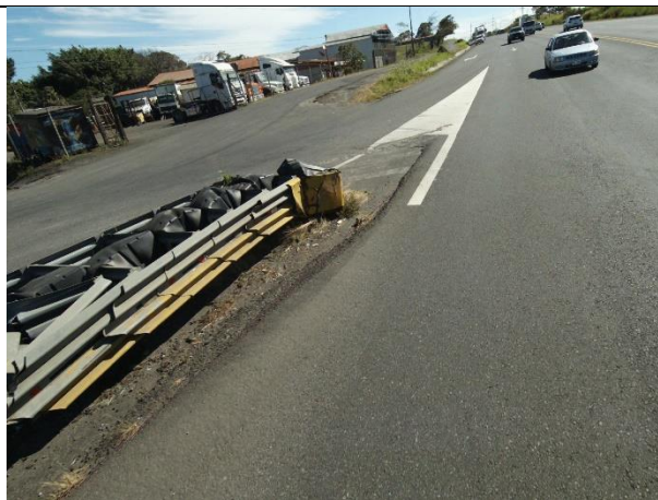
Atenuador de impactos dañado estacionamiento 19+940
