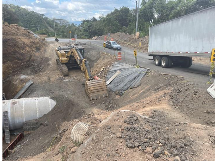
Figura 7. Obras en construcción en el Punto 3, Ruta Nacional 1. Se observa un tramo de la tubería de concreto que fue colocada como parte de las obras en este sitio, así como una parte del relleno al costado y sobre la tubería
