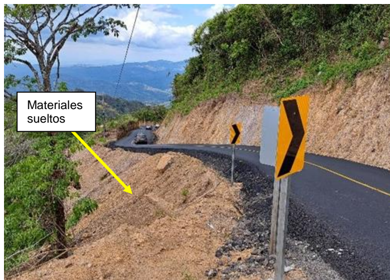
Figura 20. Punto RA-3. Localizado a 535 m desde el cruce en Piedra Blanca con la Ruta Nacional No.1. Se observa material de corte suelto, colocado al costado de la vía en las laderas de la montaña. No se observan obras de protección superficial, ni drenajes que permitan captar y conducir el agua de lluvia, de forma tal que no se dañen los taludes por la erosión. A) Vista en el sentido Piedra Blanca – Río Jesús. B) Vista en el sentido contrario de circulación vehicular
