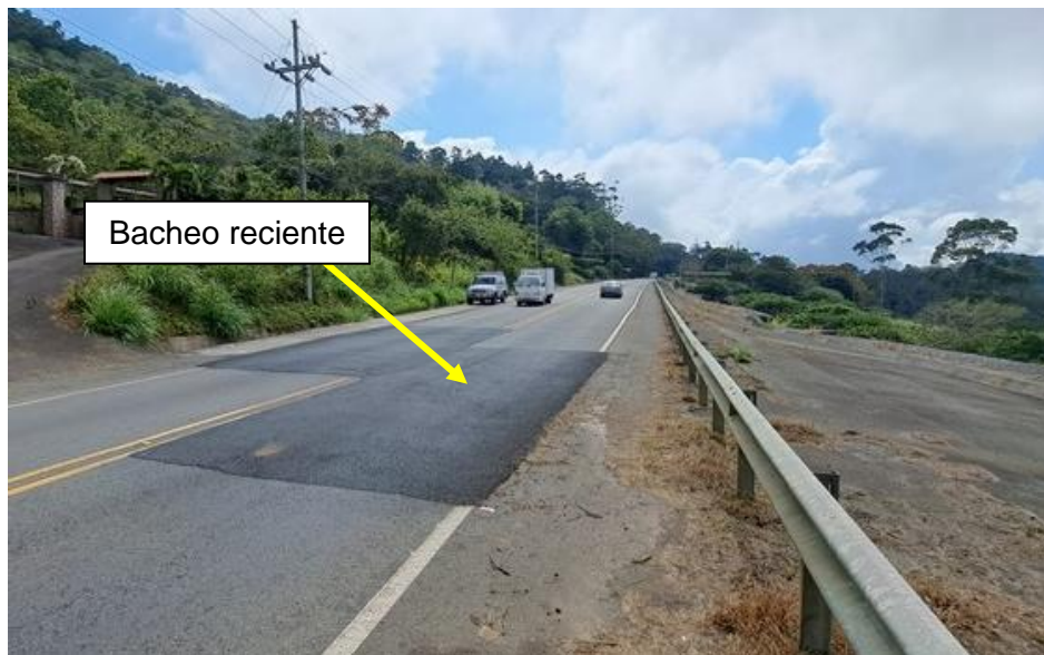
Figura 16. Vista del bacheo sobre la calzada en la zona del Punto 5, en la Ruta Nacional No.1
