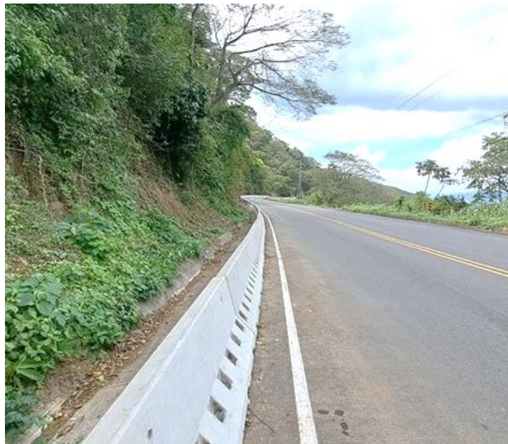
Figura 18. Barreras de contención vehicular de concreto, colocadas al costado de la vía al pie del talud que presentó el deslizamiento el día 17 de setiembre del año 2022. La contención de los materiales caídos y la seguridad que ofrecen a los usuarios es limitada
