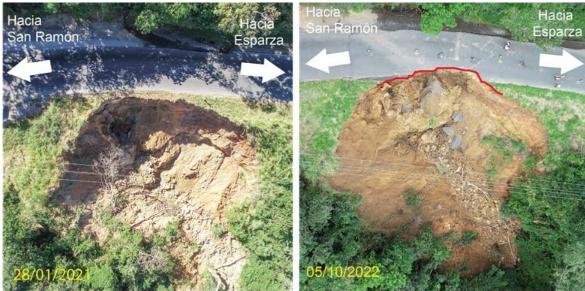
Figura 10. Comparación de la condición del Punto 4 en la Ruta Nacional No.1 entre el 2021 y el 2022. Se aprecia el avance de la corona del deslizamiento y su afectación sobre la calzada. La línea de color rojo muestra la zona de la corona que ha afectado directamente el pavimento de la carretera. Fuente: EIC-Lanamme-INF-1587-2022
