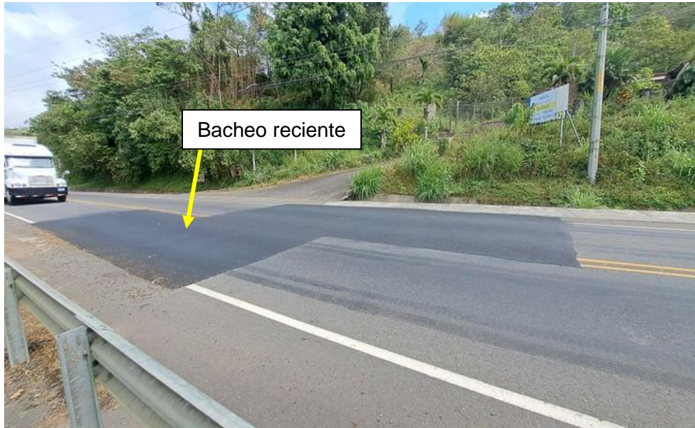
Figura 15. Punto 5. Ruta Nacional No.1. Bacheo identificado en la zona en la cual se observaron grietas y asentamientos en la evaluación del año anterior 2022
