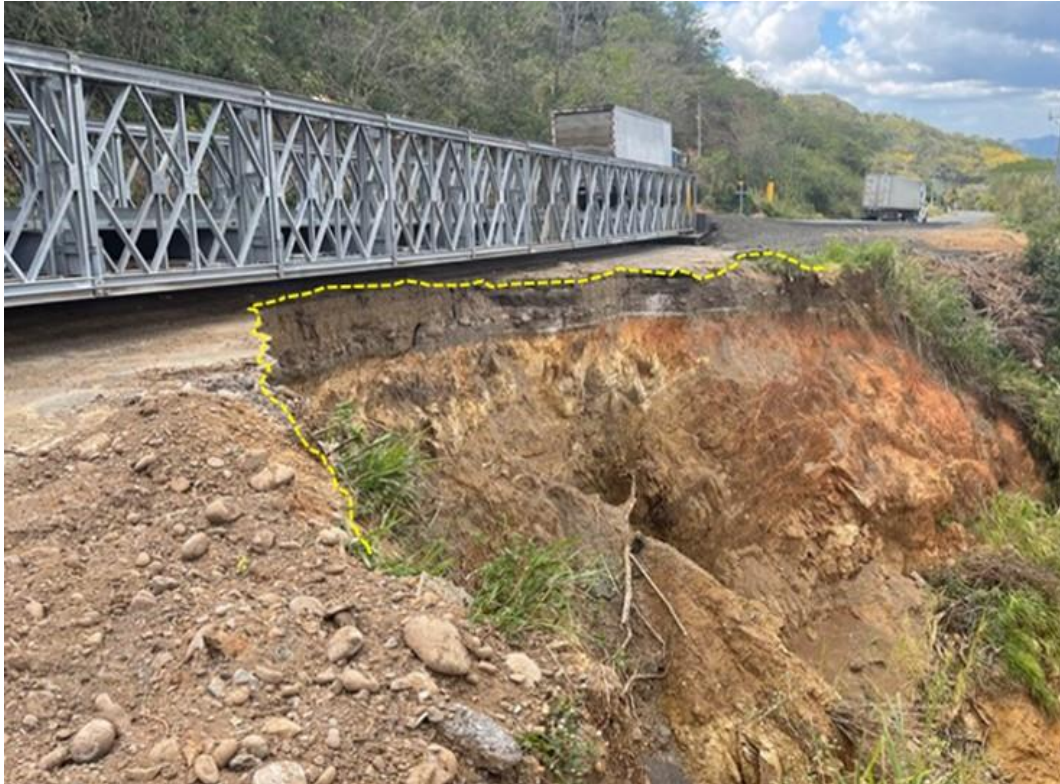
Figura 12. Vista de costado del puente Bailey instalado en el Punto 4 de la Ruta Nacional No.1. La línea amarilla muestra el borde actual del deslizamiento
