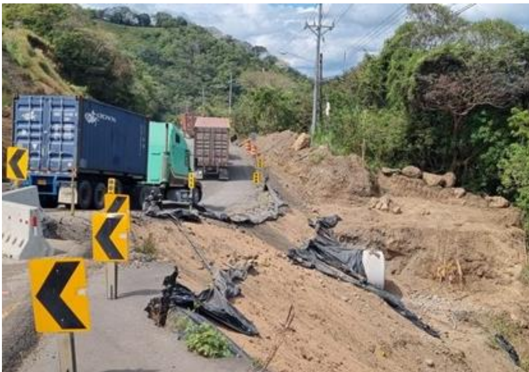
Figura 9. Obras en construcción en el Punto 3, Ruta Nacional 1, sector aguas abajo de la alcantarilla. Se observa una parte del relleno construido para el paso temporal del tránsito vehicular.
