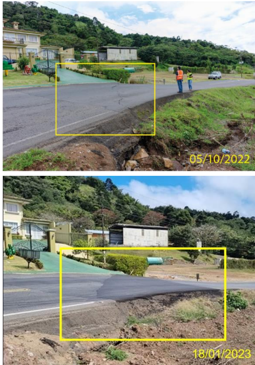
Figura 3. Sector oeste de la corona del deslizamiento en la carretera. Se observan diferencias en la superficie del pavimento entre octubre del 2022 y enero del 2023, evidencia de intervenciones meses recientes. En el recuadro de color amarillo se muestra la zona de la calzada más afectada por el deslizamiento en este sector
