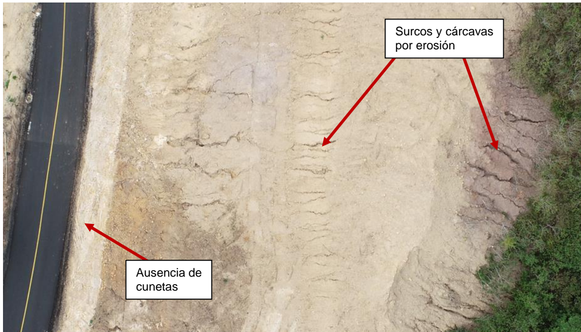
Figura 23. Ausencia de cunetas y evidencia de surcos y cárcavas en taludes de la Ruta alterna.
