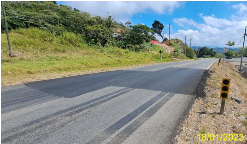
Figura 4. Corona del deslizamiento en el sector este del pavimento. En esta comparación entre el 2022 y el 2023 se muestra la intervención realizada con el fin de allanar el desnivel provocado por el deslizamiento en este sector. Las fotografías fueron tomadas en sentidos opuestos de circulación vehicular
