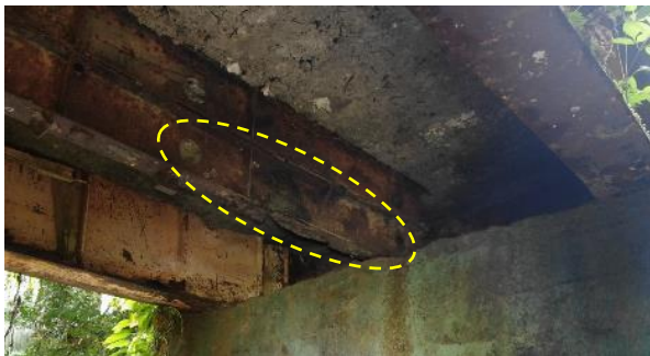
Corrosión en superestructura
