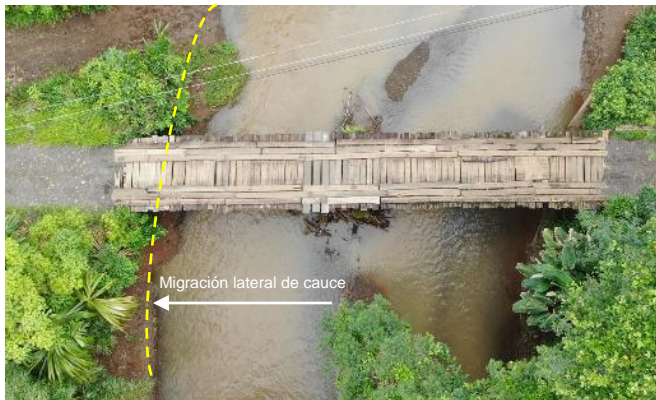
Socavación en bastiones
