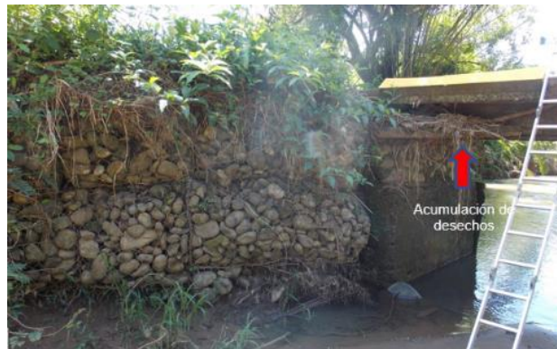
Deterioros en el bastión de margen izquierda
