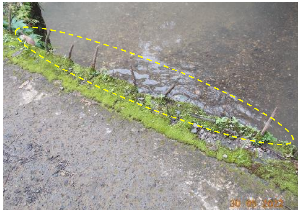
Ausencia de barandas y elementos básicos de seguridad vial
