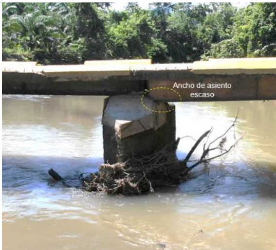
Socavación local en la pila central y ancho de asiento limitado
