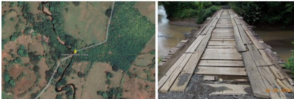
Figura 2: Ubicación del puente Salvador Araya y vista general. Fuente: Google Earth y LanammeUCR
