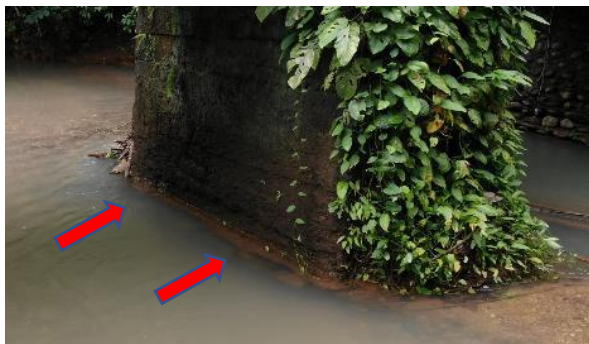
Socavación de pila central
