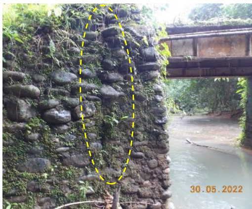
Separación entre aletón y cuerpo de bastión margen izquierda
