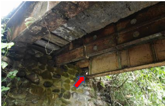
Reducción de sección en apoyo de vigas principales
