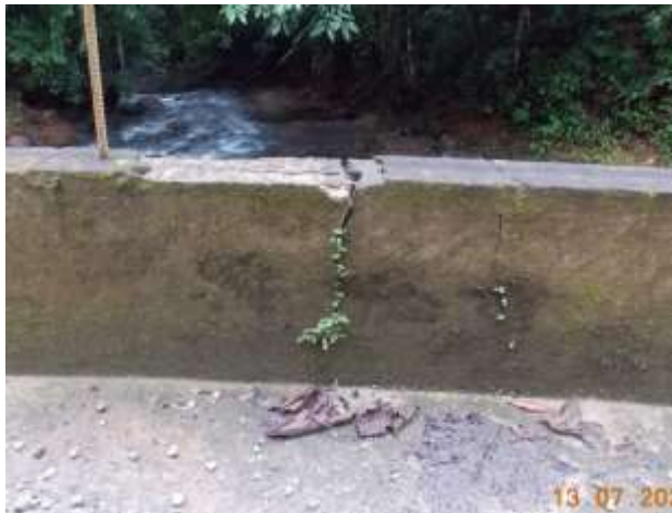
Deformación y agrietamientos en barandas
