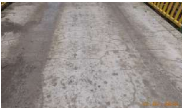
Deformación en la alcantarilla y agrietamientos en losa
