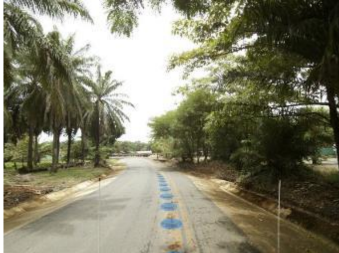
Figura 2. Ejemplo de cuneta en condición buena
