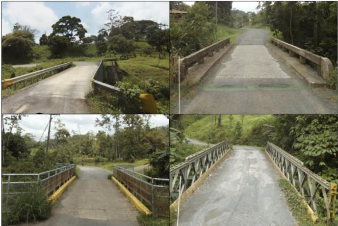
Figura 9. Ejemplo de sistema de contención vehicular inadecuado, en mal estado, con elementos faltantes o terminal cola de pez (Nota = 33)
