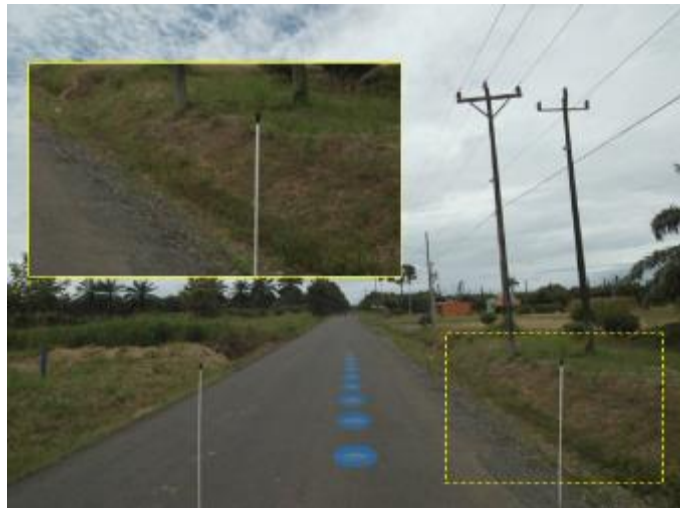
Figura 3. Ejemplo de cuneta en condición regular
