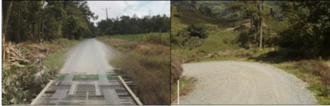
Figura 10. Ausencia de sistema de contención vehicular (Nota = 0)
