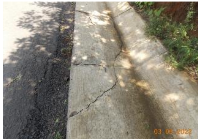
Cunetas con agrietamientos
