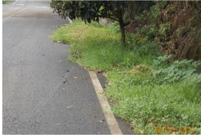
Maleza invade parte de la calzada, se requiere mantenimiento.
