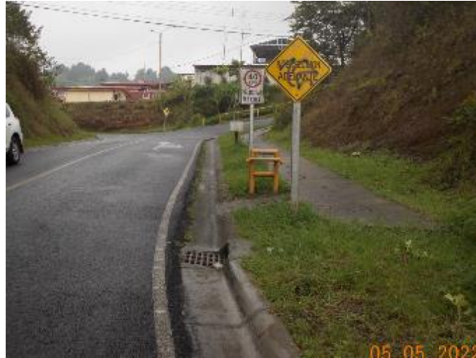
Señales verticales requieren limpieza
