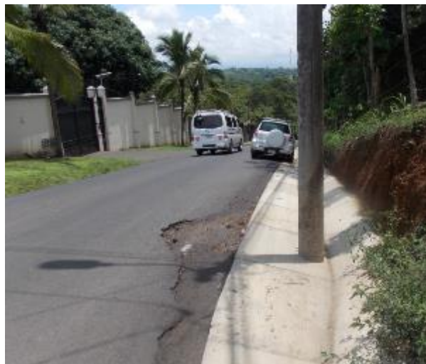
Desprendimiento lateral de agregados
