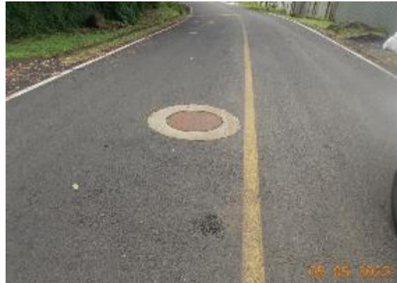
Tapas de alcantarillado a nivel de rasante
