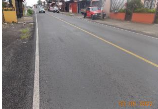
Demarcación horizontal con desgaste leve.
