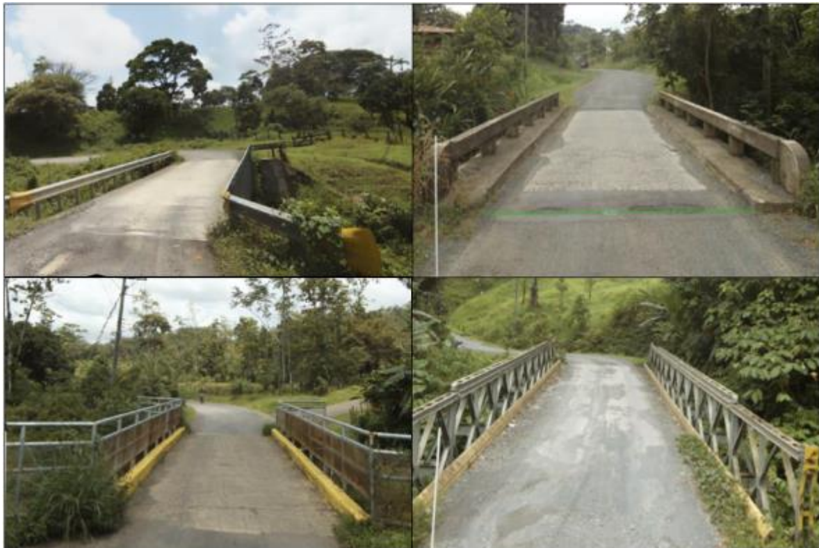
Figura 10. Ejemplo de sistema de contención vehicular inadecuado, en mal estado, con elementos faltantes o terminal cola de pez (Nota = 33)
