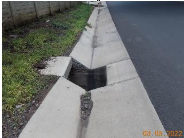
Presencia de tragantes y obras de arte sin tapas
