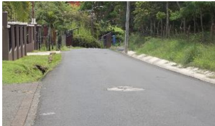
No se identificaron aceras en esta vía.
