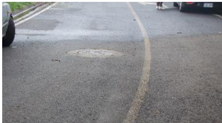
Tapas de alcantarilla a nivel con la rasante.
