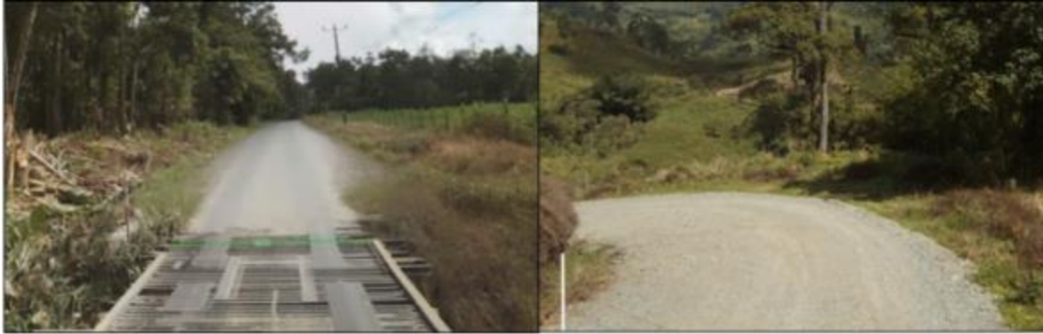
Figura 11. Ausencia de sistema de contención vehicular (Nota = 0)
