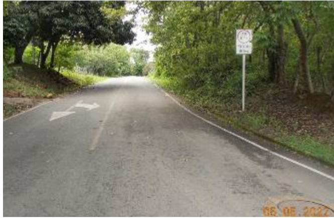
Demarcación horizontal y vertical completa con desgaste leve.
