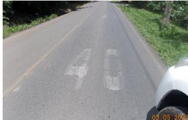
Demarcación horizontal con desgaste y poca visibilidad
