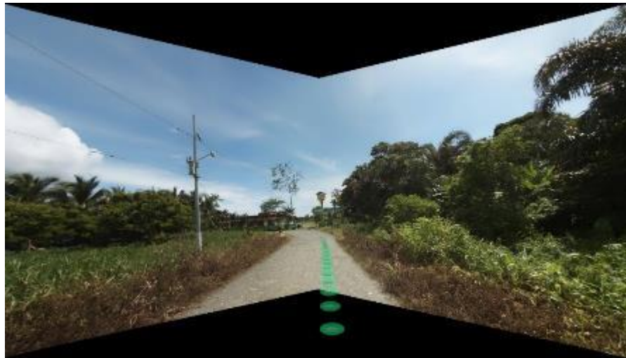
Figura 5. Ejemplo de cuneta en condición mala
