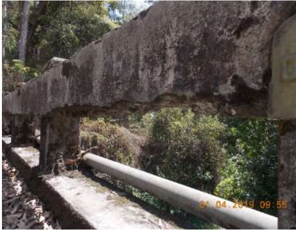
Barandas con deterioros y acero expuesto.
