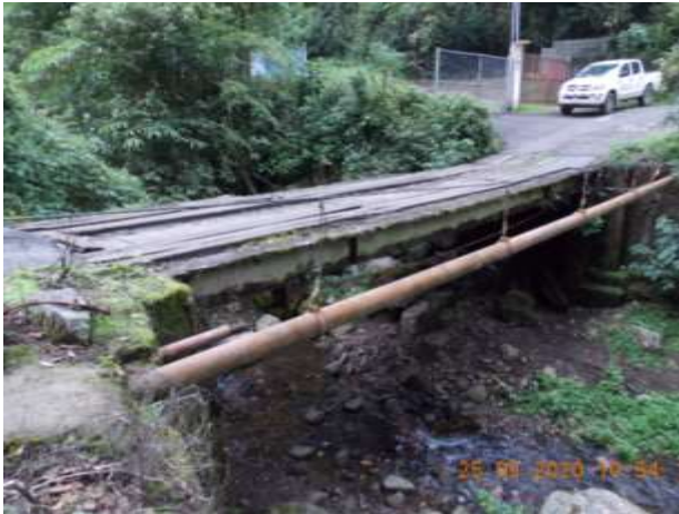
El puente no tiene barandas, lo cual es una condición de riesgo.
