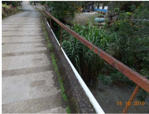
Las barandas son inadecuadas para resistir un impacto de forma segura.
