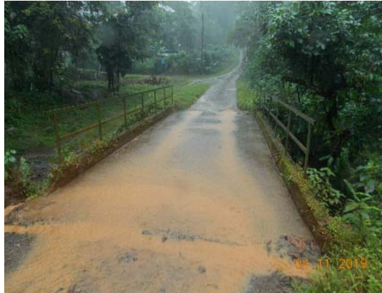
Drenajes superficiales insuficientes.
