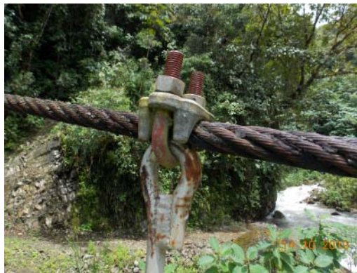
El puente requiere medidas de mantenimiento preventivo.
